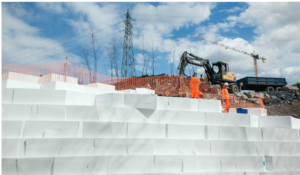
Figur 40. Rundt 28.000 EPS-blokker under den nye påkjøringsrampen vea Løxa i Bærum. Bilde: Mari Gisvold Garathun Teknisk ukeblad 2016
