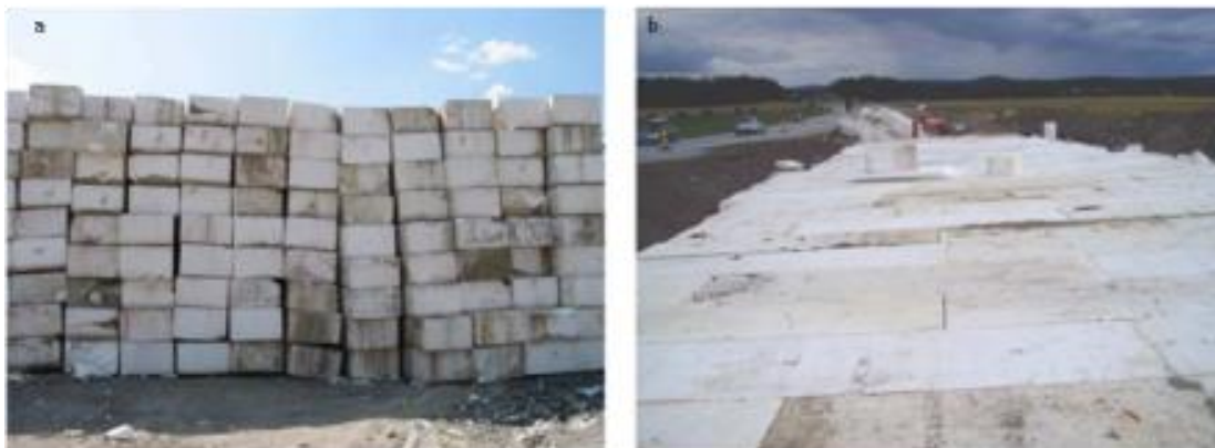
Figur 31. Blokker fra midlertidig EPS fylling på E6 Løkkeberg flyttet til ny utbygging av E6. Foto: Statens vegvesen
