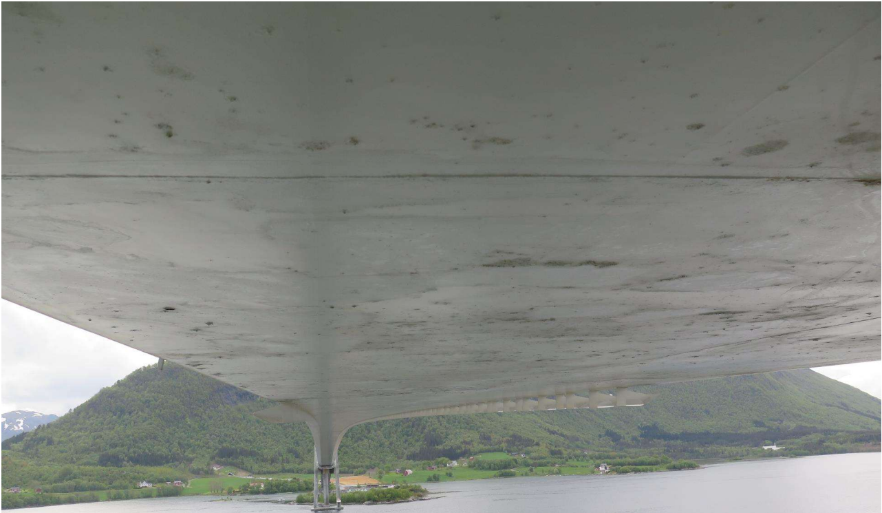
Figur 10. Mange beleggs-kader over store arealer. Sinkbelegget korroderer, men stålet er foreløpig beskyttet og korroderer ikke.
