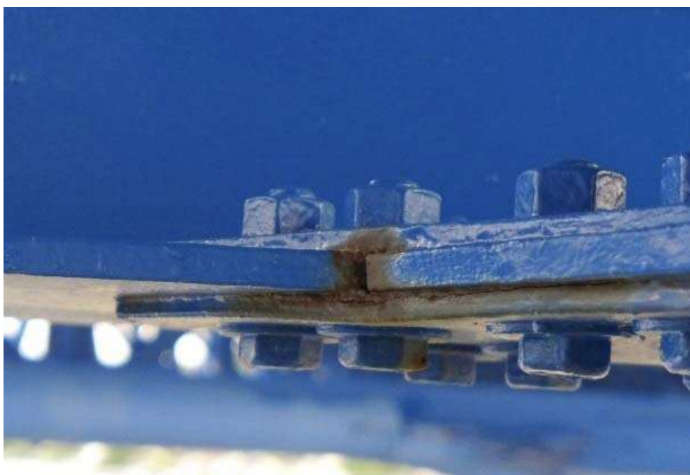
Figur 8. Lokal korrosjonsskade i overlappende skjøt
