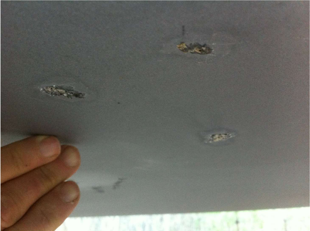
Figur 11. Små lokale skader i belegget der sinken korroderer. Stålet er foreløpig beskyttet.
