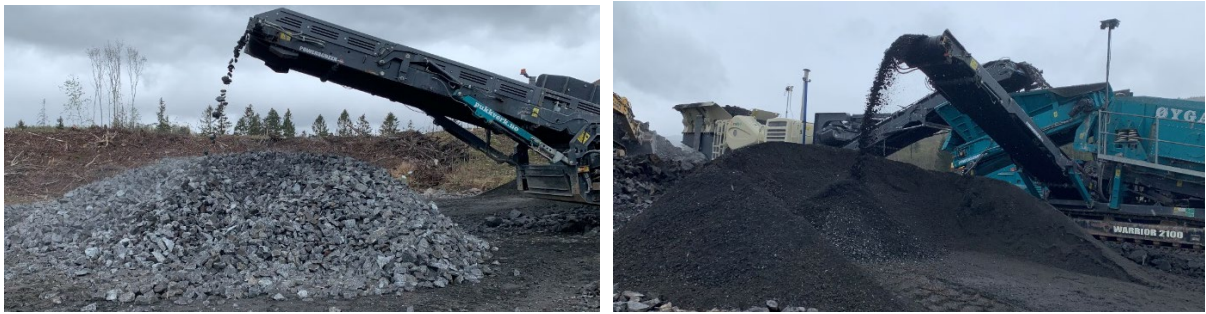
FIGUR 17. DET BLE GJENNOMFØRT OPPREDNING AV MASSETIPP 3 VED BRUK AV KNUSE OG SIKTEVERK. BILDE TIL VENSTRE VISER UTTAK AV FRAKSJONEN 22-50MM. DISSE MASSENE BLE SAMMEN MED FRAKSJONEN 50-120MM LAGT UT OG GJENBRUKT. BILDET TIL HØYRE VISER UTTAK AV SVARTSKIFERHOLDIG 0-22MM SOM BLE KJØRT TIL GODKJENT DEPONI. FOTO: CECILIE HALLINGSTAD
