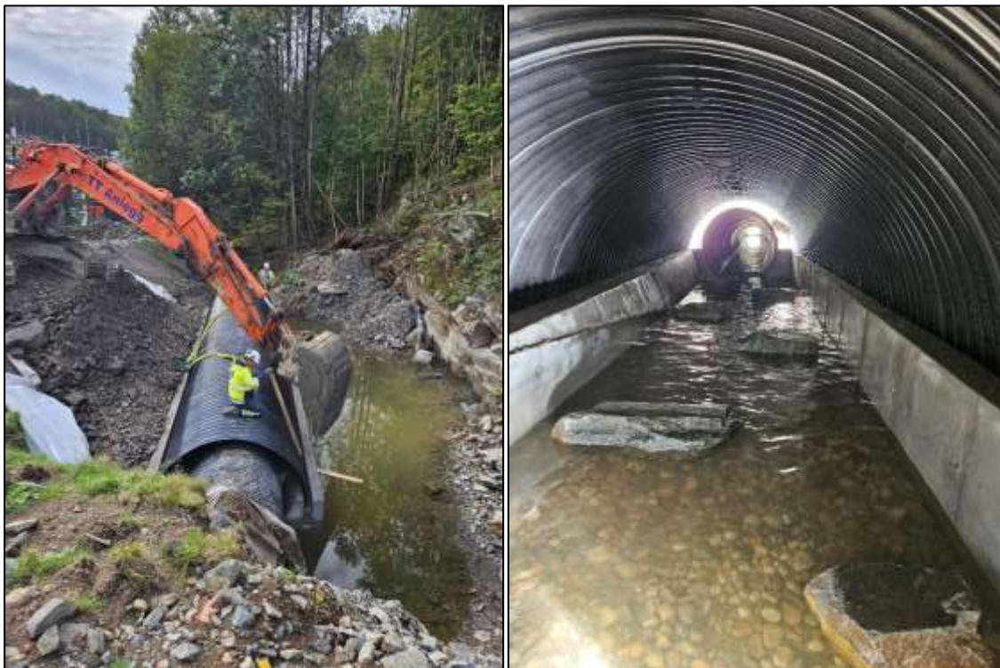
Figur 41. Buen til hvelvkulverten heises på plass og monteres oppå fundamentene. Naturlig bunn- og gytesubstrat kombinert med større steiner ble etablert inni hvelvløsningen (Foto: Statens vegvesen).
