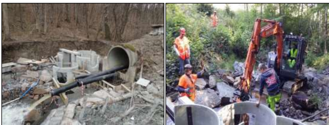
Figur 68. Bilder fra byggefasen hvor elementene ble plassert og tilpasset (Foto: Paul Ridola).
