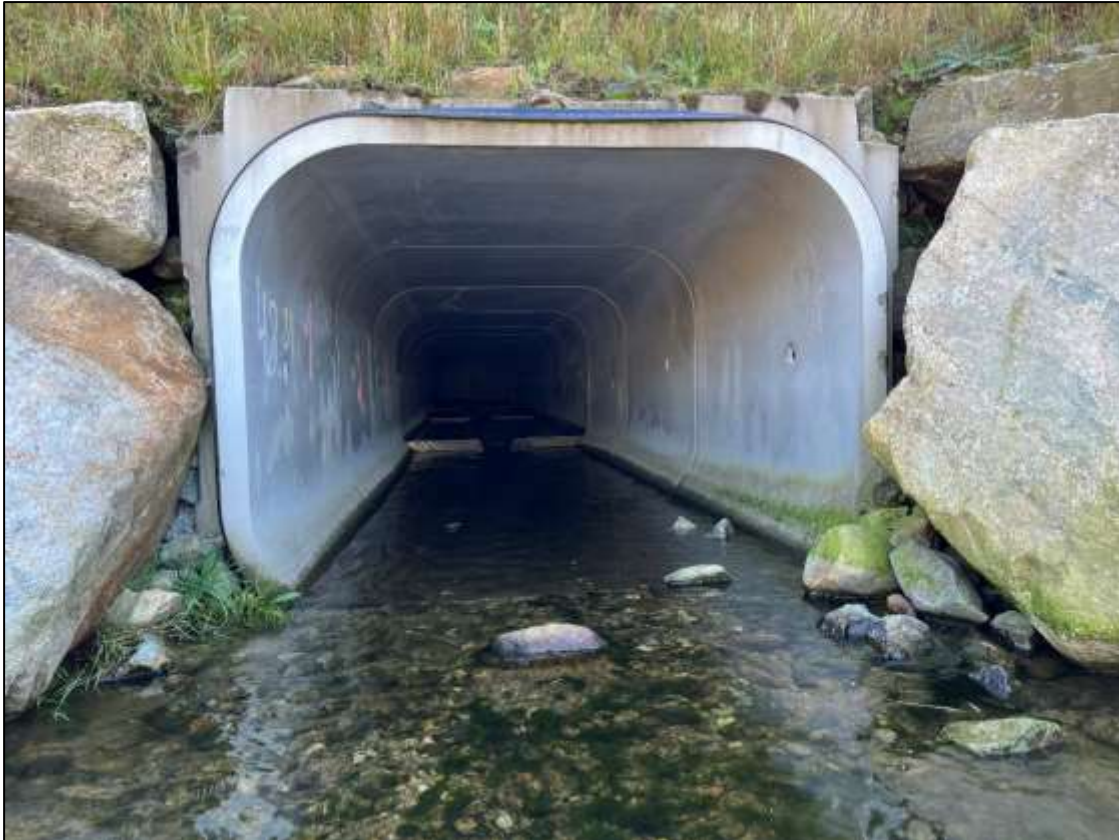
Figur 44. Bokskulvert i Høylandsåna (Sjøørretprosjektet i Rogaland, foto: Øyvind Haugland).
