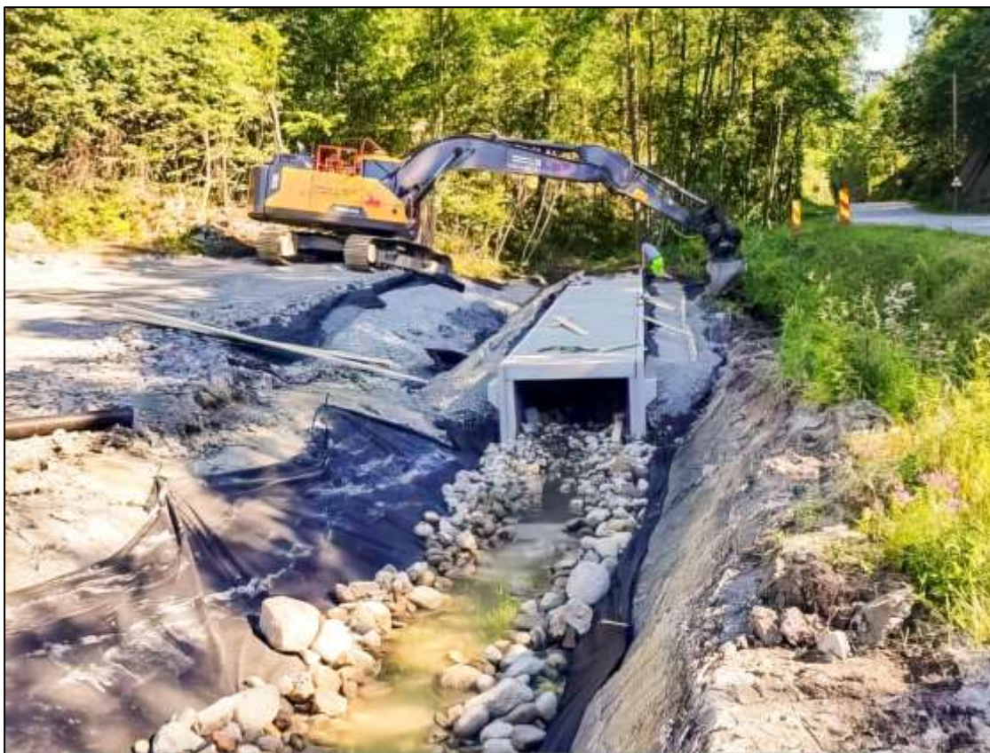
Figur 46. Firkantkulvert med lokk. Kulverten har løst lokk slik at den «U» formede underdelen kan etableres i bekken før stein og grus (bunnsstratet) plasseres inni. Når alt er etablert inni, så kan lokket løftes på plass. Løsningen sikrer gode vandringsforhold og kulverten er tilstrekkelig hydraulisk kapasitet for å kunne håndtere flom (Foto: Bengt Øyvin Daatland).
