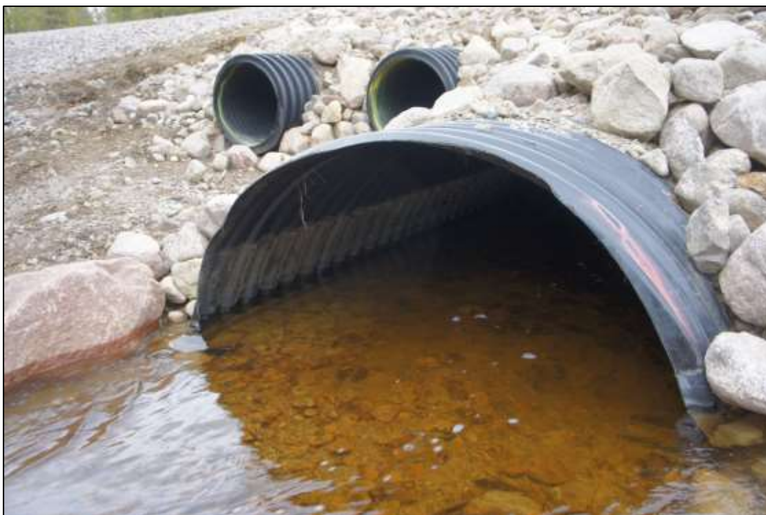
Figur 37. Hvelvkulvert kombinert med to overløp/flomrør (Foto Henrik Lissmann/Emma Persson).
