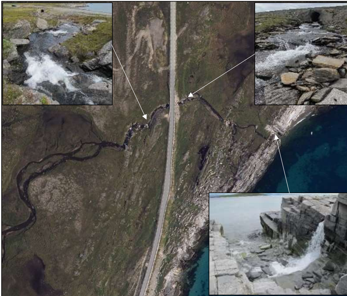
Figur 24. Flyfoto som viser til eksempel på naturlig vandringshinder nedstrøms kulverten ved utløpet i sjøen. Bildeutsnitt nede til høyre viser fossefall ved utløpet til sjøen (totalt vandringshinder). Bildeutsnittene oppe til venstre og høyre viser elveløpet henholdsvis oppstrøms og nedstrøms kulverten. De sistnevnte blir ikke vurdert som vandringshinder for fisk. Det vurderes som lite hensiktsmessig å utbedre vandringshinderet ved kulverten grunnet det totale vandringshinderet for oppvandrende anadrom fisk ved utløpet til sjøen (Illustrasjon: Øyvind Haugland).
