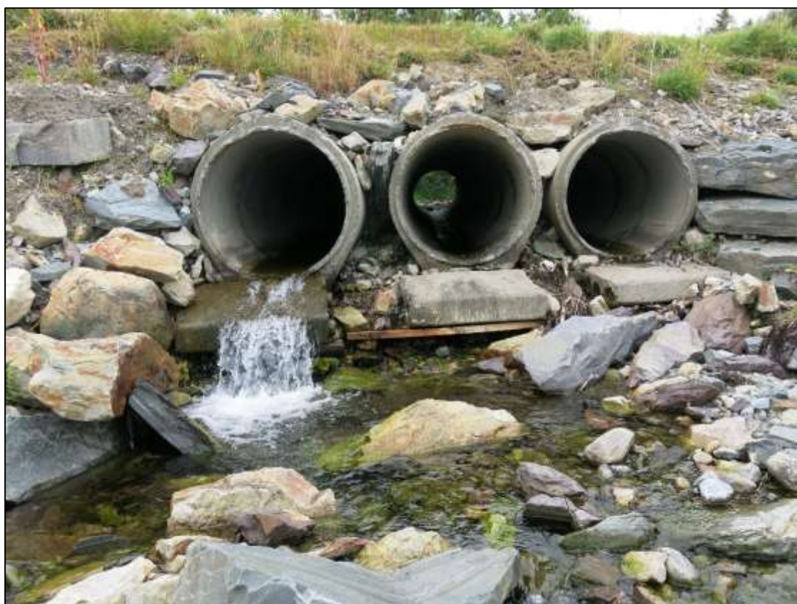
Figur 17. Flere sirkulære betongrør med høyt fall ved utløpet og mye stein og blokker som hindrer for fiskevandring (Foto: Øyvind Haugland).
