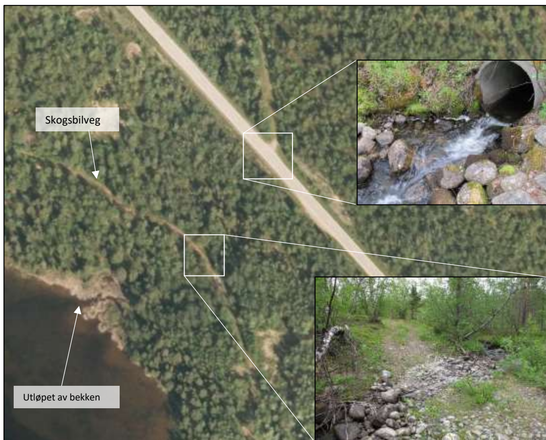
Figur 25. Flyfoto over europaveg og en skogsbilveg. Det innfelte bildet nede til høyre viser kulverten under skogsbilvegen mens bildet øpe til høyre viser kulverten under europavegen. Stein sperrer kulverten både ved inn – og utløpet av kulverten under skogsbilvegen. Potensialet i bekken må inngå i totalvurderingen og ved å åpne kulvert under europavegen vil dette potensialet bli større (Illustrasjon: Øyvind Haugland).
