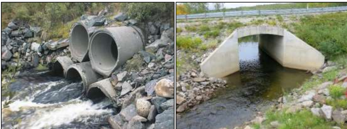
Figur 33. Flere sirkulære betongkulverter ble erstattet med plaststøpt betongkulvert (bru i fylling). Dette resulterte i gode vandringsforhold både for fisk, elvebåter og kano (Foto Knut Aune Hoseth (NVE) og Øyvind Haugland).
