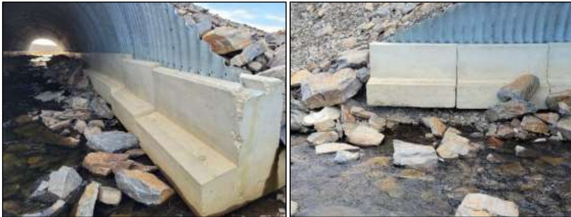
Figur 39. Det er viktig at det gjøres grundig prosjekteringsarbeid for å unngå at det skjer undergraving av fundamentene. Dette kan føre til skade på konstruksjonen og medføre en fare for vegen og vegkroppen (Foto: Lemet Heaika Klemetsen Hætta).
