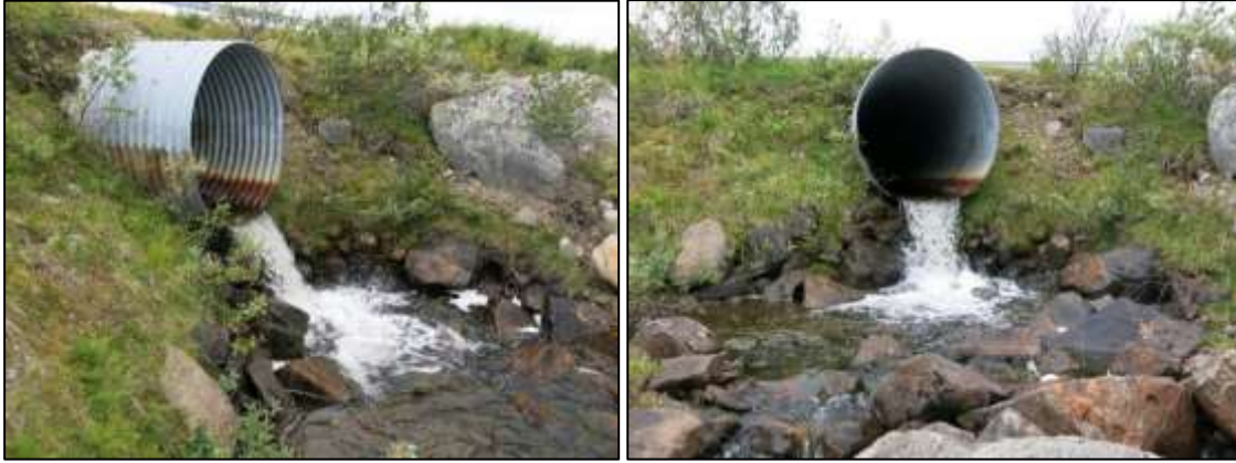
Figur 18. Eldre svalbardrør (stålrør) med høyt sprang ved utløpet kombinert med mangelfull kulp gjør fiskevandring tilnærmet umulig. Slike rør kan også være problematisk for ålevandring (Foto: Øyvind Haugland).
