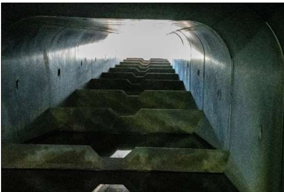
Figur 47. Fisketerskler av betong i firkantkulvert (Foto: Frode Kroglund, statsforvalteren i Agder).
