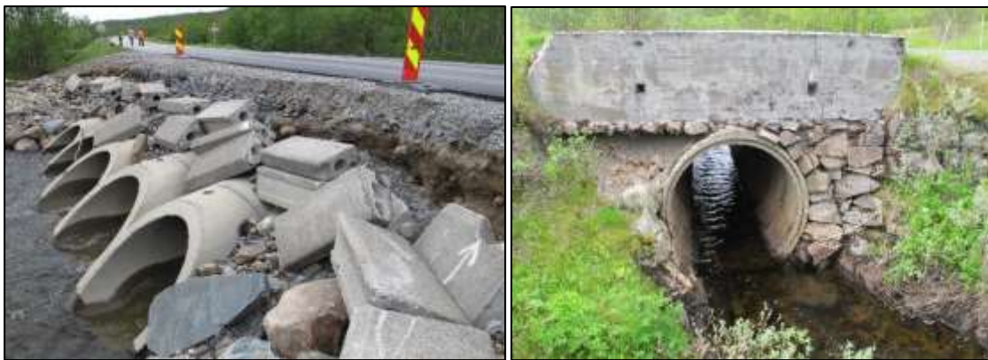
Figur 58. Dårlig erosjonssikring kan føre til store skader på vegkroppen, kantsonen og innløpet til kulverter (Foto: Øyvind Haugland).
