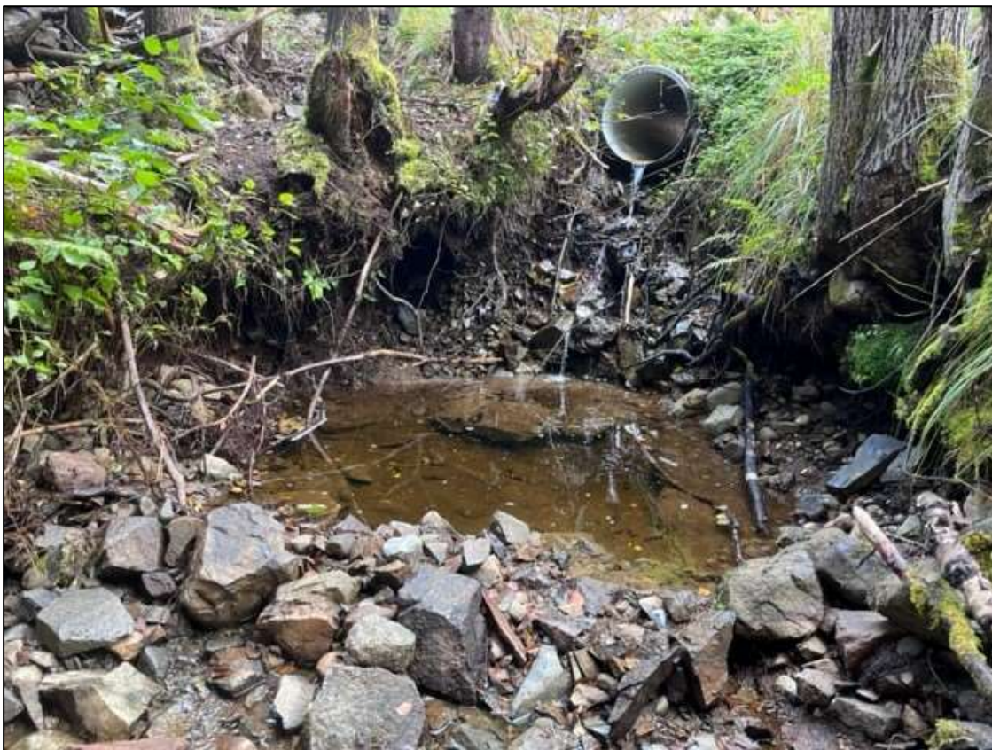
Figur 59. Stikkrenne under en veg. En større regnflom har vasket bort mye av massene under stikkrenna. Vannspranget har økt ved at vannet har gravd seg ned og kantene erodert bort. Bare vegetasjonen har hindret at mer av massene har forsvunnet. I dette tilfellet er det usikkert om bekken har årssikker vannføring. I tillegg er det registrert et naturlig vandringshinder rett oppstrøms stikkrenna, så konsekvensene av at en sperrer for fiskens frie gang her, er minimale. Men feil utforming gir her erosjonsskader som kunne vært forhindret (Foto: Frank Jørgensen).
