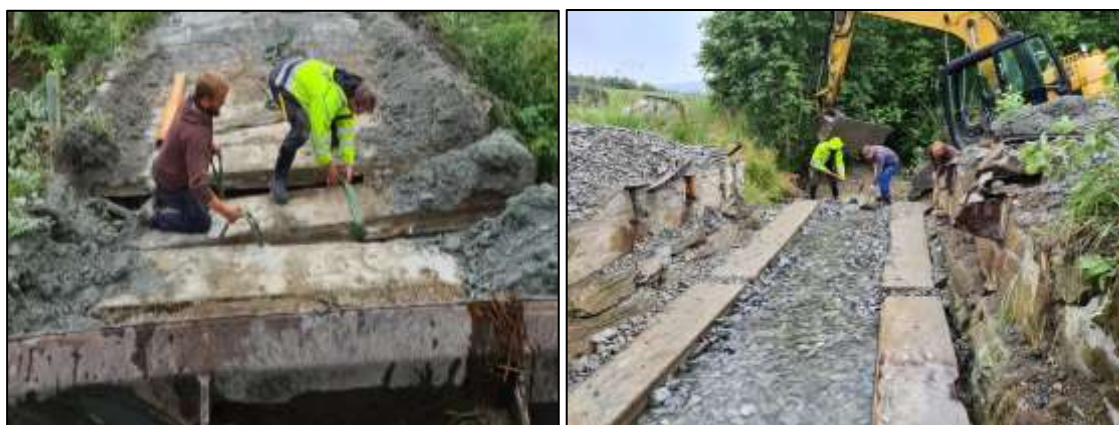
Figur 42. De gamle bruelementene ble brukt som fundament (Foto: Sigbjørn Hammer, Hammer Skogtjenester AS).
