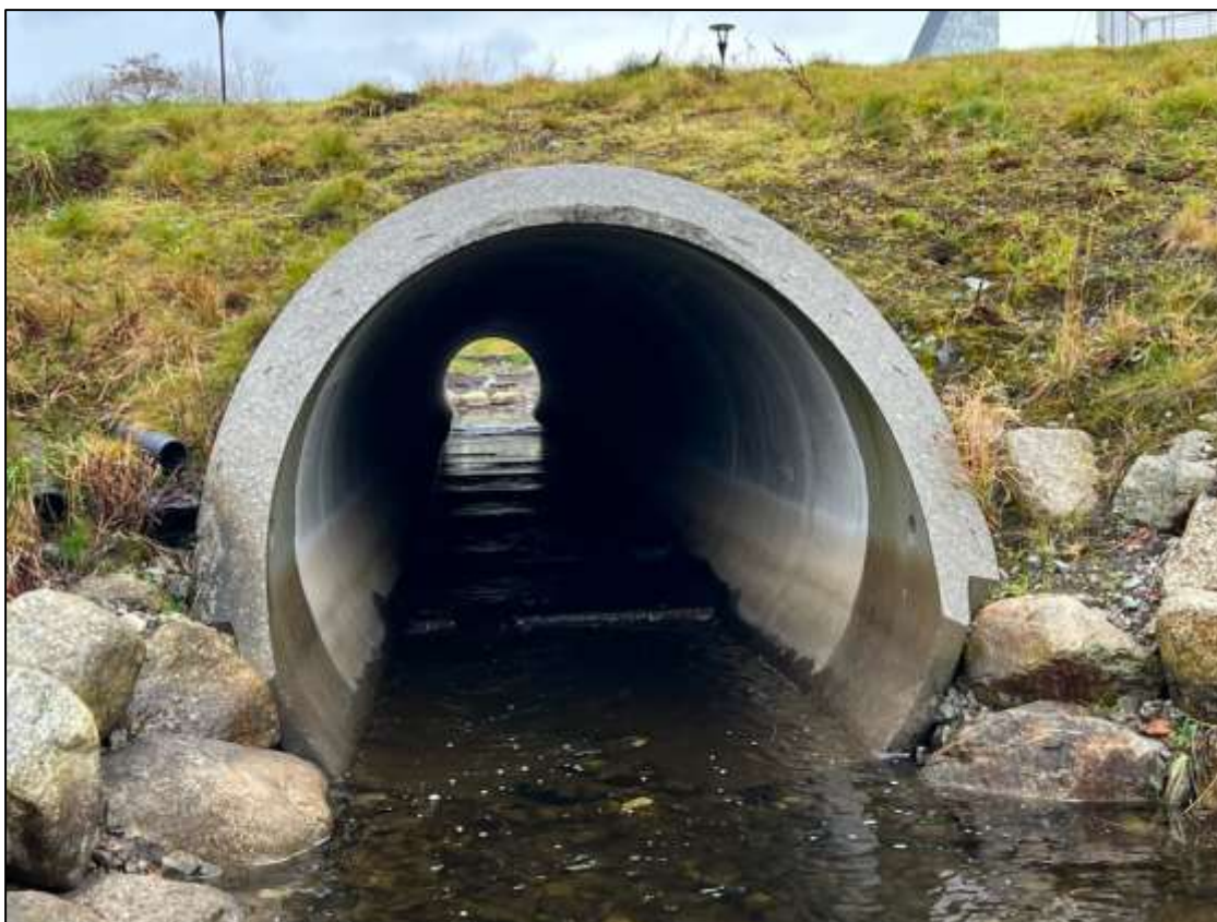
Figur 52. Betongkulvert i Tauvassdraget med støpte betongtrinn og noe naturlig bunnsstrat inni kulverten (Foto: Knut Ståle Eriksen, Sjøørretprosjektet i Rogaland).
