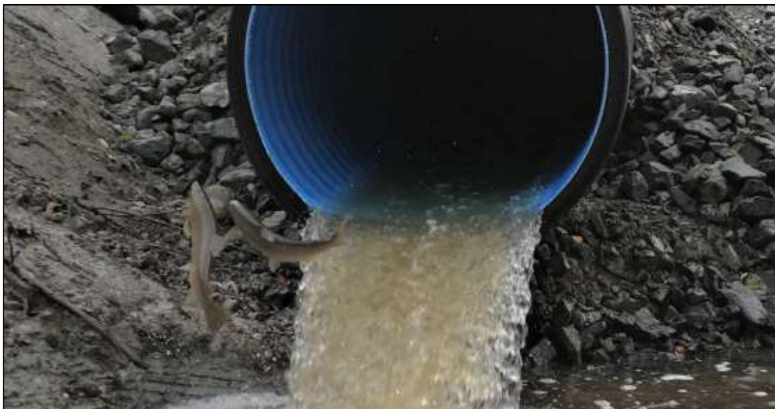
Figur 23. En feilkonstruert stikkrenne- Illustrasjon av hengende stikkrenne/kulvert (som skaper overheng og umuliggjør oppvandring for ål eller niøyer) (Foto: Lars Petter Tømmerås Wassmo).
