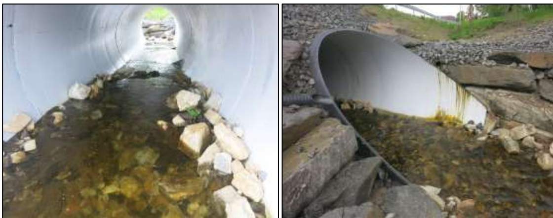
Figur 51. Sirkulære rør med terskler og naturlig bunnsbstrat (Foto: Trond Aalstad, Statens vegvesen).
