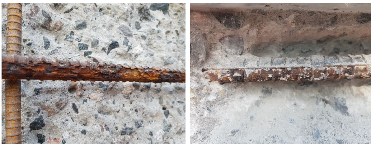
a) Armeringsjern på nordsiden av forankringspillaren i området da det ble utført mekanisk reasprasjon.
