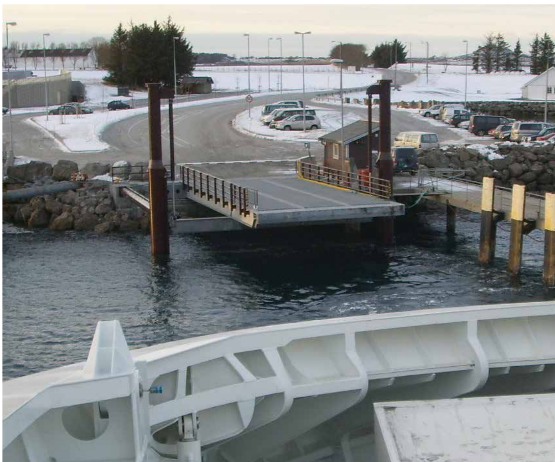
Figur 12: Ferjekaibru som ligger skjevt i brubås
