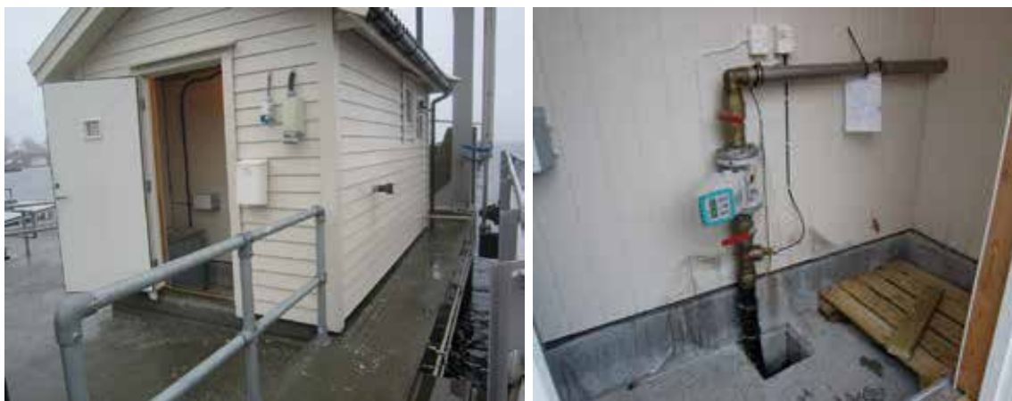
Figur 14: Vanntilkobling og vannmåler plassert i rom i aggregathus
