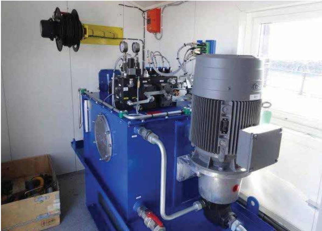
Figur 4: Innside av aggregathus med montert kabeltrommel, radiomottaker og hydraulikkaggregat
