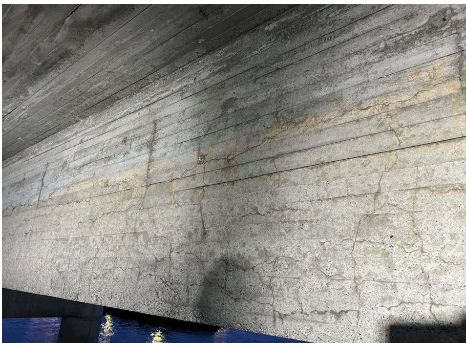
Figur 4.1: Riss i bjelke, felt mellom akse 31-32. Eget bilde.
