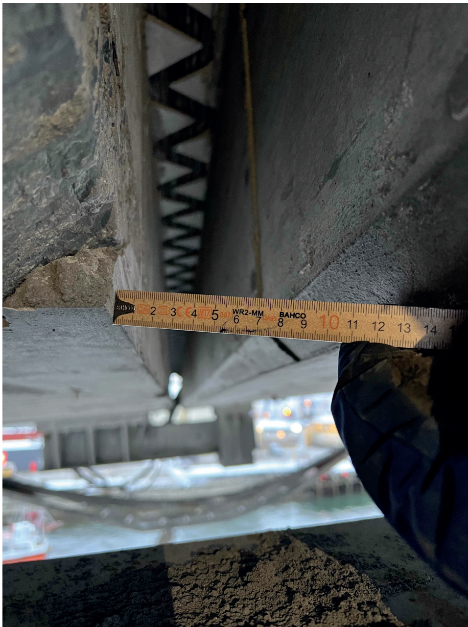
Figur 4.6: Åpning i fuge 1, mellom akse 7 og 8. Eget bilde fra inspeksjon.
