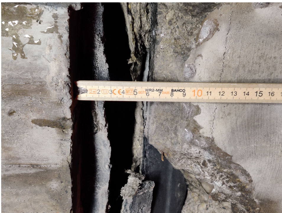
Figur 4.7: Åpning i fuge 2, i akse 32. Eget bilde fra inspeksjon.
