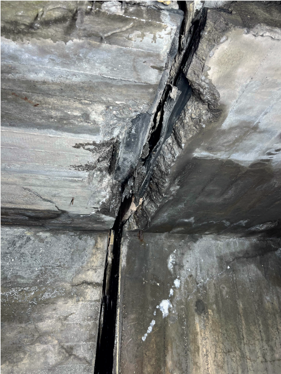
Figur 4.8: Fuge 2, i akse 32. Eget bilde fra inspeksjon.
