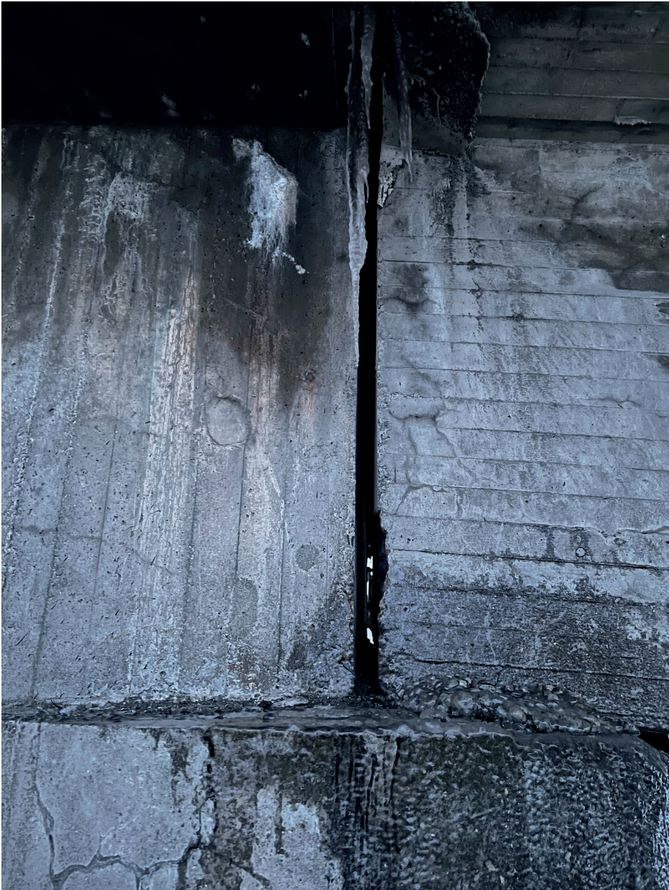
Figur 4.9: Fuge 3, i akse 37. Eget bilde fra inspeksjon.
