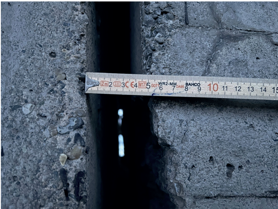
Figur 4.10: Åpning i fuge 3, i akse 37. Eget bilde fra inspeksjon.
