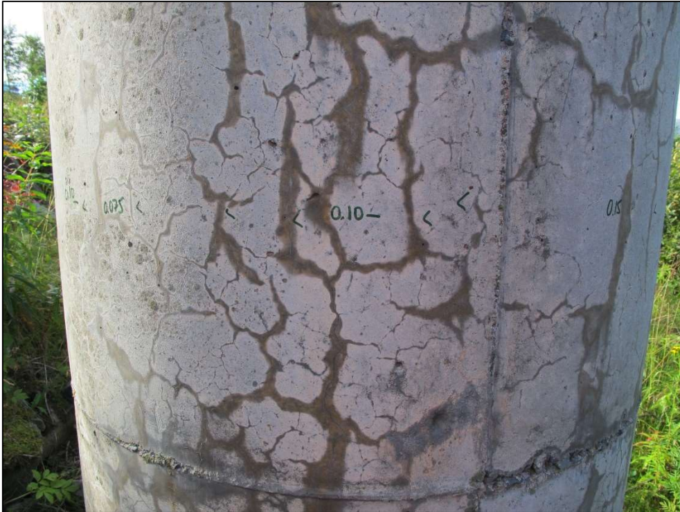
Figur 4-3 Krakelering på søyle [24]
