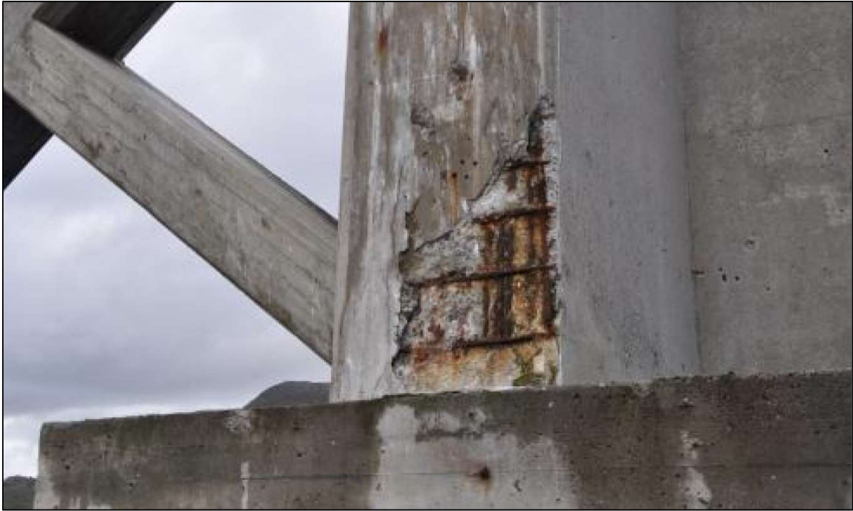
Figur 3-2 Korrosjon i tårnsøyle [16]
