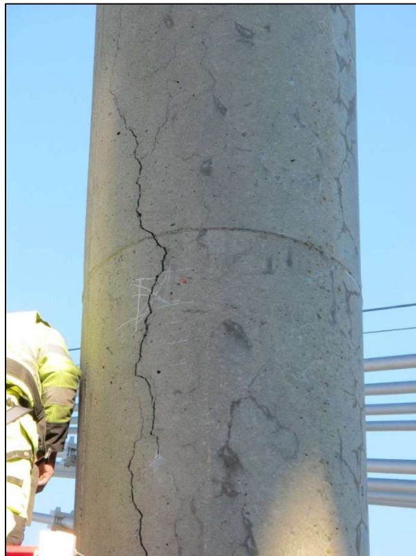
Figur 4-1 Vertikale riss i søyle i akse 28. [24]
