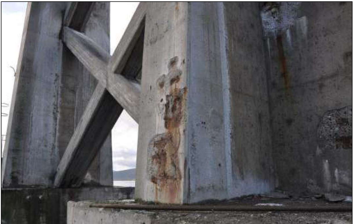
Figur 4-5 Avskalling og frilagt armering på tårnsøyle i akse 23 [16]
