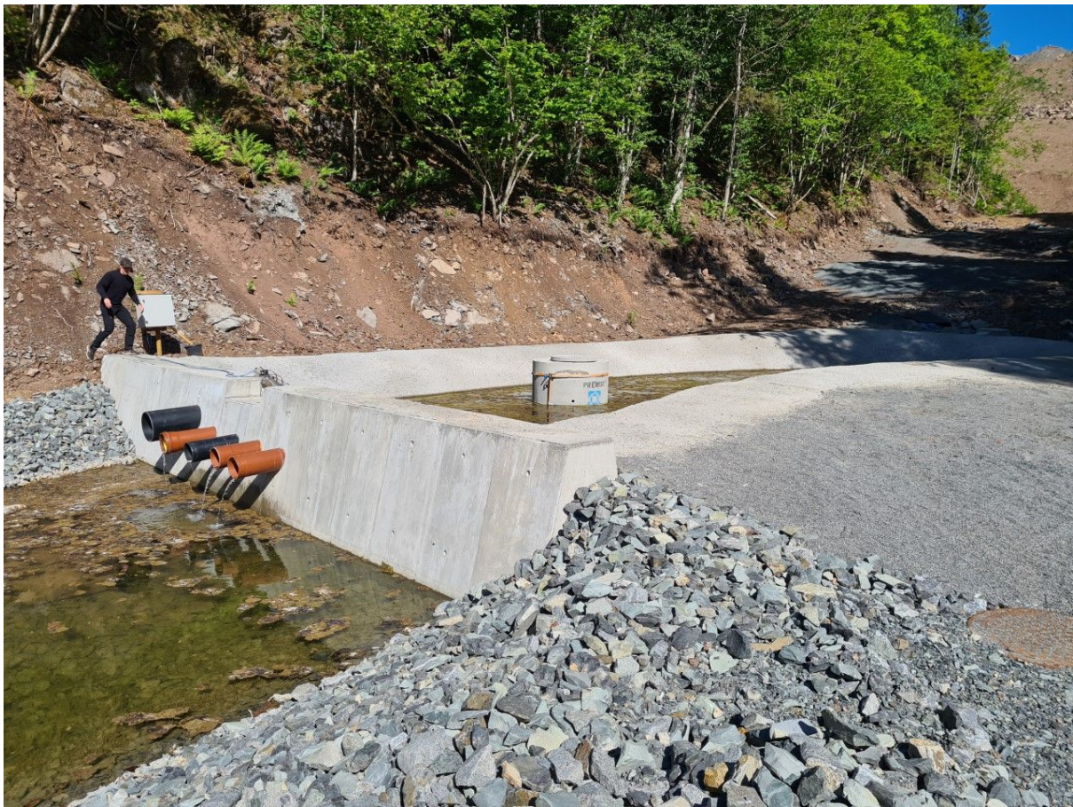
Figur 5. Innløpet fra forkammer til hoveddamen, med nedsunken innløpsrør. Masterstudent Magnus Evang fra NMBU blir sett til å krysse over. (foto: Manh-Tien Bui).
