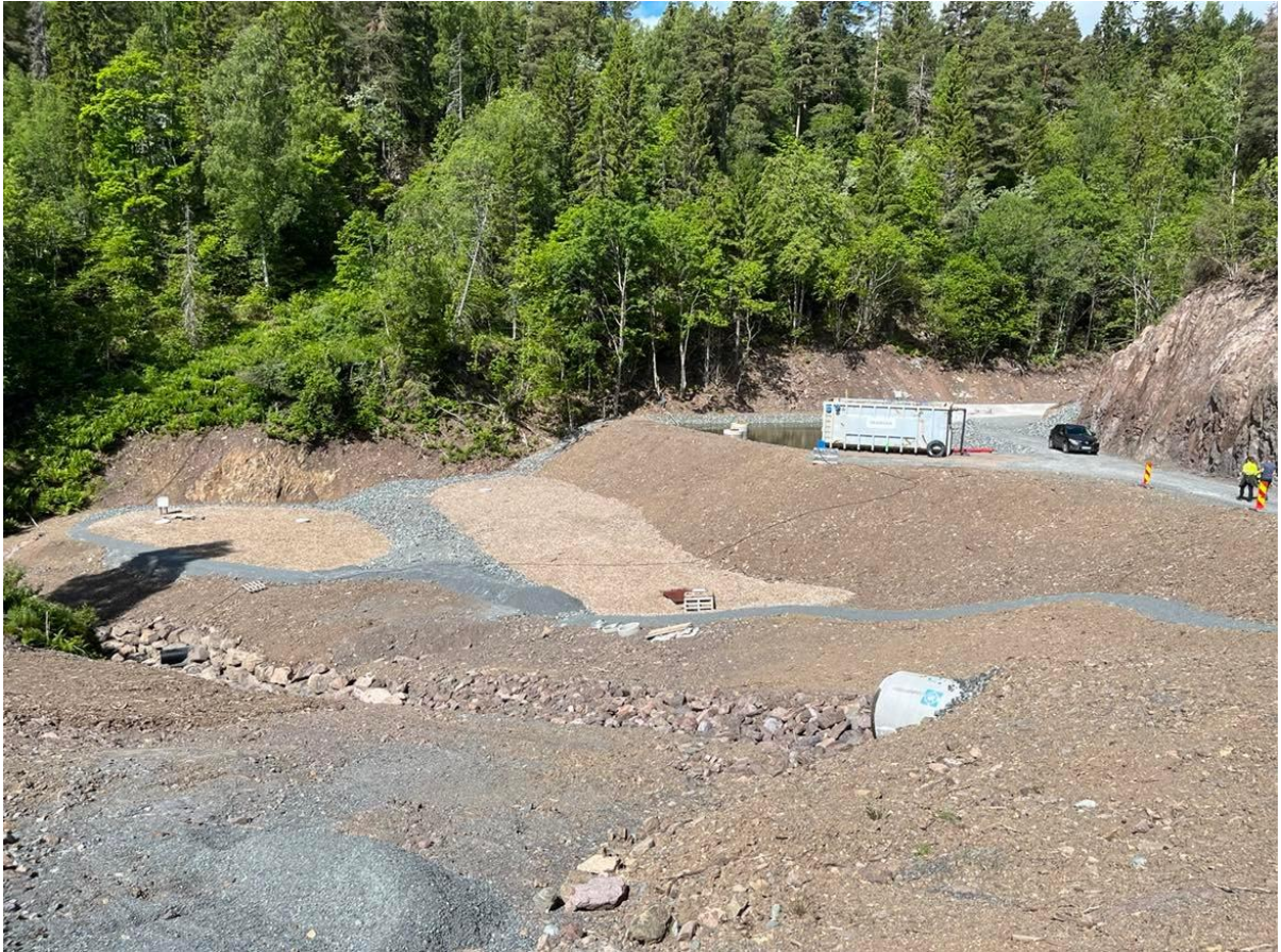
Figur 2. Bilde av reanseanlegget (bilde, Magnus Evang).
