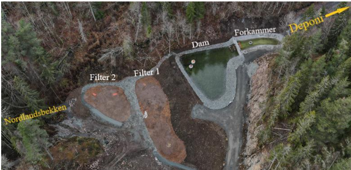
Figur 8. Dronebilde av de ulike lokasjonene i renseanlegget (dronebilde, SVV. Illustrasjoner, Magnus Evang).
