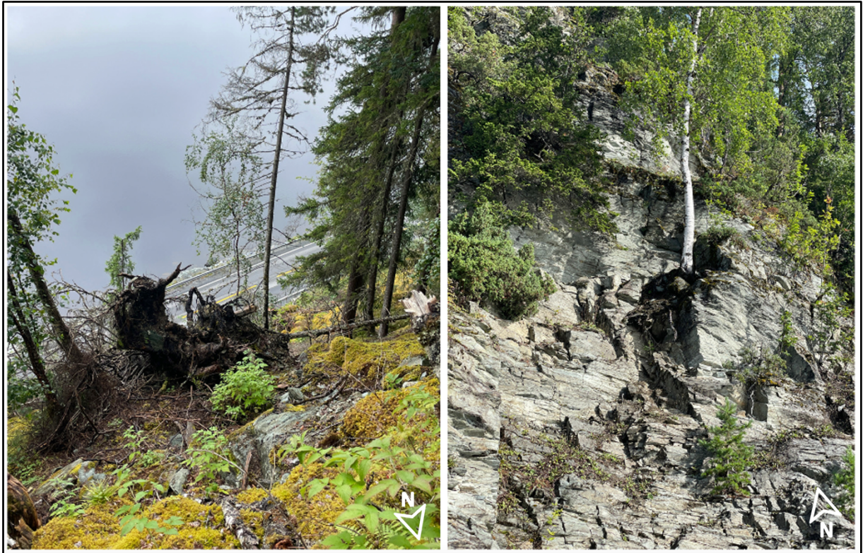
Figur 33: Venstre: Rotvelte like overfor vegen, observert under feltarbeid. Høgre: Potensiell rotsprenging eller rotvelte som kan gi steinsprang på vegen, observert frå E6. (punkt 3 og 4 i Figur 31)
