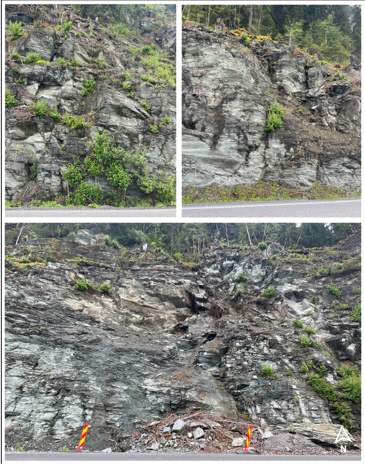
Figur 37: Oppsprekkingsgraden langs bergskjeringa varierer innanfor eit lite område. Gul meterstokk i dei to øvste bileta er 1 m (punkt 7, 8 og 9 i Figur 31, frå oppe til venstre).
