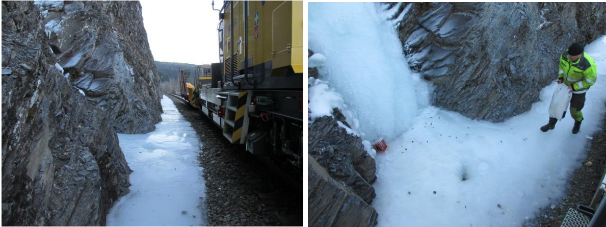
Figur V- 7a) Iskjøving i bekkeløpet har tettet stikkrenna. Dette har ført til omfattende iskjøving i grøfta langs skjæringen. b) Nedre del av nedføringsrenna. Det lille hullet i isen er laget med salt og viser plasseringen av stikkrenna. Det er lagt ut saltstein for å smelte en åpen kanal for vannet ned til stikkrenna. Foto: A. Liereng (15.1.16)
