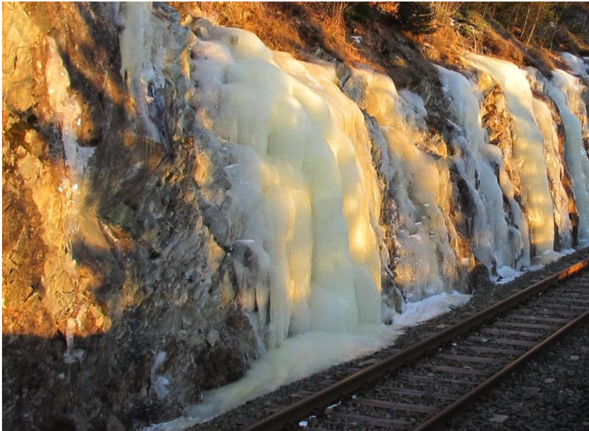
Figur 27) Vann som renner langs isen i skjæringen fører til iskjøving i grøfta. Brennhaugen, Meråkerbanen. Foto: A. Liereng
