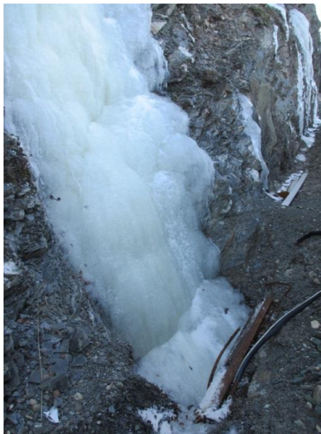
Figur V- 4) Innløpet til stikkrenna er ikke fylt med is. Det er ikke stikkrenna som er årsaken til iskjøvingen i bekken. Foto: A. Liereng (15.1.16).
