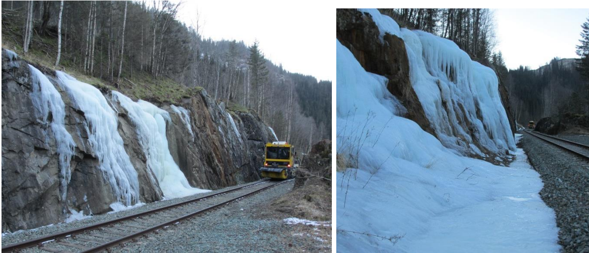
Figur V-14a) Iskjøving i skjæring ved Sørkringen, sett mot sør. Profilet er smalt og det må derfor fjernes is fra både skjæringen og grøfta enkelte vintre. b) Iskjøving i nordenden av skjæringen. Isen holdes på å fylle grøfta. Foto: A. Liereng (15.1.16).
