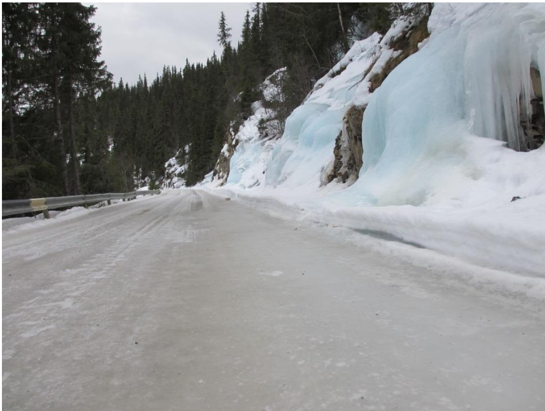
Figur 13) Iskjøving i fjellsiden fører vann ut i vegbanen, der det fryser til is. Breidalen, Oppland. Foto: A. Liereng (14.1.16)
