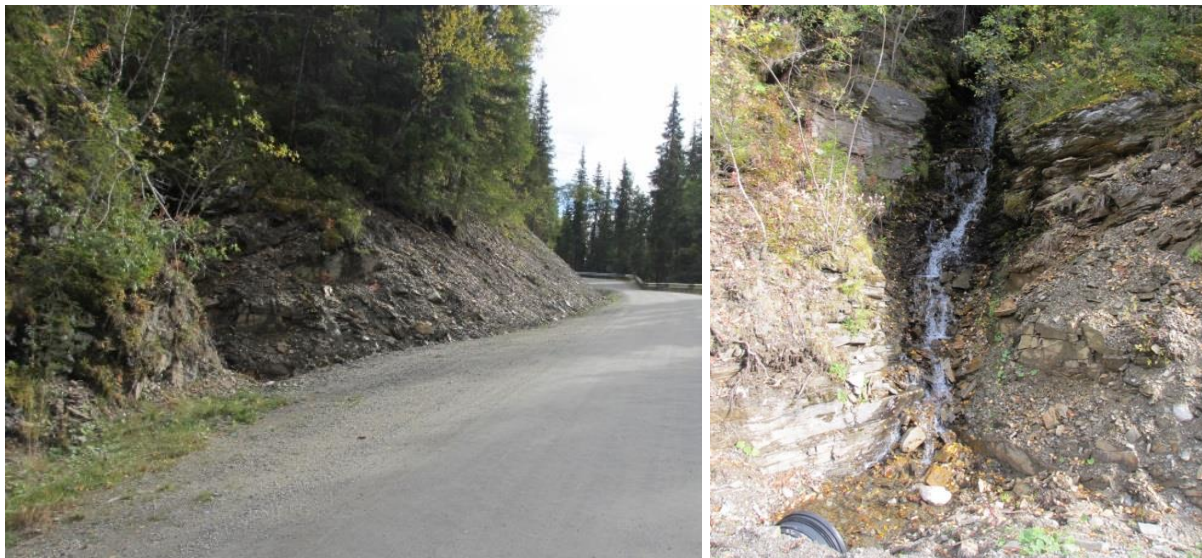
Figur 81a og b) Eksempel på godt utformet bekkeløp og innløp til stikkrenne langs Tann-Annolsetervegen. Bekken renner i en dyp og smal nedføringsrenne. Det var ingen iskjøving i stikkrenna vinteren 2015/16. Foto: A. Liereng (20.9.15).
