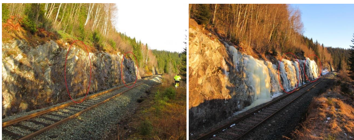
Figur V-27a) Skjæring ved Brennhaugen. Skjæringen er våt, selv i tørt vær. Foto: A. Liereng (5.11.15) b) Iskjøving langs skjæringen starter der løsmassedekket slutter. De røde ringene er plassert på samme sted i de to bildene. Foto: A. Liereng (15.1.16).
