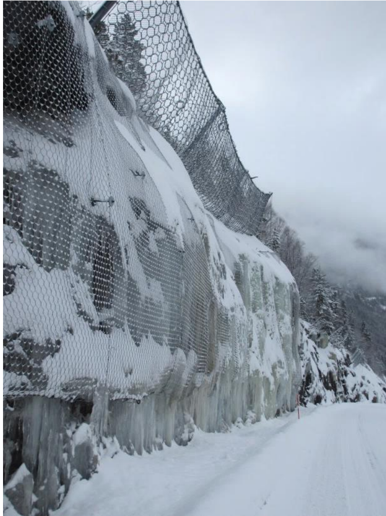
Figur 79) Fanggjerdar plasseres ovenfor infrastrukturen som skal beskyttes mot isras fra bratte fjellsider. Tiltaket kombineres ofte med isnett i skjæringen. Fv 651 (Telemark). Foto: A. Liereng
