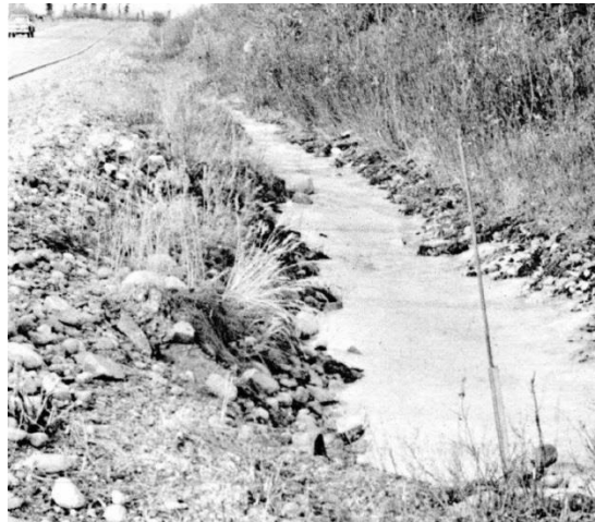
Figur 22) Iskjøving fra bunnen av grøft på grunn av lav vintervannføring (Carey, 1977).
