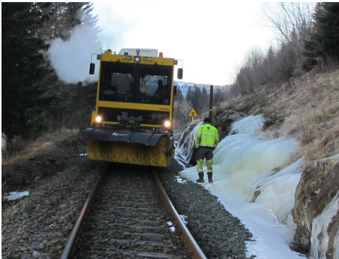
Figur V-24) Iskjøving i jordskråning har fylt grøfta og er på veg ut i sporet. Bildet er tatt vest for brua, sett mot vest. Isen har bygget seg opp i en periode med barfrost. Foto: A. Liereng (15.1.16)
