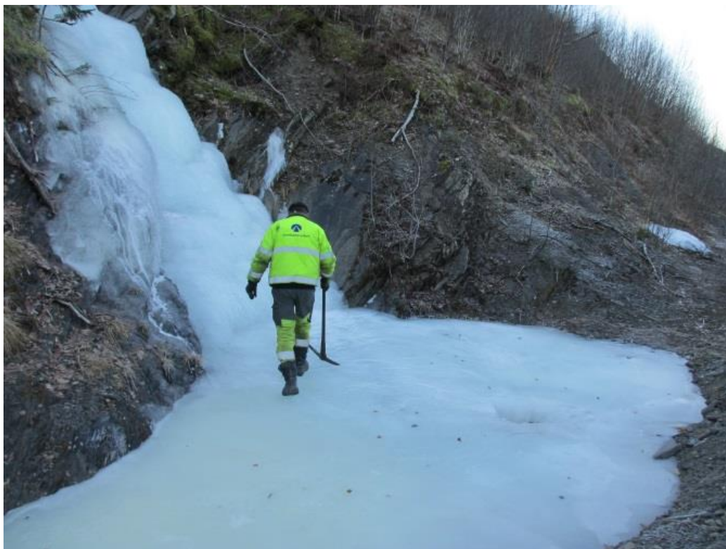
Figur V- 12) Iskjøving i bekkeløp og innløp til stikkrenne. Hullet i isen er laget av en saltstein. Etter at bildet ble tatt, ble det lagt ut mer salt for å smelte en åpen kanal for vannet ned til stikkrenna. Foto: A. Liereng (15.1.16).
