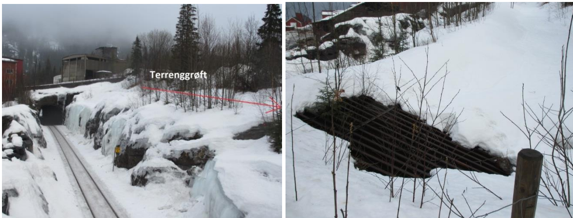
Figur V- 86a) Det er laget en terrenggrøft for å samle vann på oversiden av skjæringen, vist med rød linje (pil i fallretningen). b) Vannet i terrenggrøfta ledes til dette inntaket. Vannet renner ned i en vanntunnel under sporet ut til fjorden. Foto: A. Liereng (15.3.16).
