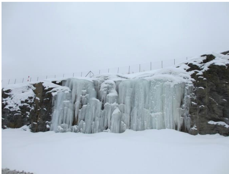
Figur 65) Konsentrert iskjøving i østre del av skjæringen. Den lukkede drensgrøfta i berget klarer ikke samle alt vannet. Foto: A. Liereng (11.3.16).
