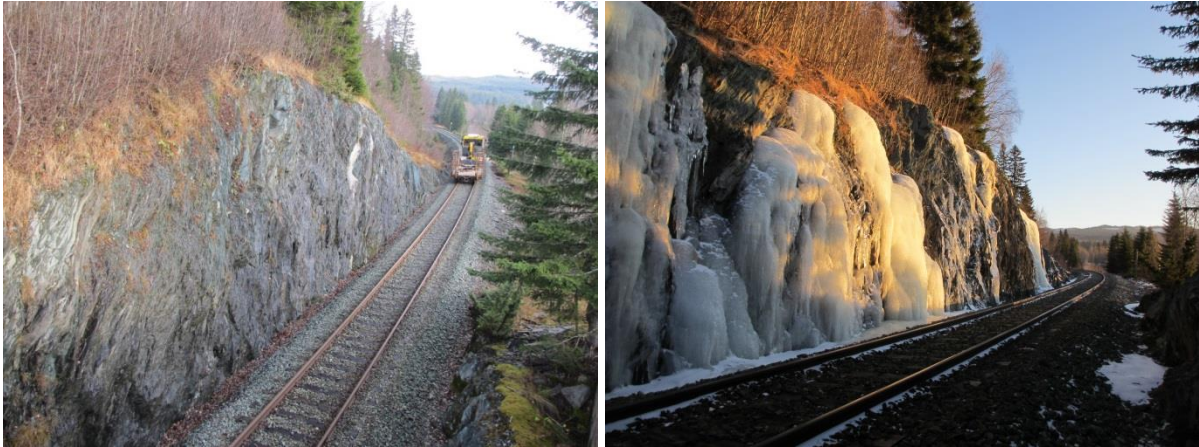
Figur V- 33a) Østre del av skjæringen. Bergmassen er skifrig og har tydelige sprekkeplan som faller ut av skjæringen. Berget er dryppende vått selv i tørt vær. Foto: A. Liereng (5.11.15) b) Iskjøvingen starter helt i toppen av skjæringen, der løsmassedekket slutter. En del issvuller starter også midt i skjæringen, ved markerte sprekkeplan. Foto: A. Liereng (15.1.16)
