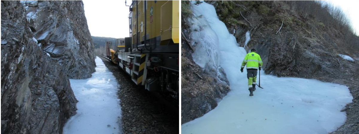
Figur 25a) En stikkrenne har frosset igjen og forårsaket iskjøving i hele grøfta. Sørkilmo vest, Meråkerbanen 2. b) Igjenfrosset stikkrenne ved bekkeløp. Isen fyller grøfta. Sørkilmo øst, Meråkerbanen 3. Foto: A. Liereng
