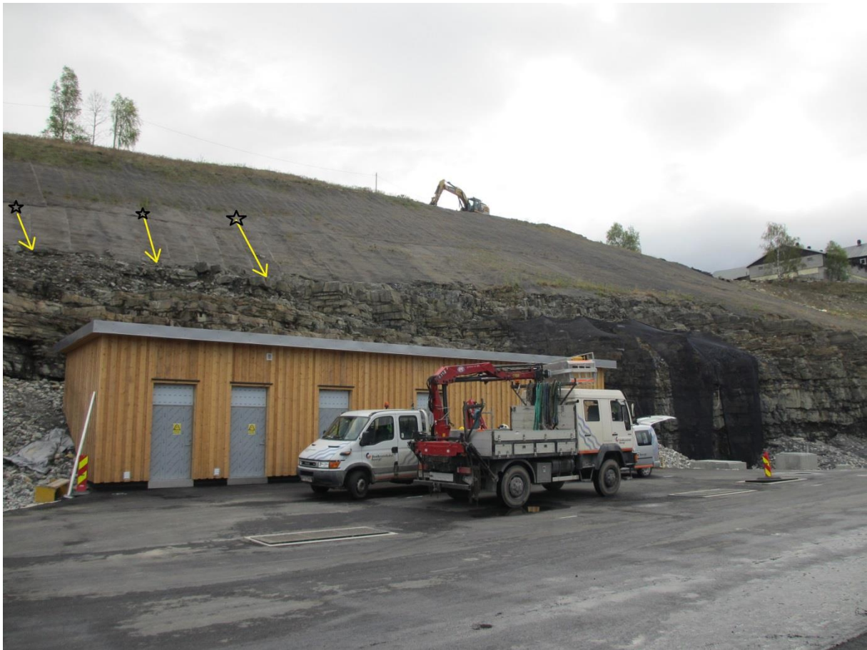
Figur 100) De svarte stjernene viser utspring av grunnvann. Vannet renner ned til fjellskjæringen som vist med gule piler. Vannet fordeler seg utover de flate berghyllene og samles i to nedløp bak teknisk bygg. Foto: A. Liereng (19.5.16).
