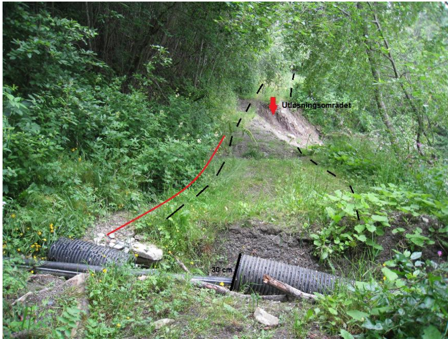
Figur 5.12 Utløsningsområdet til skred 2 markert med rød pil. Beliggenheten til utløsningsområdet befant seg langs den ytre skulderen til skogsbilveien, markert med svart stiplede linje. Utløsningsområdet lå lavest langs skogsbilveistrekningen. Den ødelagte stikkrenna ble målt til å være 30 cm i diameter (svart strek), og siden utløsningsområdet lå lavere i forhold til beliggenheten til stikkrenna, rant vannet nedover mot dette partiet. Rød linje viser hvor det ble observert spor etter rennende vann i retning ned mot utløpsområdet. Det ble ikke observert noen grøft langs det indre partiet til skogsbilveien, der vannet ideelt sett skulle blitt drenert Foto: Daniel Haugen Edvardsen.
