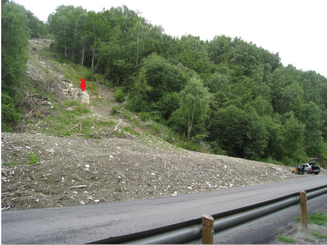
Figur 5.16 Bildet viser utløpsområdet til skred 2. Rød pil markerer hvor det ble observert rennende vann i siste del av skredbanen, over fremstikkende berggrunn. Skredavsetningen ble målt til å være ca. 50 meter bred. En ledevoll i etterkant av skredhendelsen har blitt bygget i utløpsområdet. Foto: Daniel Haugen Edvardsen.
