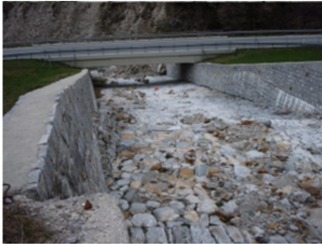
Figur 5.2: Bygging av bru og ledemurer for å styre skredmassene under vegen, Ponte Rossa, Biasca, Sveits, Foto: Giorgio Valenti (Vegdirektoratet, 2012)
