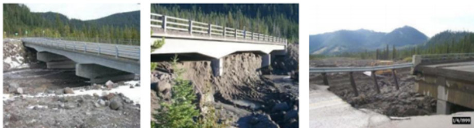
Figur 5.1: Foto av bru hvor skredet har stoppet opp under brua. White River Bridge, Oregon (Vegdirektoratet, 2012)
