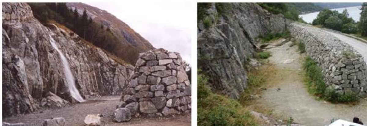
Figur 20: Foto av fangvoll med bratt tørrmur langs Rv 7 Indre Rotagjelet, Hordaland (Norem 2011 Figur 8.25).
