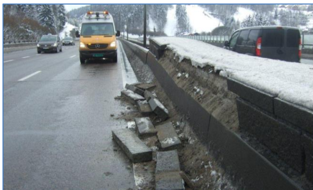
Figur 3.5 Skader på midtdeler på landkar pga. setninger i Skullerudkrysset (A G. Olsen, 2008).
