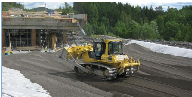
Figur 3.1 Utlekking av lettklinker (Leca) ved brokar ved E18 i Spydeberg (Ref.42).
