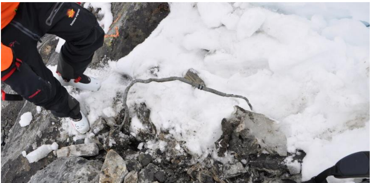
Figur 5.28 - Kabelen til glidesko 1 har blitt utsatt for store krefter også i forsøksåret 2014/2015 (foto: Tore Humstad, SVV, 7. mai 2015).
