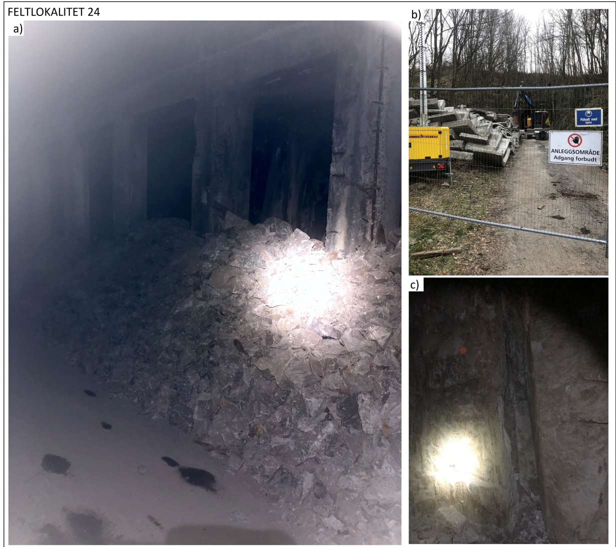
Figur 7.15: Bilder fra den gamle jernbanetunnelen som nå brukes som tursti (feltlokalitet nr. 24). Figur a) viser hvor store mengder utrast stein som lå oppå de gamle betongelementene, figur b) viser anleggsområdet med gamle betongelementer som har blitt fjernet. Figur c) viser en sleppe i tunnelen der materiale har rast ut. Foto: Siri Engeskaug 7.11.2019.
