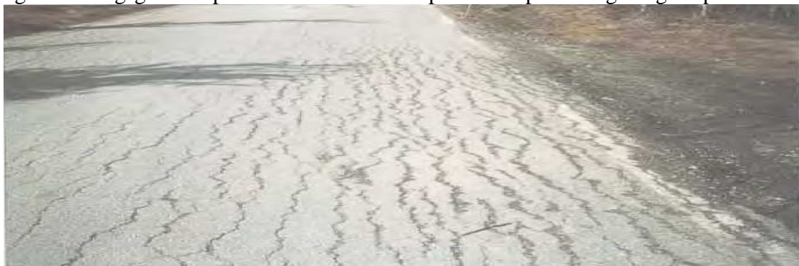
Bilde 8: Andre langsgående sprekker
