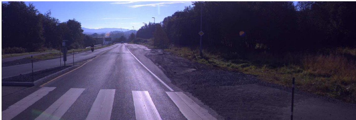
Bilde 26: Mangel på asfalt ved siden av vegen fører til kantskader
