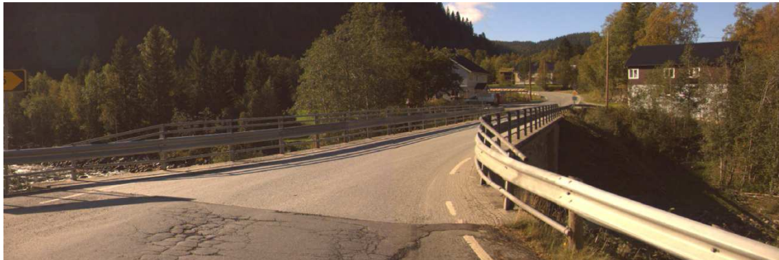
Bilde 11: Andre tversgående sprekker
