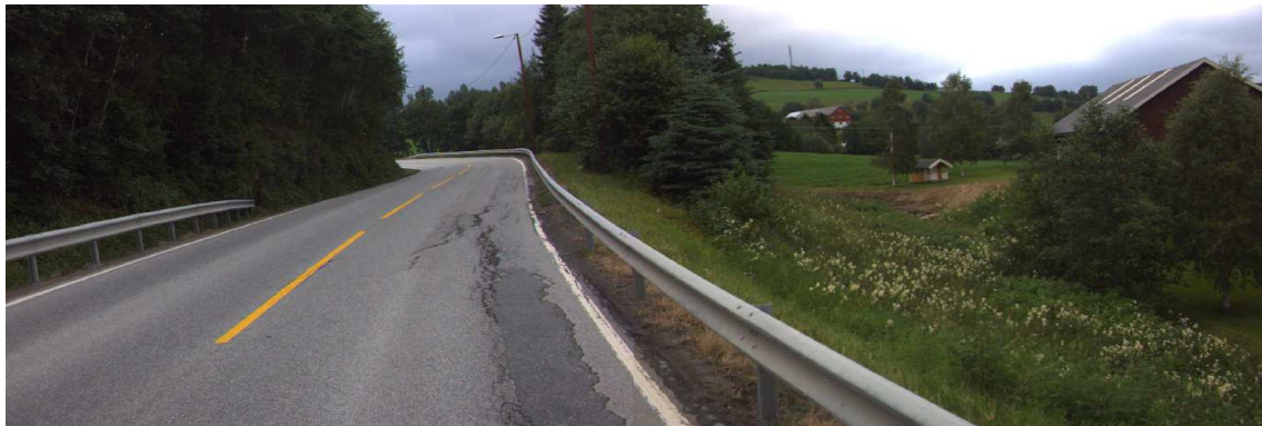
Bilde 29: Langsgående sprekker og kantskader
