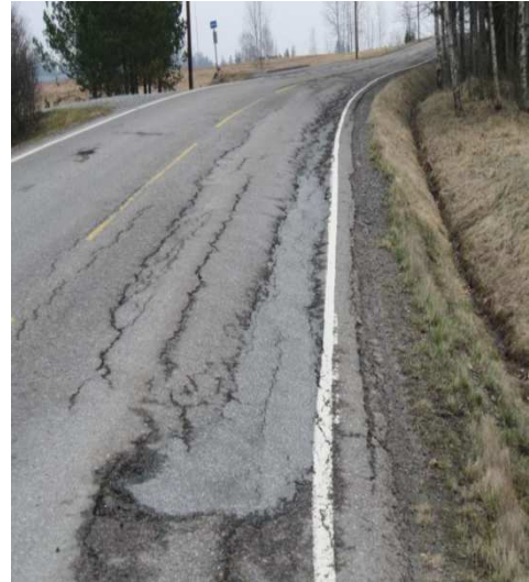
Bilde 1: Dårlig fundament
