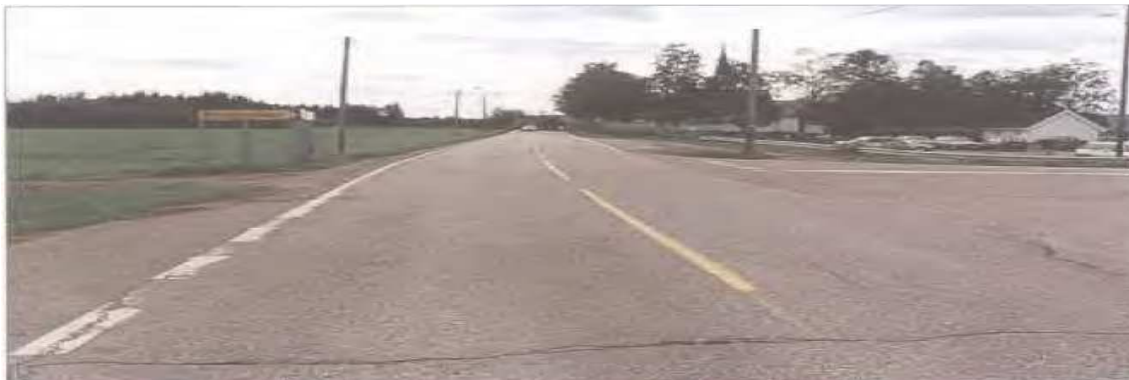
Bilde 9: Tversgående sprekker
