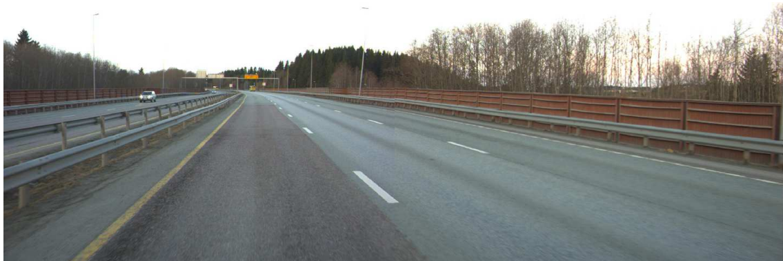
Bilde 37: Langsgående sprekker og kantskader
