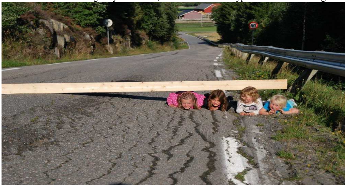
Bilde 12: Sideglidning med langsgående sprekker
