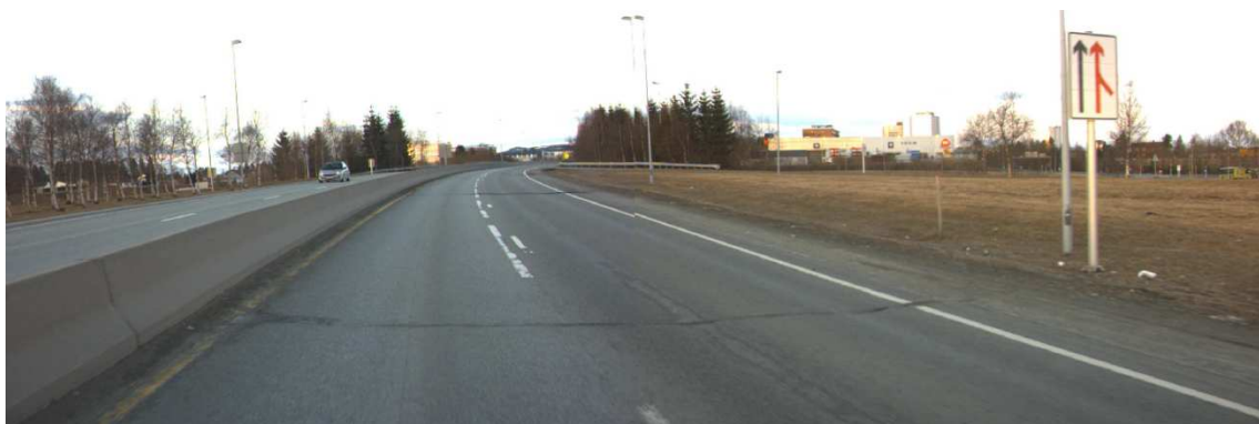
Bilde 39: Tversgående sprekker
