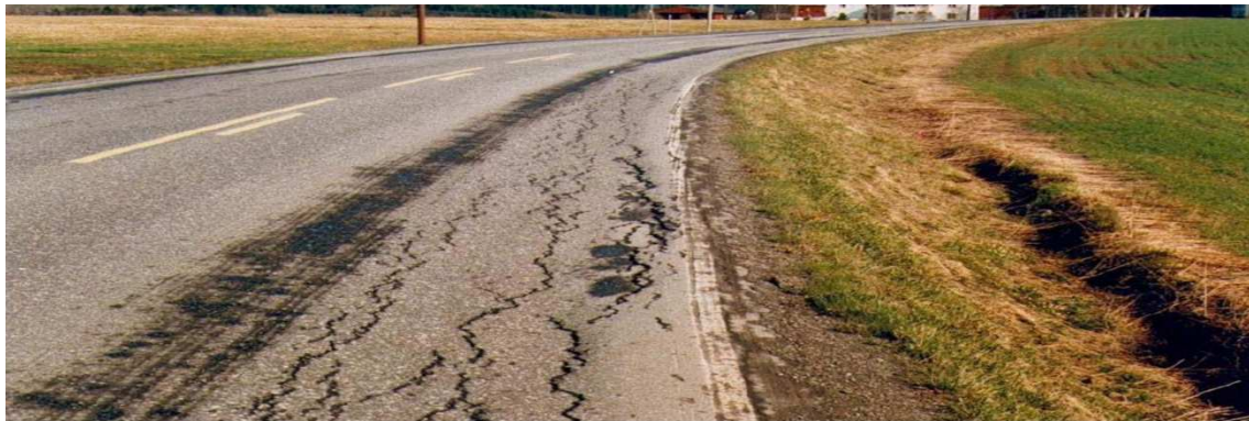
Bilde 6: Kantskader og nedkjørt vegskulder
