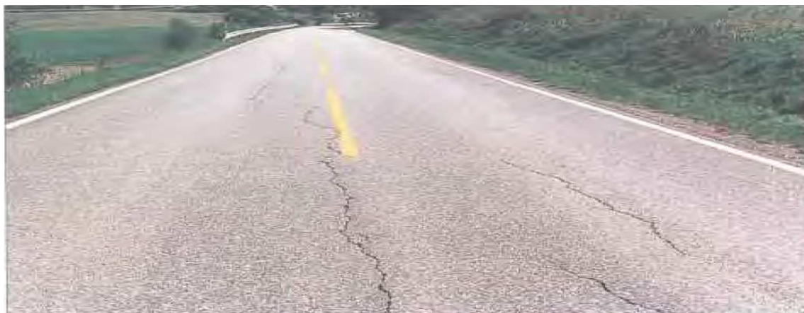
Bilde 5: Sprekker i lengdeprofil
