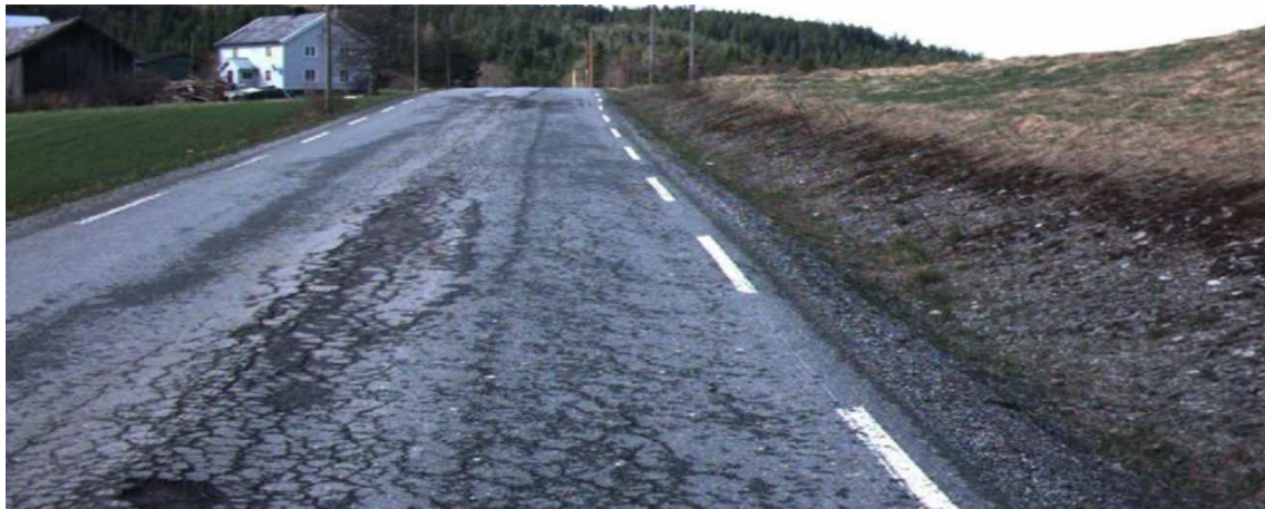
Bilde 4: Stor krakelering på vegdekke
