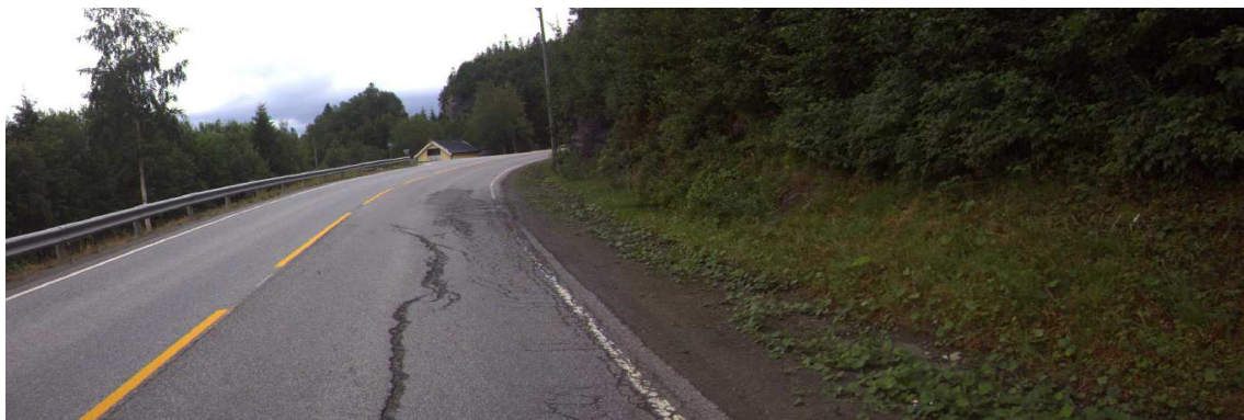
Bilde 30: Langsgående sprekker, nedkjørt vegskulder og mangel på drenering
