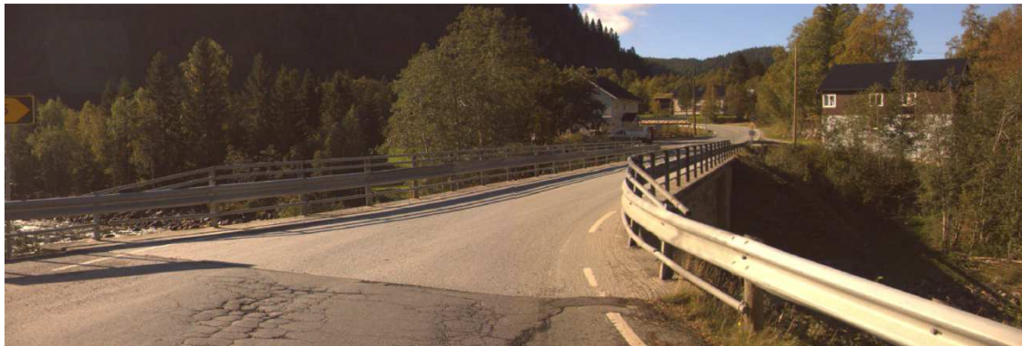
Bilde 34: Andre tversgående sprekker
