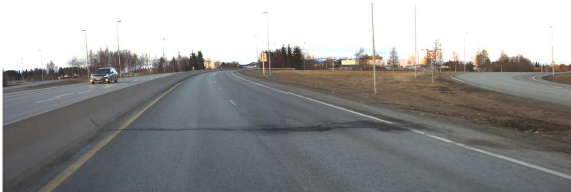
Bilde 38: Tversgående sprekker og slaghull
