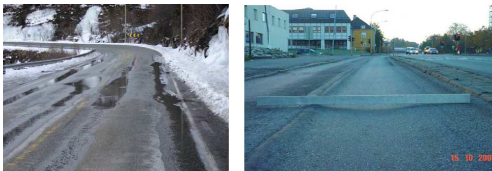
Bilde 1: Sporete og deformerte asfaltdekker
