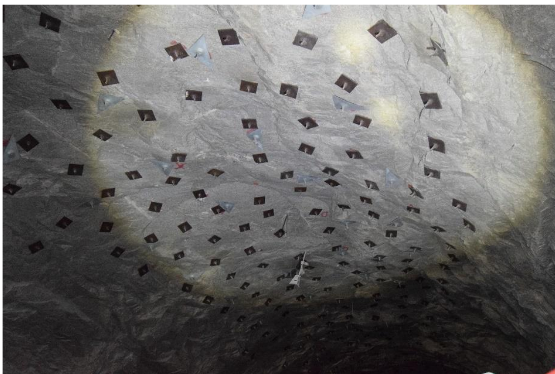
Figur 16, Gamle sikringsbolter, tydelig at opprinnelig entreprenør var usikker på fjellets kvalitet.
