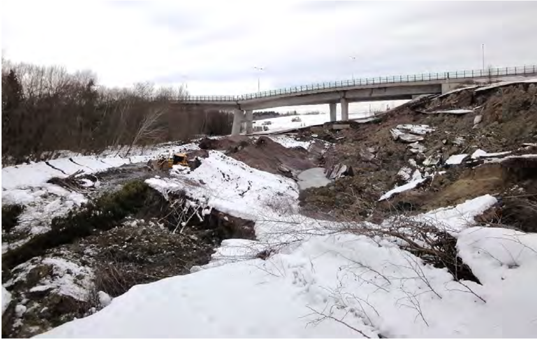
Figur 1–4 Bilde av kvikkleireskred E18 Skjeggestad Foto: Frode Oset, Statens vegvesen
