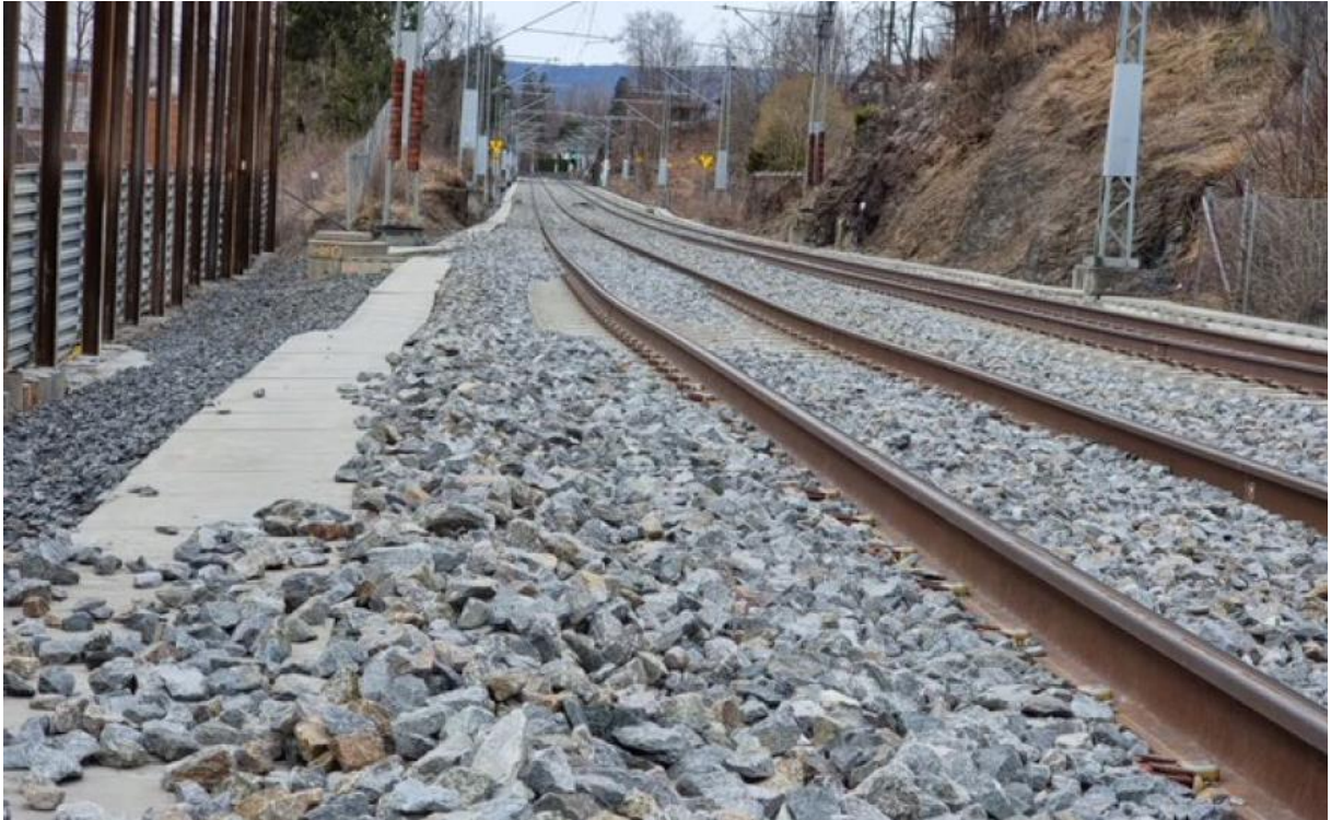
Figur 26: Deformasjoner på sporet ved boring av stag.
