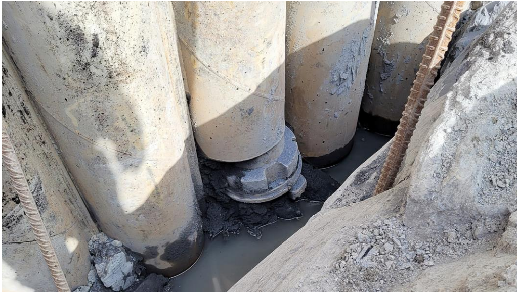
Figur 20: Borkrone i bunn rør.
