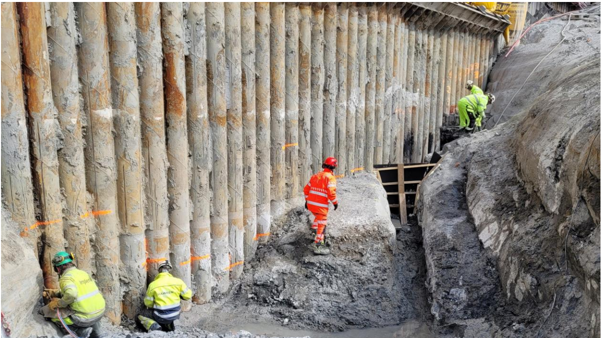
Figur 25: Parti der fot ble sikret med betong mellom vegg og oppstikkende bergrygg.
