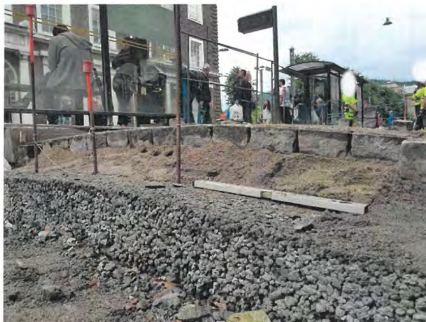
Figur 2.10 Bilder fra ferdig lagt Felt 3 (drensbetong med fiber) ved testfelt Olav Kyrres gate. Foto: SVV Reidun Aastveit.
