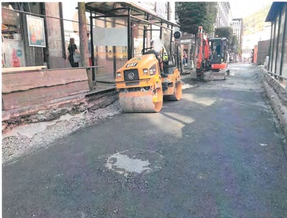
Figur 2.5 Bilde fra Testfelt Olav Kyrres gt. Topp forsterkningslag med avretting og lagt i bue, klargjort for etablering av bærelag. Foto: SVV Reidun Aastveit (sendt 2. august 2018).
