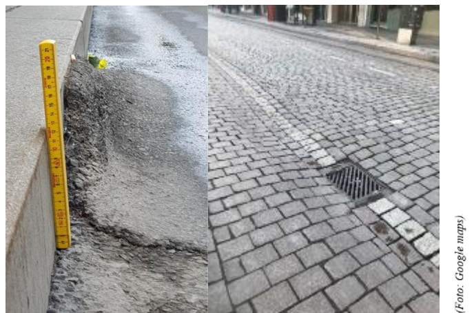
Figur 2-2: Setninger på brostein og asfalt som har beveger seg opp etter platekantstein.
