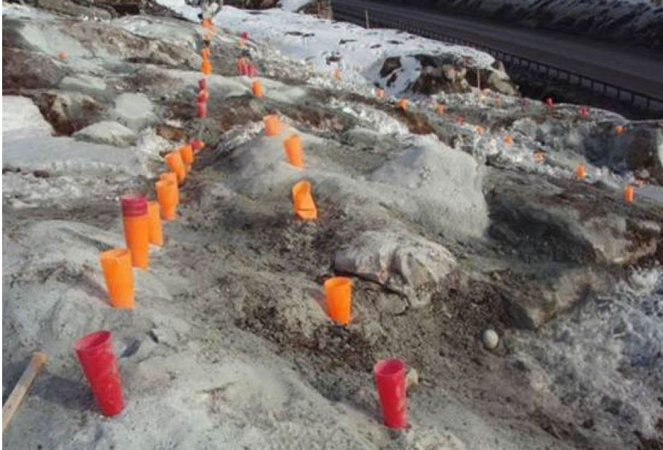
Figur 6.1 Bildet viser eksempel på uheldig plassering av hull ved slettsprengning. Konturen til venstre med akseptabel forsetning (avstand til neste hullrast – hjelperasten – midt på bildet). Det er derimot langt til neste hullrast (til høyre i bildet), dvs. alt for stor forsetning for hjelperasten. Foto: H. Fagerheim.
