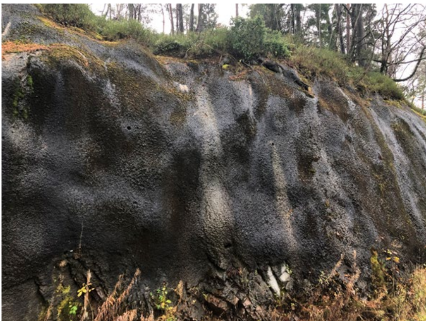
Figur 5.7 Fyllingsdalen i Bergen. Eldre sprøytebetong i bergskjæring overvokst av mose og annen vegetasjon. Ingen synlige bolter, men det er boret drenshull. Foto: Statens vegvesen.
