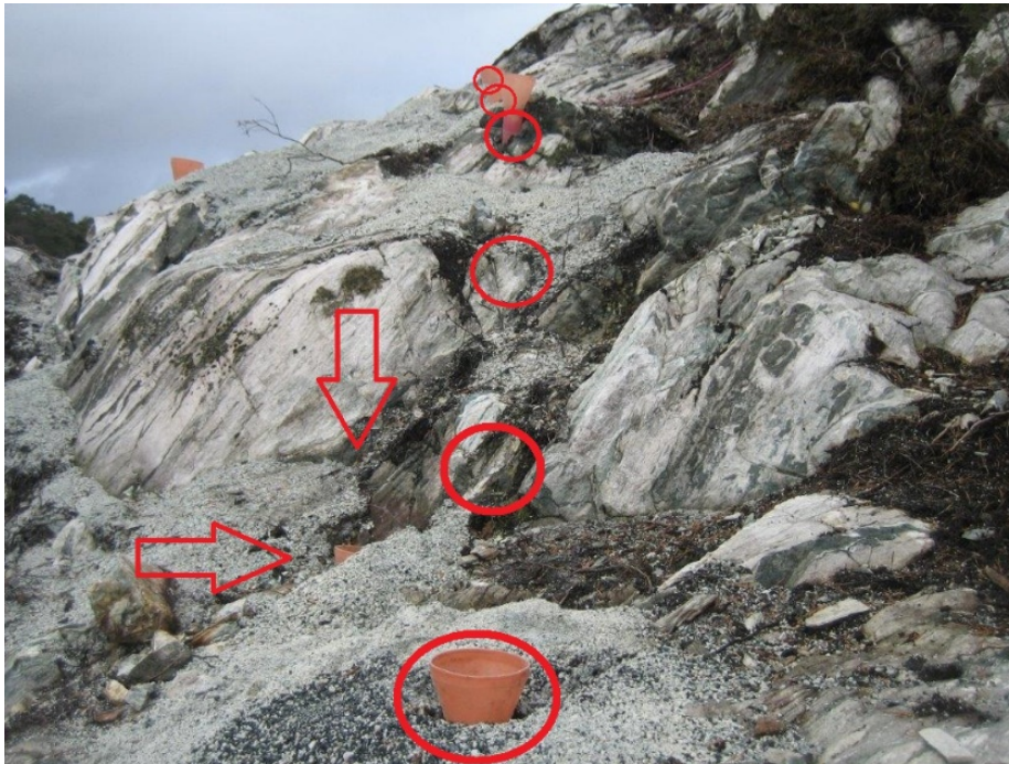
Figur 6.3 Eksempel på unøyaktig utsetting/boring i kontur. Planlagte konturhull er ringet inn, og de to konturhullene midt på bildet er erstattet av ett hull i nedkant av den skrå flaten vist med piler. Det er ikke satt ut en tydelig linje med merke for hvert ansett. Foto: T. Kirkeby.
