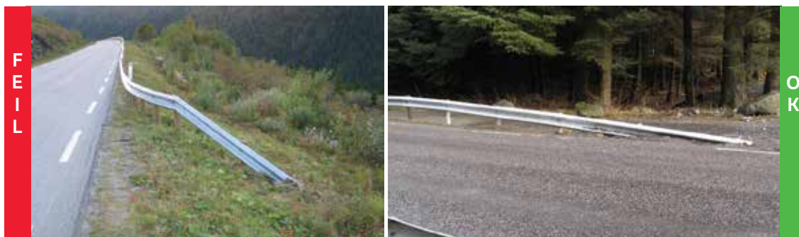
Figur 4.11: Eksempel på feil (venstre) og riktig (høyre) bruk av nedføring av rekkverksende. Venstre foto viser en altfor bratt nedføring (over kun én skinnelengde) med ikke tilfredsstillende forankring (stolpetetthet).
