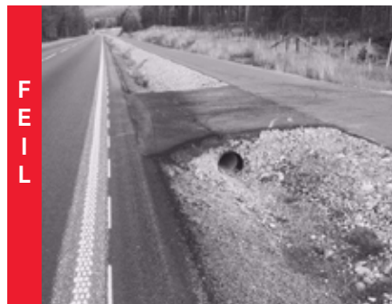
Figur 2.24: Eksempel på påkjørselsfarlig stikkrenneavslutning gjennom kryssende veg
