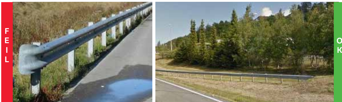
Figur 4.4: Eksempler på ulovlig (fiskehale) og lovlig rekkverksavslutning. Venstre foto: Ved påkjørsel av en slik «fiskehale» er det stor fare for at rekkverket vil trenge inn i bilens karosseri.
