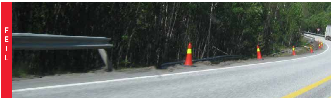
Figur 3.43: Eksempel på rekkverk som står ubeskyttet i lang tid etter påkjørsel. Rekkverksskinnen som står ubeskyttet i full høyde, utgjør en svært stor sikkerhetsrisiko.
