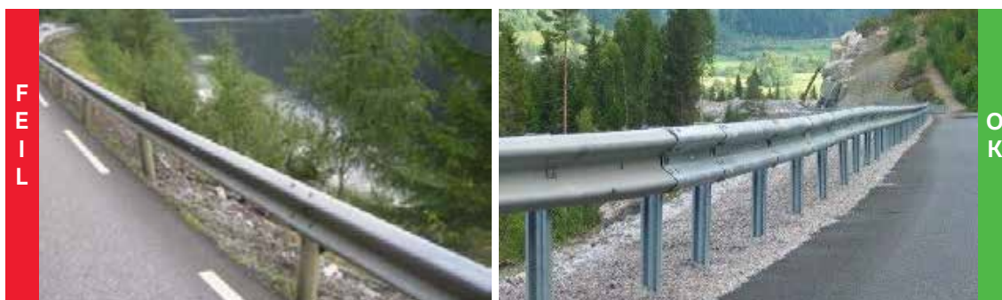
Figur 3.15: Eksempel på feil (venstre) og riktig (høyre) plassering av rekkverk ved skråning mellom 1:3–1:1,5. Rekkverket på venstre foto har mangelfull innfestingsbredde – og utilstrekkelig styrkeklasse.
