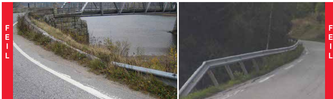
Figur 3.44: Eksempler på rekkverk der rekkverksfunksjonen er redusert. Slike situasjoner utgjør en stor sikkerhetsrisiko ved en eventuell utforkjøring fordi et kjøretøy lett kan komme over rekkverket (venstre foto) eller bøye det ned (høyre foto).
