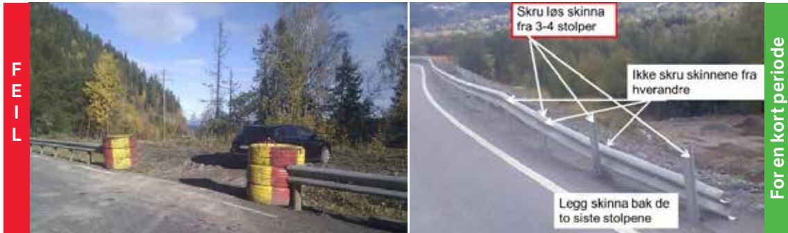
Figur 3.42: Eksempel på feil sikring (venstre) og akseptabel sikring for en kort periode (høyre) av rekkverk ved montering. Dekkstablene foran en rekkverksskinne som er avsluttet i full høyde, er ikke tilstrekkelig til å ufarliggjøre rekkverkssenden.
