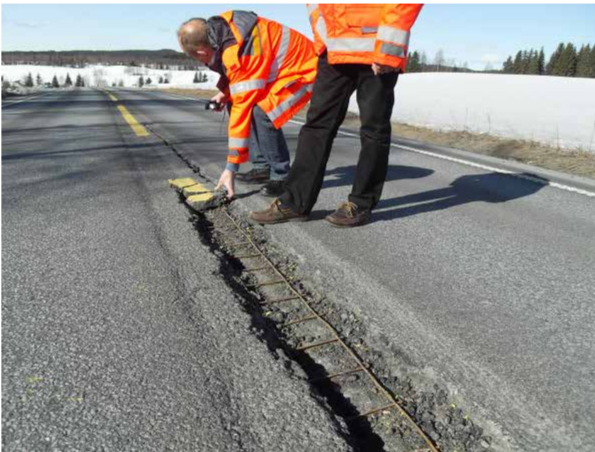
Figur B15.3 Skader i vegdekket der armeringen er lagt med skjøt langs midten av vegen. (Foto: Geir Berntsen, Statens vegvesen)
