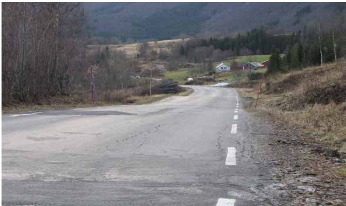
Figur B20.1 Ujevne telehiv. (Foto: Per Otto Aursand, Statens vegvesen)
