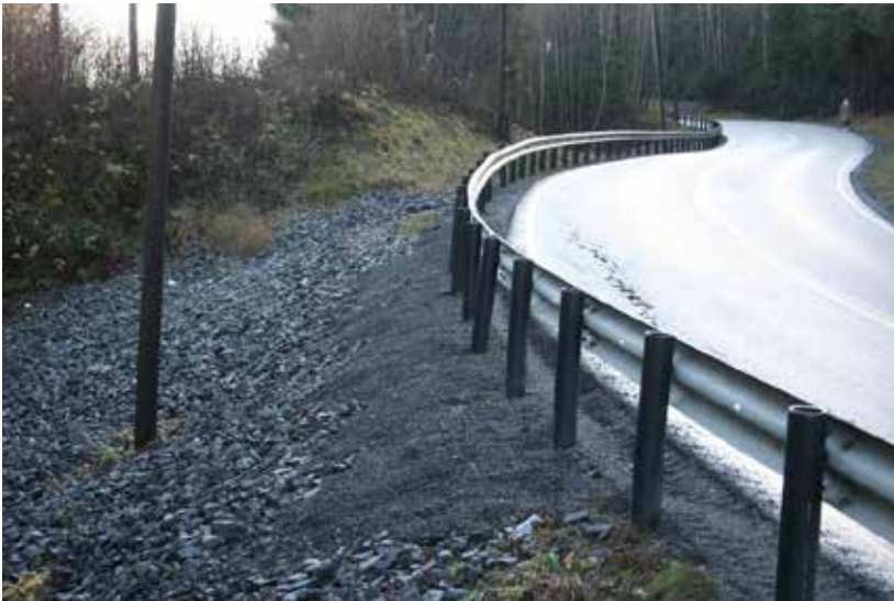
Figur B13.1 Stabil skråning av kult med helning 1:2 eller slakere hjelper lite dersom problemet er et svakt vegfundament. (Foto: Ukjent).
