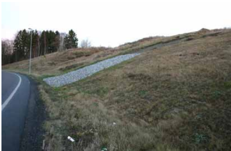
Figur B1.4 Før vegetasjonen er godt etablert, er vegskråninger særlig utsatt for erosjon og utglidning. (Foto: Statens Vegvesen)
