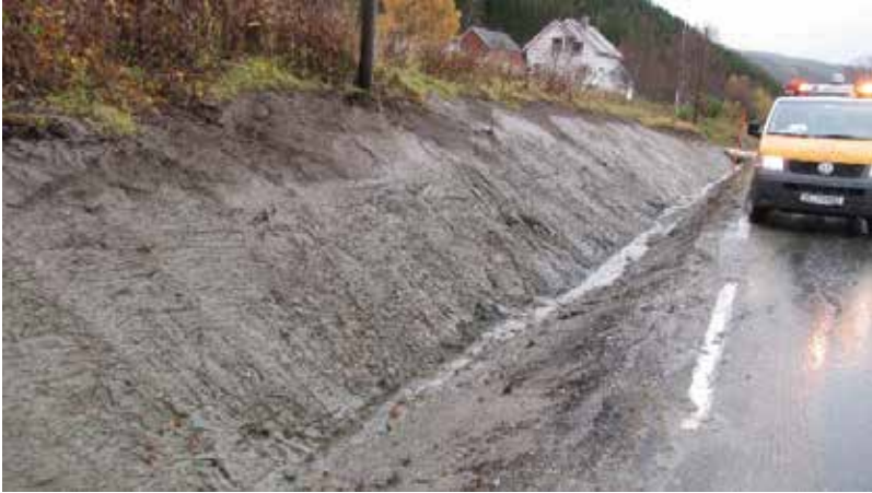
Figur B1.5 Eksempel på at eiendomsgrense ligger så nært vegen at det ikke er plass til god nok helning på skjæringskråning, med påfølgende erosjon og gjentetting av grøfta over tid. (Foto: Per Otto Aursand, Statens vegvesen).
