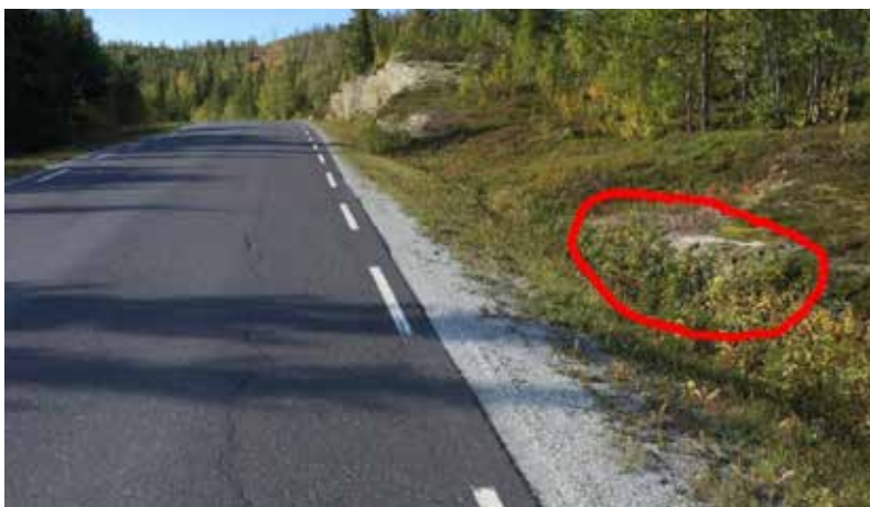
Figur A5.12 Eksempel på grøft med bergnabb som sannsynligvis går inn under vegen, og som leder vann inn i vegoverbygningen og fører til skader på relativt nylagt dekke. (Foto: Per Otto Aursand, Statens vegvesen)
