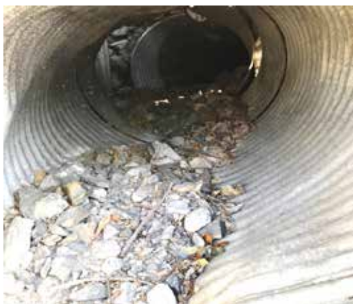
Figur A5.16 Eksempel på stikkrenne som både er skadet, deformert og fylt med sedimenter. (Foto: Per Otto Aursand, Statens vegvesen)
