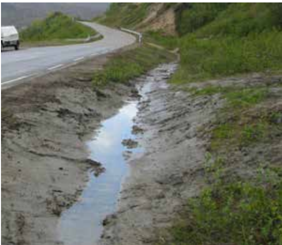
Figur A5.14 Eksempel på manglende fall og terskel/steiner som fører til stillestående vann i grøfta. (Foto: Per Otto Aursand, Statens vegvesen)
