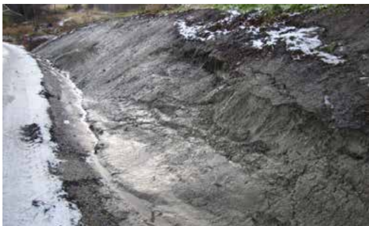
Figur A5.10 Eksempel på erosjon og lokal utglidning etter grøfterensk som tetter grøfta. (Foto: Per Otto Aursand, Statens vegvesen)
