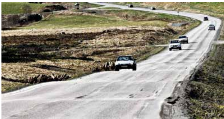
Figur B4.3 Ujevn veg på myr som følge av setninger. (Foto: Trønder-avisa)
