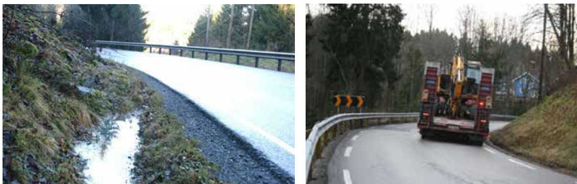
Figur A5.1 Det kan ofte være behov for punktvis utbedring av grøft og grøfteskråning (t. v.). Smal veg, manglende grøft og tunge kjøretøy gir rask nedbrytning av veien (t. h.). [23]
