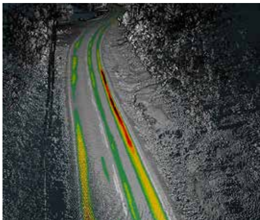
Figur A3.5 Eksempel på bruk av laserdata til å vurdere mulige årsaker til sporutvikling pga. manglende drenering. Midt i bildet sees en bergknaus som sannsynligvis leder vann inn i vegkroppen og forårsaker spordannelse (mørkere farge = dypere spor). [35]
