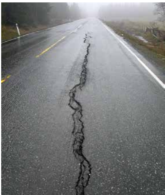
Figur B15.1 Eksempel på telesprekk med behov for tiltak. (Foto: Geir Berntsen, Statens vegvesen)
