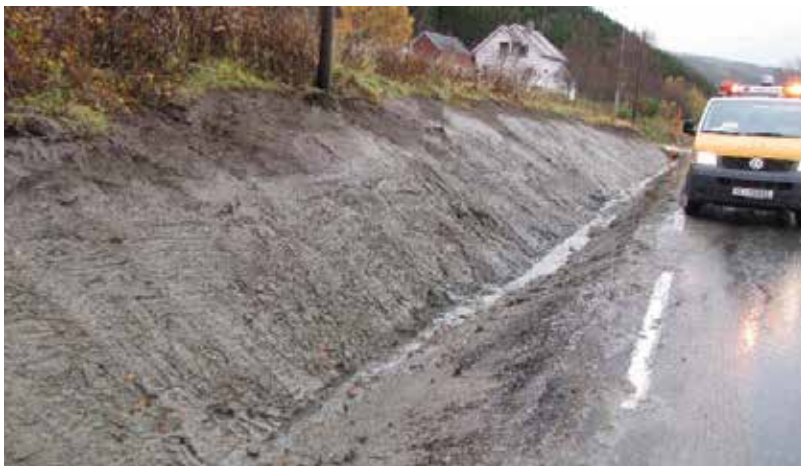
Figur A5.11 Eksempel på at eiendomsgrense ligger så nært vegen at det ikke er plass til god nok helning på skjæringskråning, med påfølgende erosjon og gjentetting av grøft over tid. (Foto: Per Otto Aursand, Statens vegvesen)
