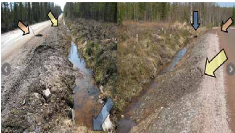
Figur A5.15 Eksempel på tett stikkrenne i avkjørsel som fører til vannrelaterte skader på vegen oppstrøms. [31]
