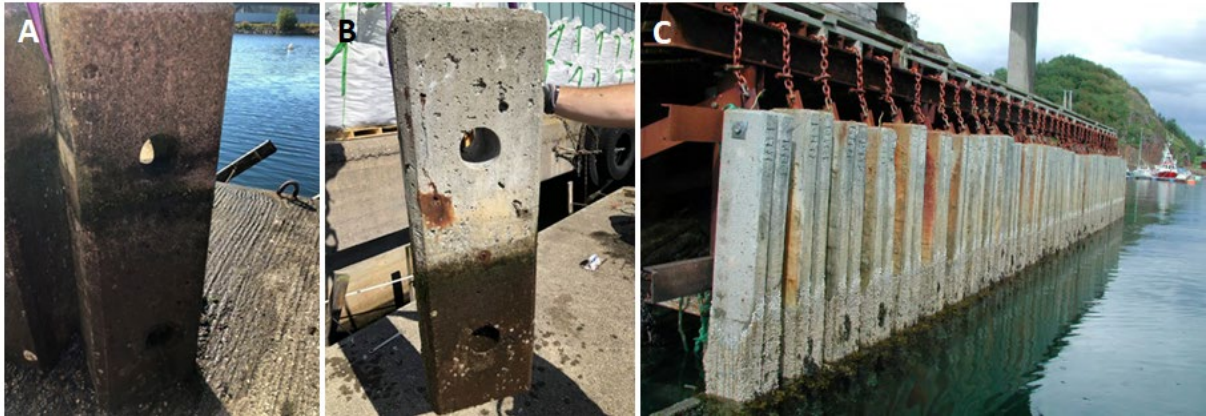
Figur 31: Testprøvene frå Kristiansand (A og B) viste lokalt (B) sporadisk vekst av rur, medan prøvene frå Sandnessjøen (C) var sterkt tilgrodd med rur. Foto: Stig H. Helgestad, Statens vegvesen.
