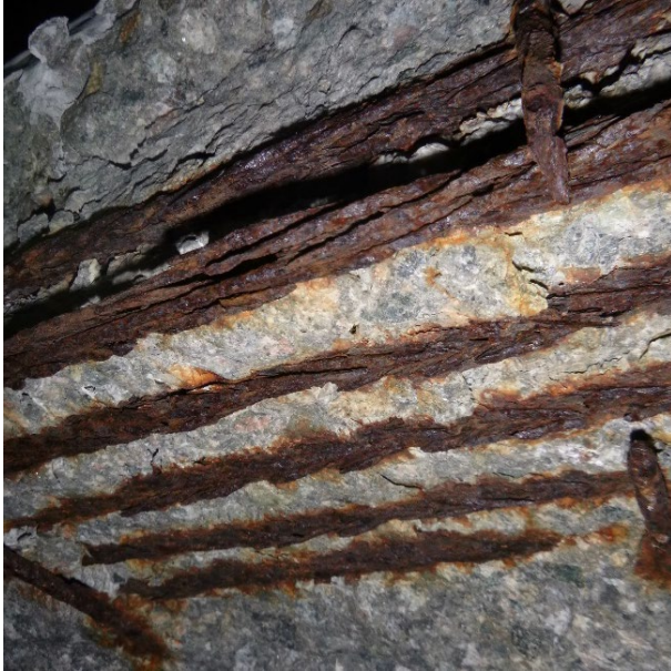
FIGUR 14 KORROSJON I SPENNARMERING I PREFABRIKERT BJELKE. FOTO: M. OSMOLSKA, STATENS VEGVESEN.
