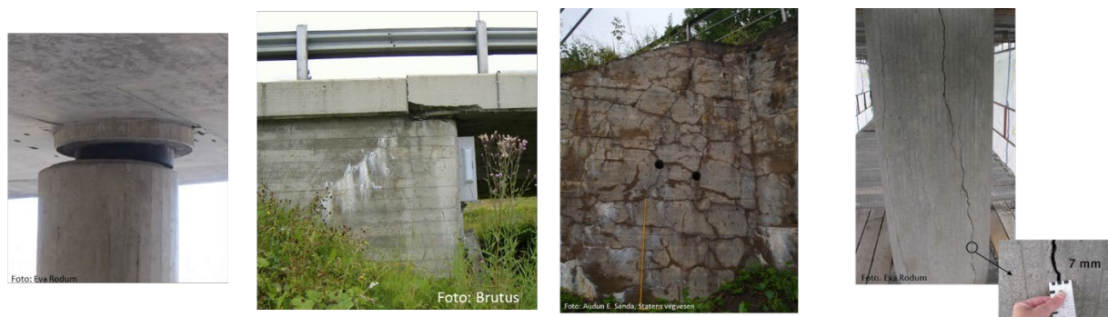
FIGUR 17 TYPISKE SKADER SOM FØLGE AV ALKALIREAKSJONER I BETONG: FORSKYVNINGER, BRUDD, KRAKELERINGSRISS OG RISS PARALLELT MED LASTRETNING
