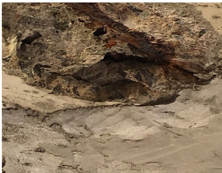
FIGUR 9 - BILDE VISER KORROSJON PÅ ARMERING I KANT MED REPARERT OMRÅDE. EIDE BRU I ROGALAND. FOTO SVV.
