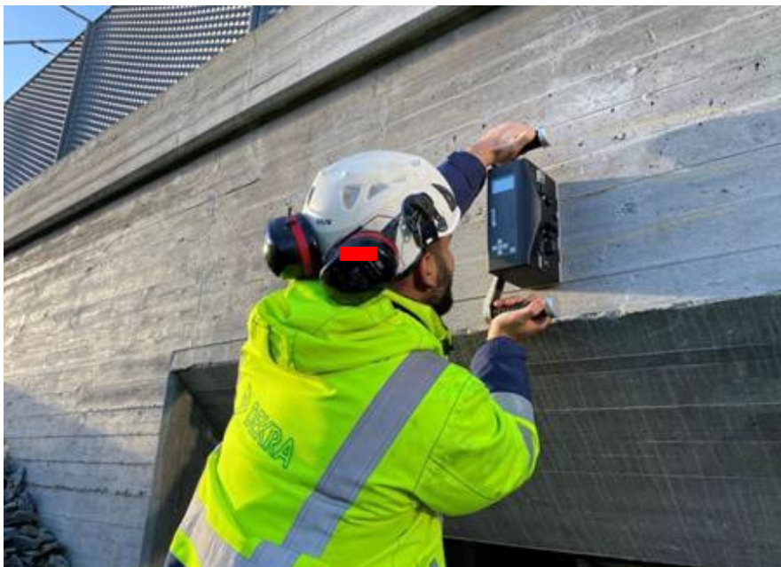
FIGUR 12 LOKALISERING AV HULROM I KABELKANALER MED ULTRALYD. FOTO: DEKRA INDUSTRIAL AB.
