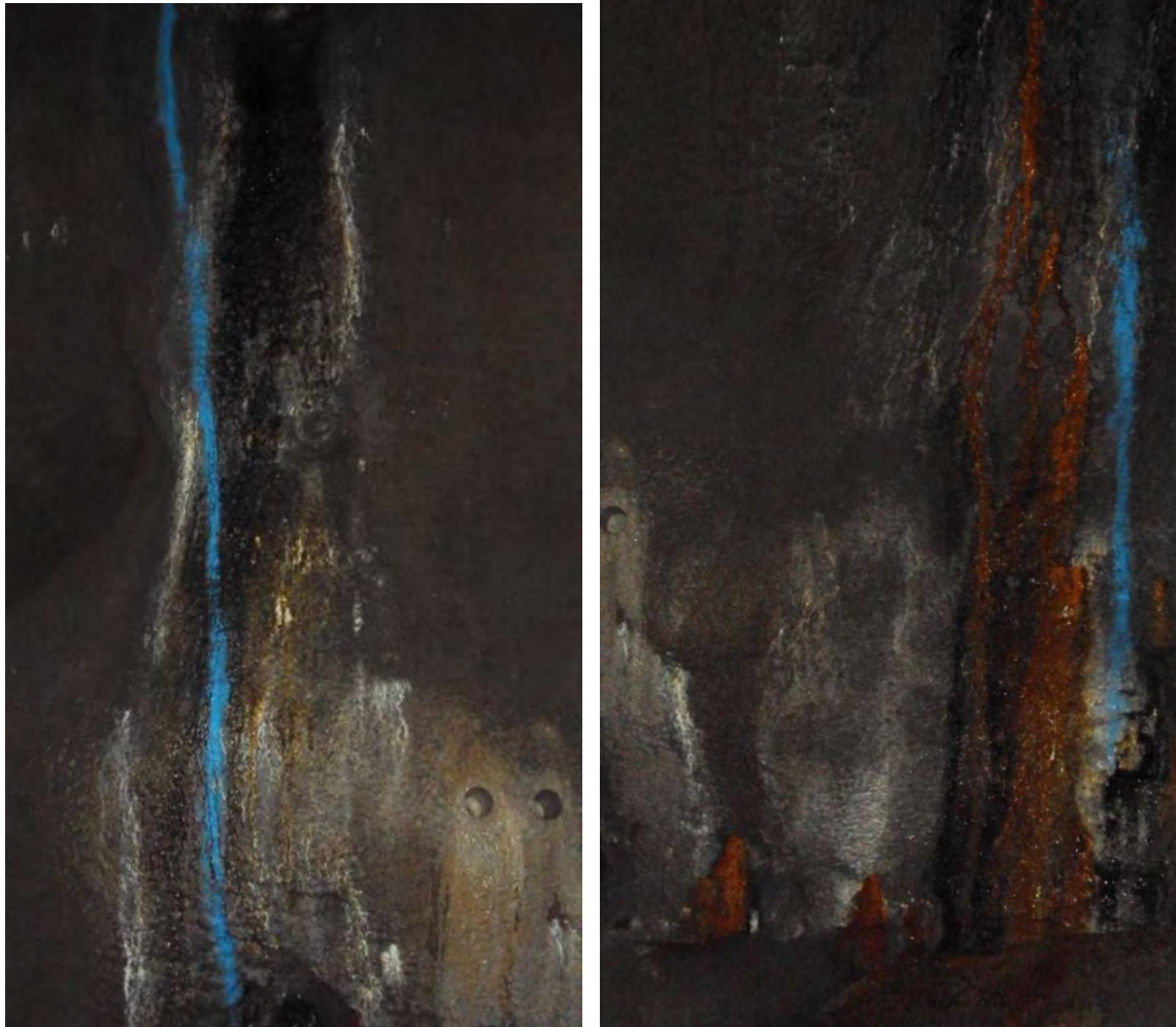
V12.2. Felt 2 i mai 2010 (første borehola er synlege). Venstre foto mot Felt 3 og høgre foto mot Felt 1 (grensene mellom felta er indikert med blå farge). Kjernene frå 2015 blei bora ut frå rusta biofilm midt på venstre bildet og frå grå overflatefuktig betong utanfor (sjå V13.2). Kjerneuttak i 2010 var frå grå overflatefuktig betong utan biofilm utført med tanke på å analysere for initialeigenskapane (sjå Vedlegg 6). Foto: Per Hagelia.
