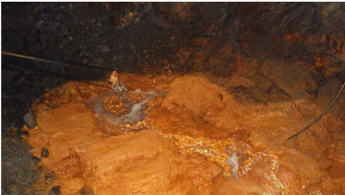
V12.15. Grøft A med tilførsel av lekkasjevatn i mars 2017 («RørA»). Svært stort innhold av brun-oransje biofilm. Foto: Per Hagelia.
