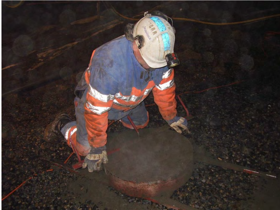
V4.2. Avtrekking av plateprøve straks etter sprøyting i sirkulær plateform (Ø600 mm x 100 mm), utført i samsvar med krav i Norsk Betongforening – Publikasjon nr 7. Foto: Reidar Kompen.
