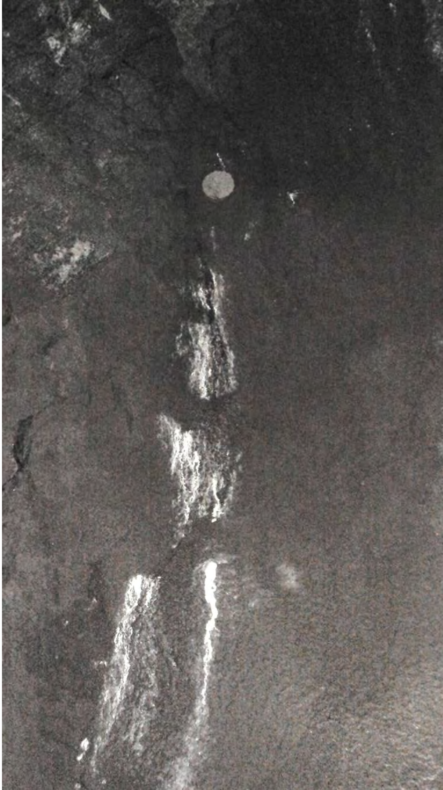
V12.3. Felt 3 utan biofilm i mai 2010 med lokale utfellingar av kalsitt og brucitt og fuktig overflate. Det blei bora gjennom sprøytebetongen i hop om å få etablert lekkasjar med biofilm på overflata, men var ikkje vellykka. Området endra seg ikkje særleg merkbart fram til 2020. Områder med kjerneuttak er vist i Vedlegg 6 og Vedlegg 13. Foto: Per Hagelia.
