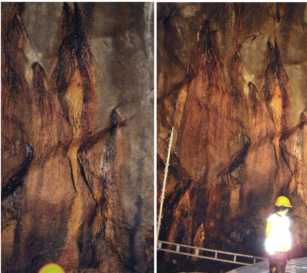
Figur 2: Tilstand før etablering av testfeltet (2010). Nedbryting av opphavleg sprøytebetong under Mn og Fe rik biofilm. Tørrare område var tilsynelatande intakte. Den 11 år gamle stålfiberarmerte sprøytebetongen blei meisla bort før etableringa av tre testfelt for sprøytebetong. Foto: Reidar Kompen.
