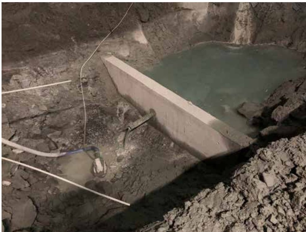
Figur 6.14 Eksempel på operativ måleterstel fra E39 Lyshorntunnelen (Foto: T. Kirkeby)
