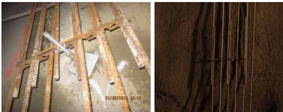
Figur 6.22 Skjøting av armering. I bildet til venstre ligger armeringen for tett grunnet for mange skjøter i samme område. Bildet til høyre viser riktig skjøting. (Foto: T. Kirkeby)
