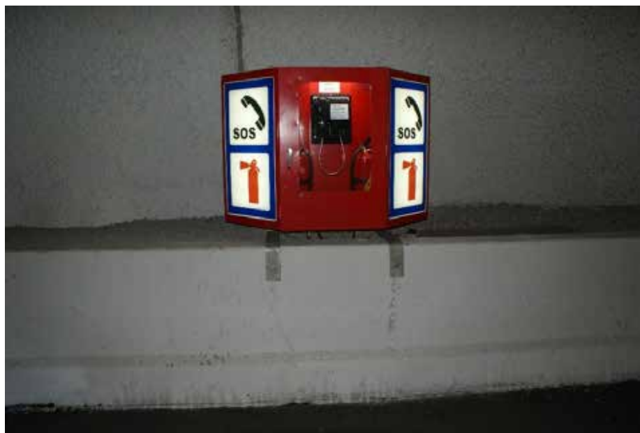
Figur 4.1 Eksempel på nødstasjon plassert på føringskant. Skilt for brannslukker og telefon er her innfelt som del av nødstasjonen. (Foto: T.Braaten)
