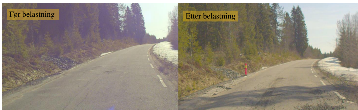
Figur 55 Skader i området ca. 2600
