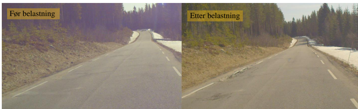
Figur 56 Skader i området ca. 3000
