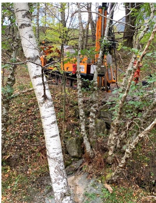
Figur 14 Bilde viser boreriggen plassert på borhull 4014 og grunnvann som strømmer ut fra steinfyllingen etter punkteringen.
