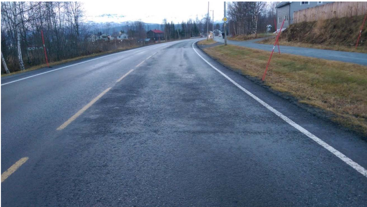
Bilde 1: Kald asfalt fra avslutning av båtlast gir ofte dårlig kvalitet på utlagt asfaltdekke.
