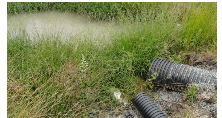
Utløpsrør til resipient.
