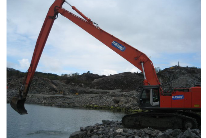
Gravemaskin med lang gravearm som når langt ut i dammen. Hære maskin.no
