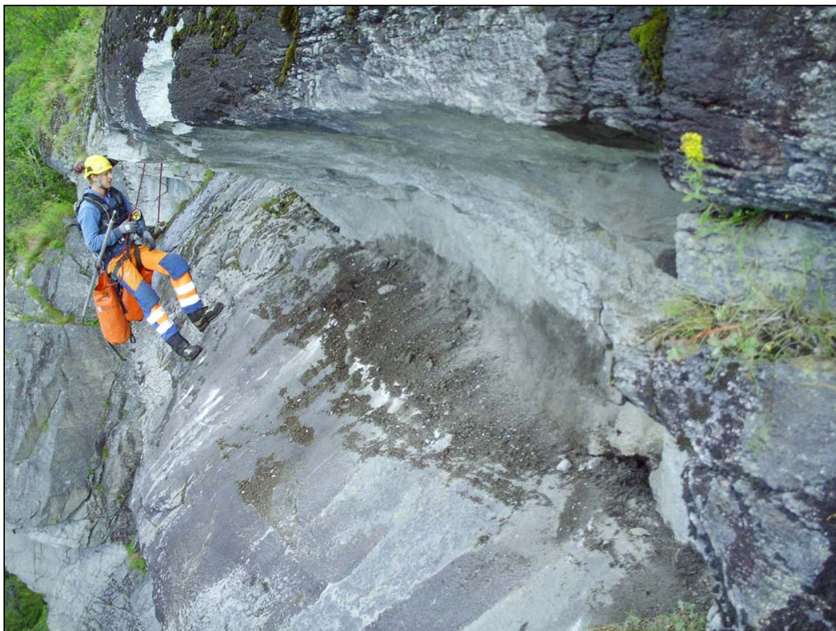
Figur 16: Inspeksjon etter vellykket utsprengning av sprekkeavløst fjellblokk "C5-1 (2)", jfr. fig. 14 (foto: Betongrenovering).
