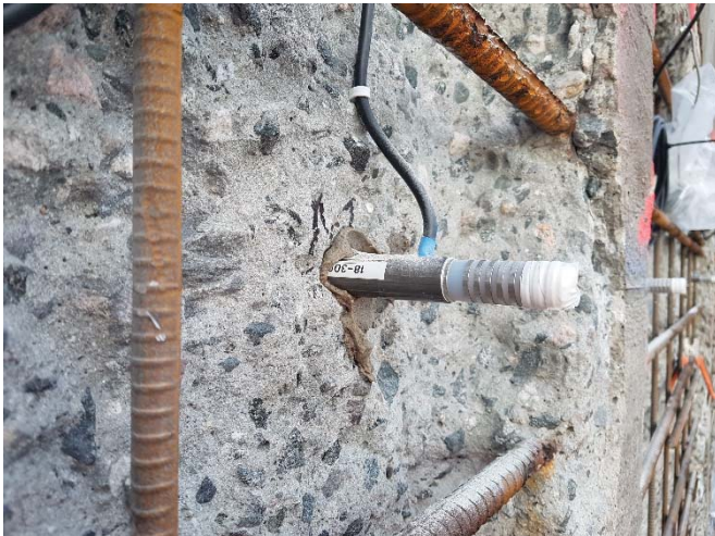
MRE installert og klargjort til innsprøyting i Reparasjons-mørtel, øvre ringer er beskyttet for seinere å bli sprøytet inn i KB-mørtel.
