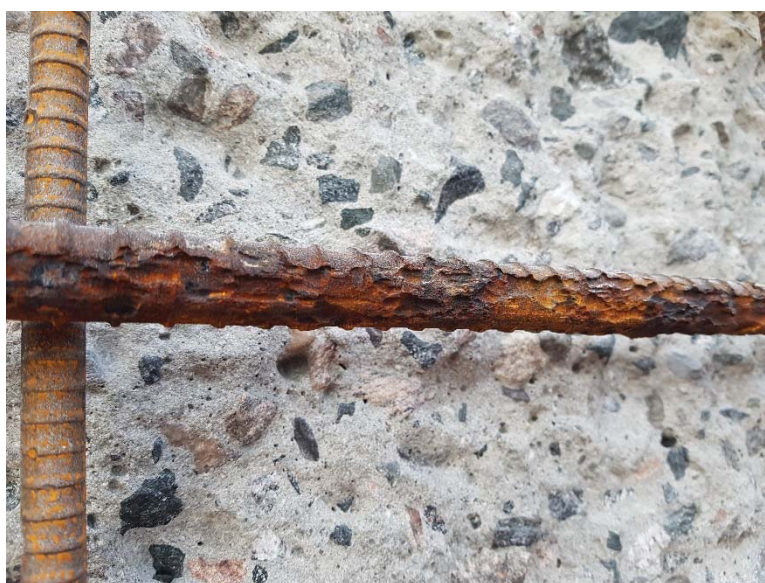
Figur 7 – Korrodert armering på nordsiden av forankringspilaren.
