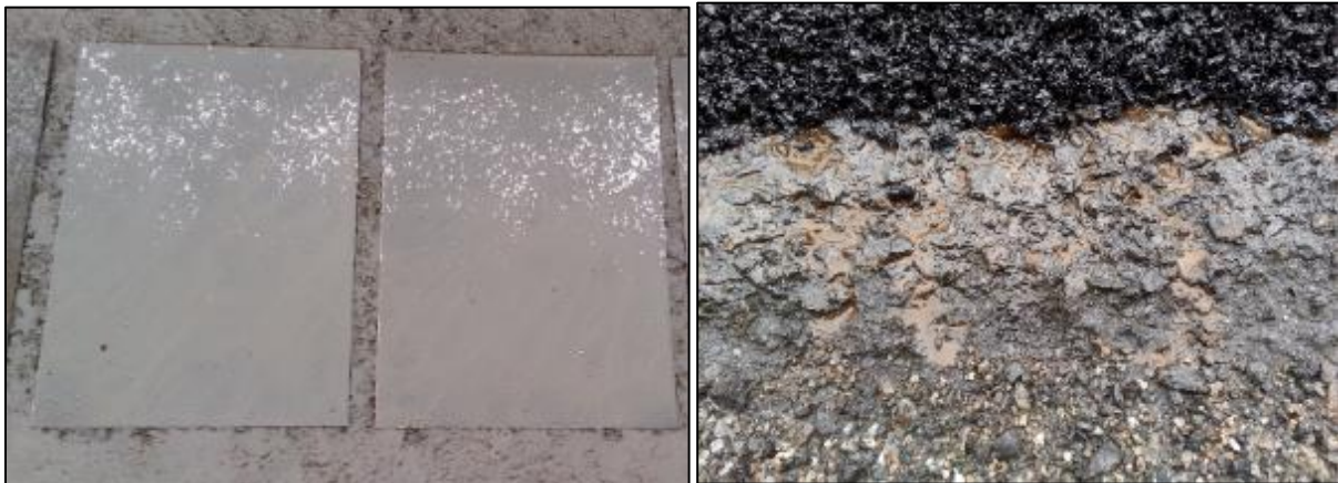
Figur 34 Bildet til venstre viser to av prøveplatene etter at emulsjonen er påført. Bildet til høyre viser hvordan brun ubrutt emulsjon renner ned langs kanten av veggen etter at asfalten er lagt. Veggen var rimelig flat, og omfanget av denne avrenningen var begrenset.
