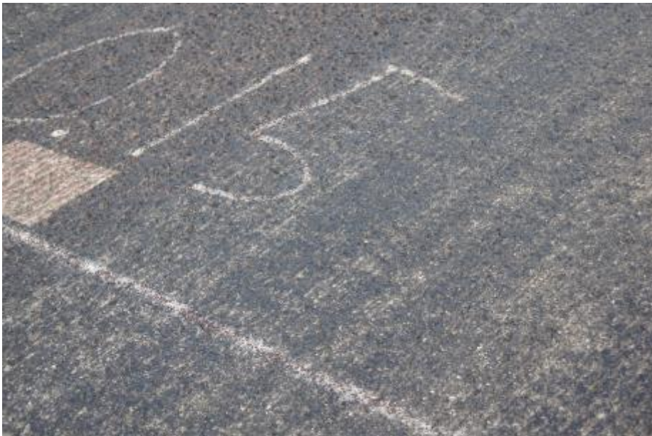
Figur 22 Bildet viser ett eksempel på hvordan det kan se ut når mengden er så lav at dysene ikke gir tilstrekkelig overlapp, og spredningen blir ujevn. Her var det planlagt å lime med 0,15 liter emulsjon per m 2 , men målt verdi viste at det ble 0,073 liter emulsjon per m 2 . Underlaget her er frest. Denne strekningen ble forkastet og inngår ikke i datasettene.
