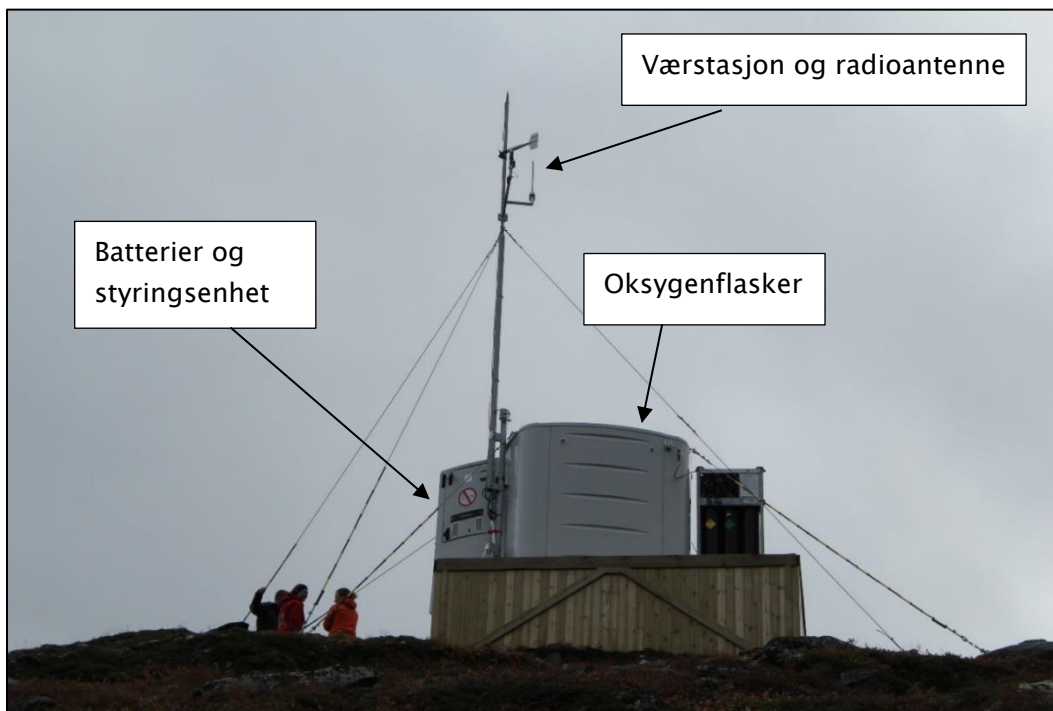
Figur 5: Hovedsentral (Foto: Ole-André Helgaas, Statens vegvesen).
