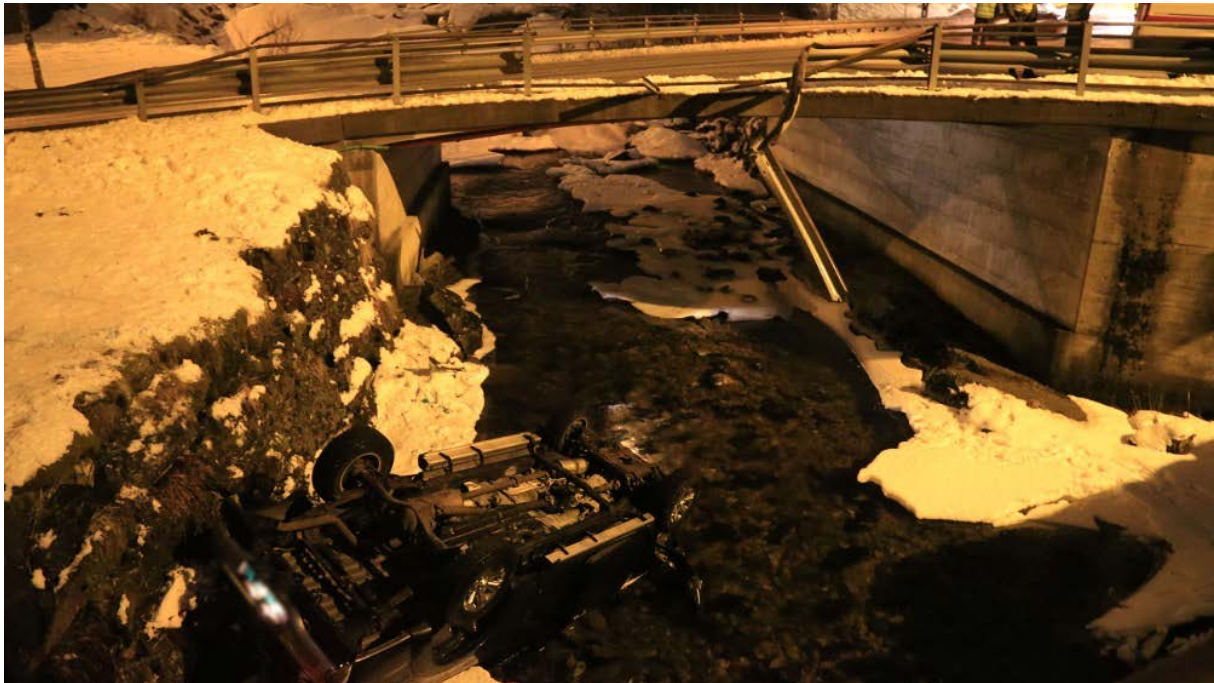
Figur 16 Bildet viser rekkverk som gav etter og bil havnet i elven opp ned.
