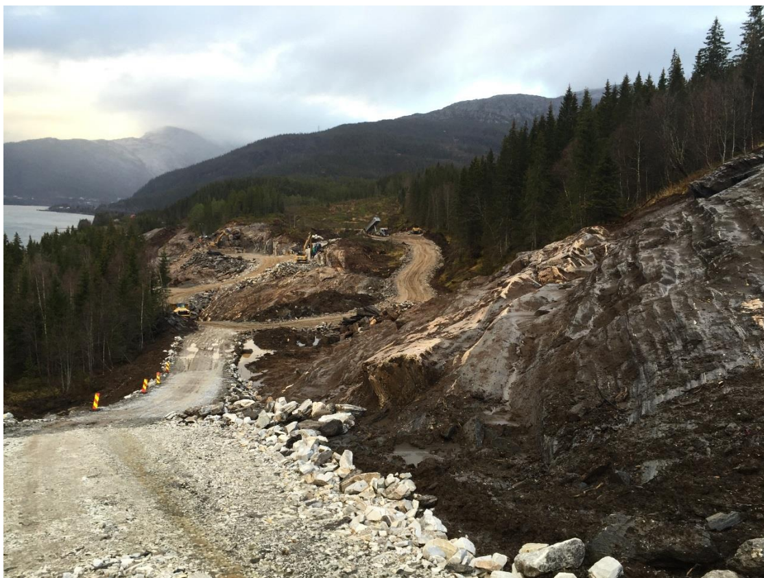
Figur 1 Ny veg under bygging, E6 Helgeland nord. Bildet illustrerer hvordan en veglinje bryter grunnvannets og overflatevannets strømningsmønster når jordlagene graves bort. Foto NGI
