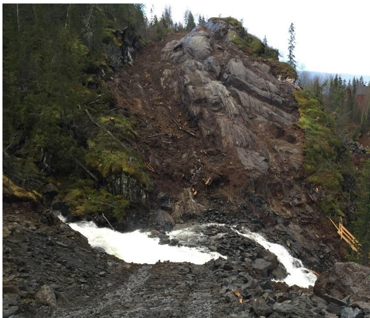
Figur 2 Vann som ukontrollert krysser anleggsområdet. Foto NGI.
