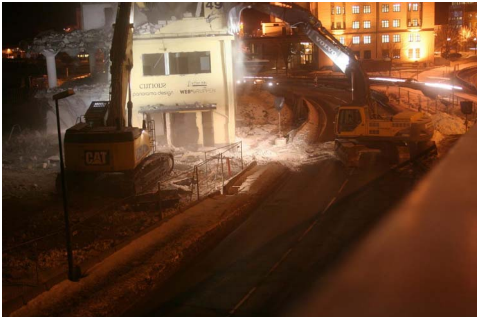
9.3.2010- Havneveien stenges og arbeidet med riving starter på denne siden på nattestid.
