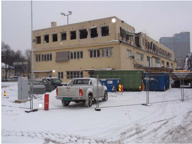
17.2.2010- Containere med ulikt avfall i forkant. Rivningen startet med å ta hull i tak og vegger på sjøsiden.
