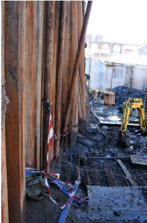
Lokal deformasjon av spunten
