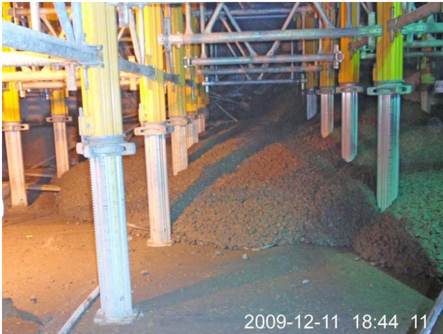
Ikke alt gikk bra: Forskalingen holdt ikke balastbetongen.
