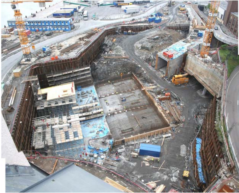
25.5.2016: Stillaset begynner å reise seg. Bygging av vegger og dekke for fire kjørefelt i hver retning.
