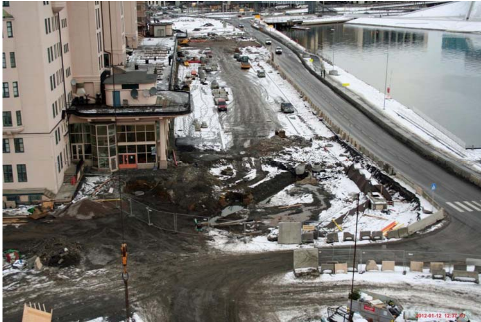
12.1.2012 Grøft for VA- anlegg gravd ut fra kum med kjele montert og på tvers av vegen.
