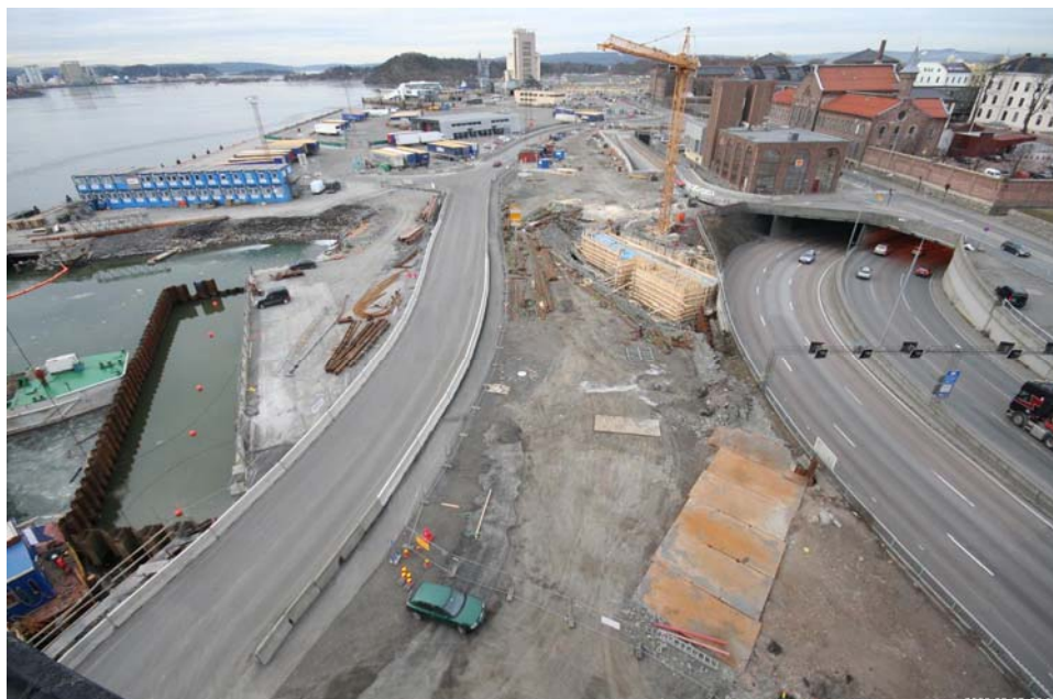
7.3.2008 Spunten fjernes. Det klargjøres for at første senketunnelelement skal komme på plass. Arbeidet er ferdigstilt, og det blir en pause til neste fase begynner.
