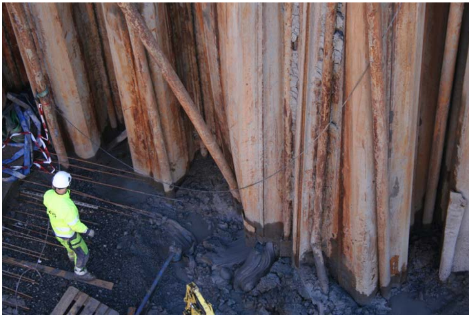
En fotbolt hadde gått i brudd, spunten deformerte seg lokalt og massene bak spunten tøyte inn.
