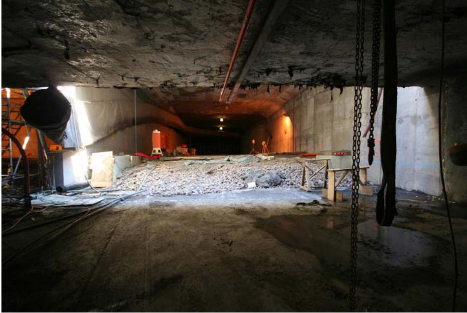
2008 08 25 Grensesnittet mellom Festningstunnelen og senketunnelen. Fotografen står i Festningstunnelen og ser østover.
