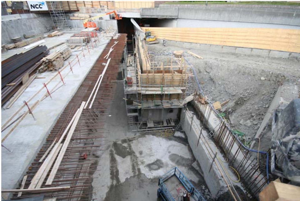
2010 05 26 Forskaling av vannbeskyttelsesvegg. Det er en tett barriere for at ikke vannet skal komme inn. Det er dobbel sikring mot trafikken - spunt og betongvegg.
