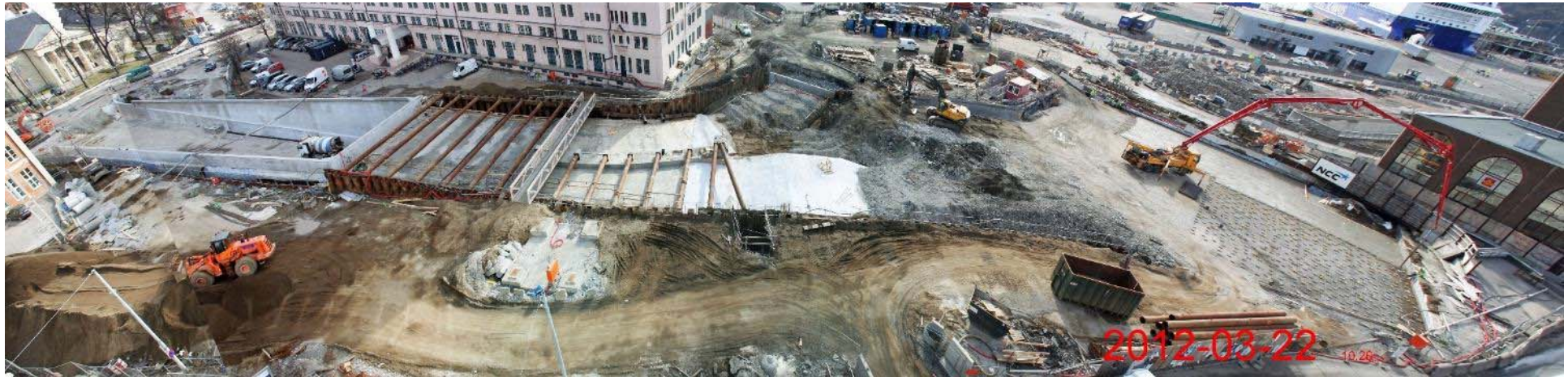
2012 03 22: Tilbakefylling og fortløpende fjerning av stivere i byggegrop 2. Støping av plate som skal sikre at ikke massene over kulverten blir avgravid. Sikring mot oppdrift.
