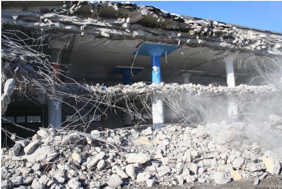
4.3.2010- Betongen i dekkene gnages i stykker fram til neste søylerad
