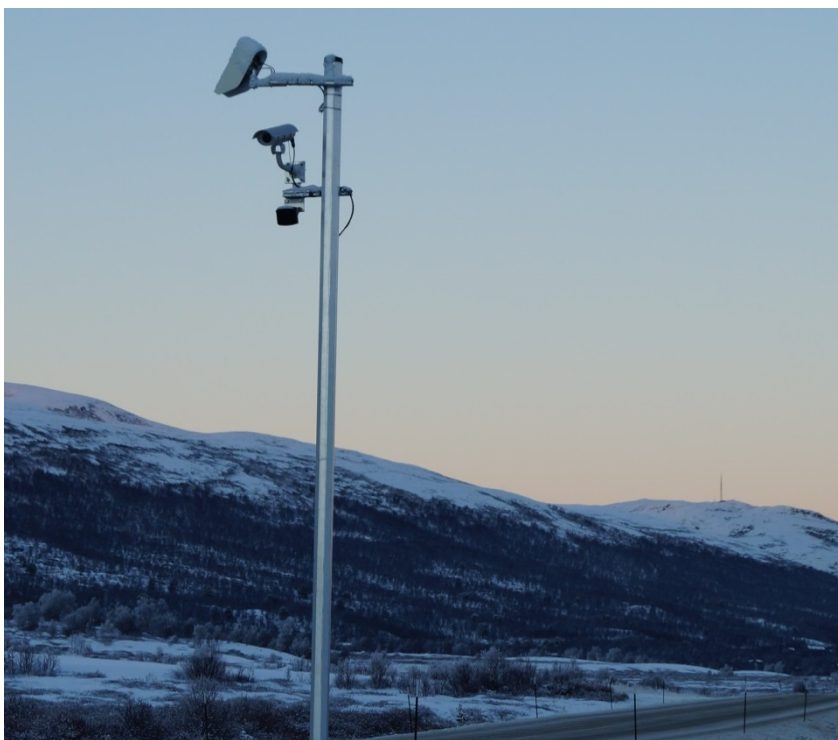
Figur 9 Vaisala DSC111 montert på værstasjon på Avsjøen.
