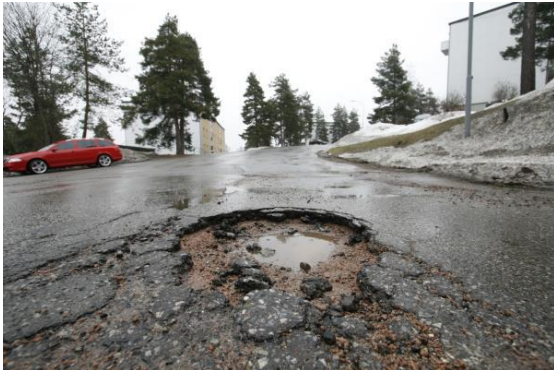
Figur 14.17 Slaghull i asfaltdekke. (Foto: Drammens Tidende)
