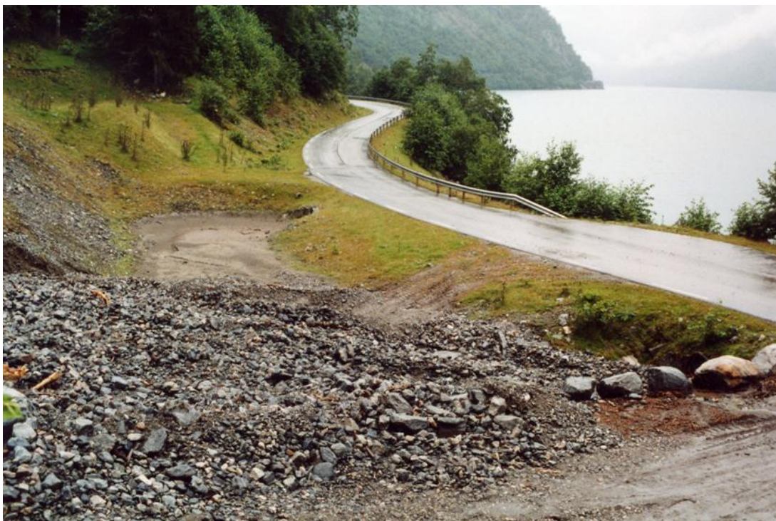
Figur 22.21 Sedimentasjonsbasseng på innsiden av veien. På siden av hovedskredløpet er det utformet en alternativ dreinsveg. Fv. 192 Eikesdalen, Møre og Romsdal. (Foto: Harald Norem)
