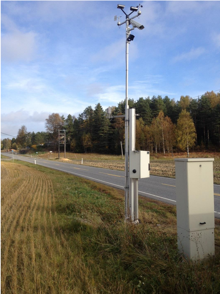
Figur 20.8 Værstasjon /1/ (Foto: Statens vegvesen)
