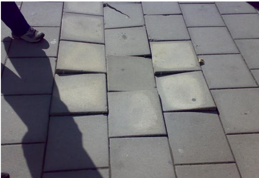
Figur 23.1 Fundamentet til betonghellene har sviktet på et område Foto: Terje Lindland
