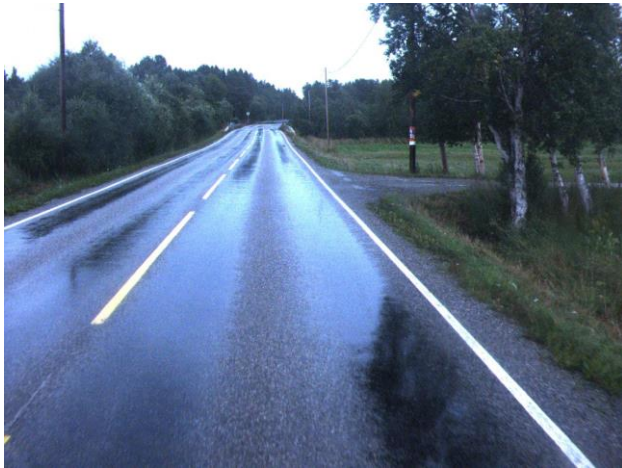
Figur 12.28 Eksempel på dekke hvor det er betydelig glattere i spor enn mellom spor.
