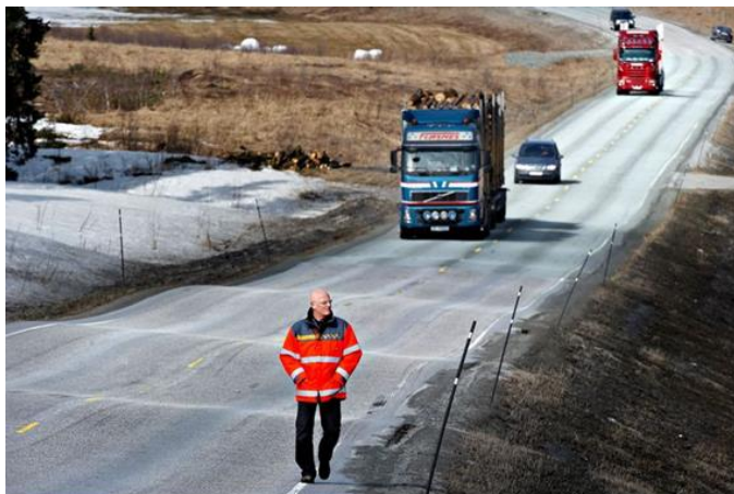
Figur 14.13 Ujevne grunn- og teleforhold kan forårsake store ujevnheter. (Foto: Trønder-Avisa)
