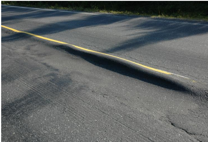
Figur 10.5 Eksempel på asfaltdeformasjon på E6 i Nordland (Foto: Inge Hoff)
