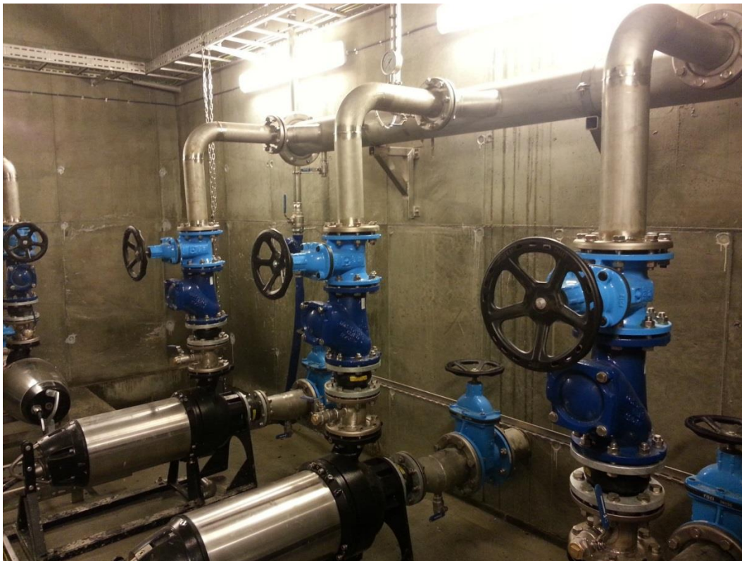
Figur 17.5: Pumpeanlegg i tunnel, Foto: Statens Vegvesen.
