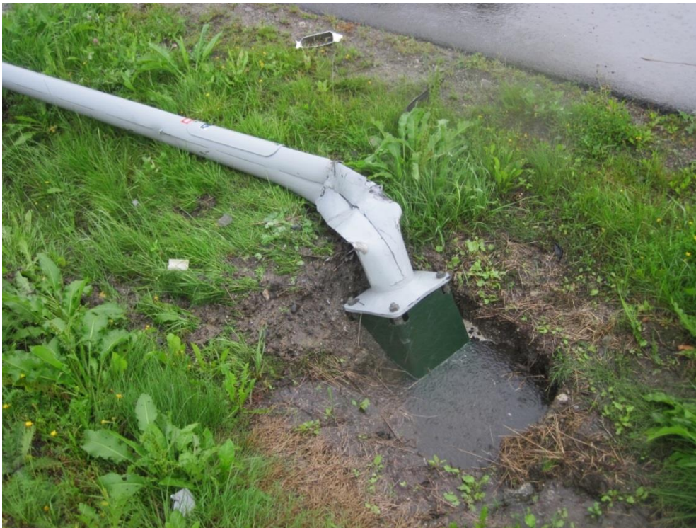
Figur 17.3: Eksempel på skadested, Foto: Statens Vegvesen.
