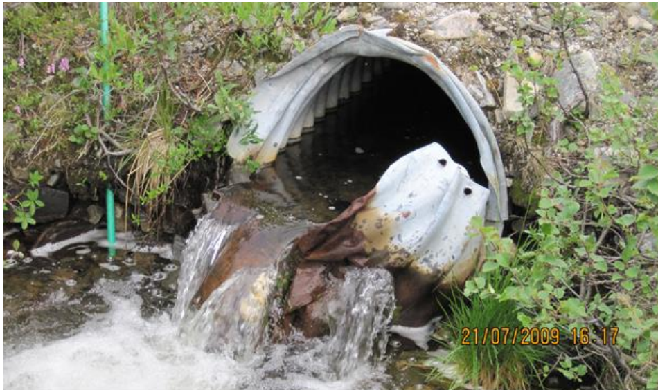
Figur 5.4 Skadet kulvert som kan hindre fiskevandring. (Foto: Statens vegvesen)
