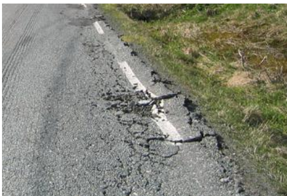
Figur 10.8 Typisk kantskade med deformert skulder (Foto fra Roadex.org)
