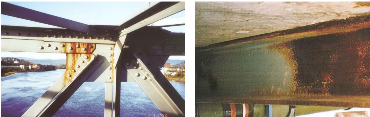
Figur 19.3 Lokal korrosjon i fagverksknutepunkt og overflatekorrosjon på stålbejelke (Foto: Håndbok V441)
