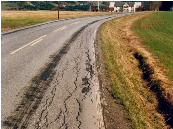
Figur 14.18 Nedkjørt vegkant; deformert skulder og langsgående oppsprekking. (Foto: Jostein Aksnes)
