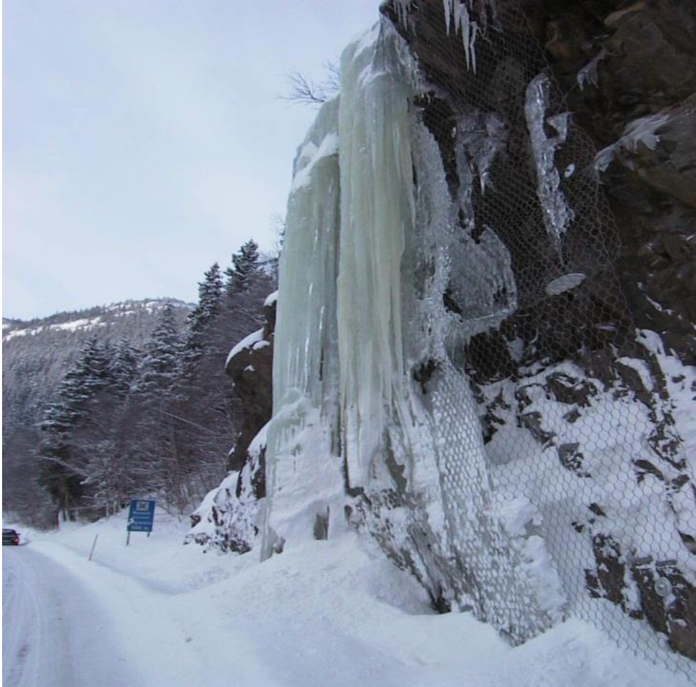
Figur 22.23 Issikringsnett brukt til å armere isen fast i skjæringen. (Foto: Audun Langelid)
