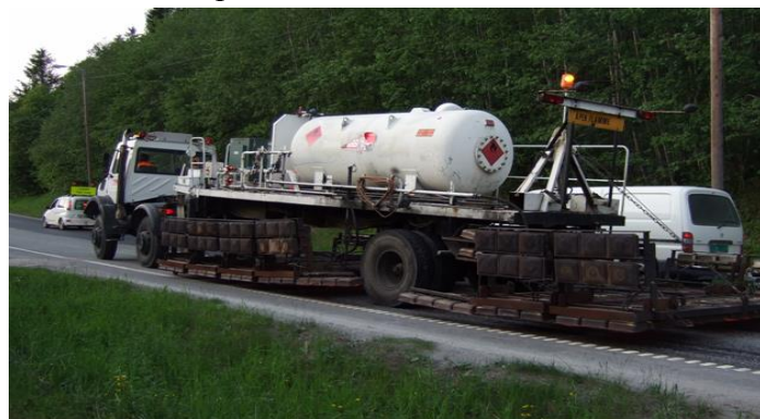
Figur 14.30 Propanheater er vanligvis første prosess i varm gjenvinning på veg. (Foto: Statens vegvesen)
