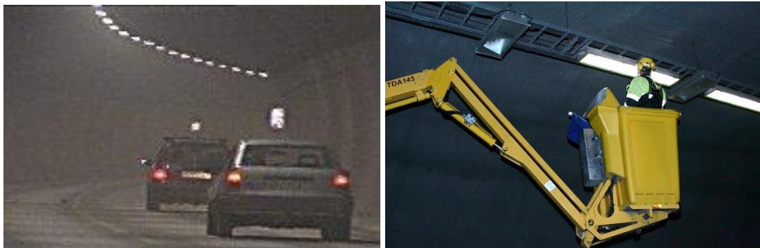
Figur 18.3 Svevestøv ødelegger synsforholdene. Til høyre: Armaturene må holdes reine (Foto: Trond Larsen)
