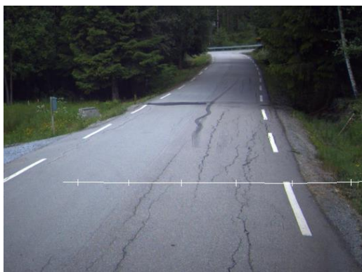
Figur 8.7 Sprekker i asfaltdekke (Foto fra ViaPhoto, Statens vegvesen)
