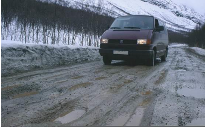
Figur 8.4 Fremkommelighetsproblem i teleløsningen (Foto: Kjell Robertsen, Svv Region Nord)
