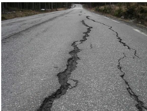
Figur 14.14 Langsgående telesprekker. (Foto: Statens vegvesen)
