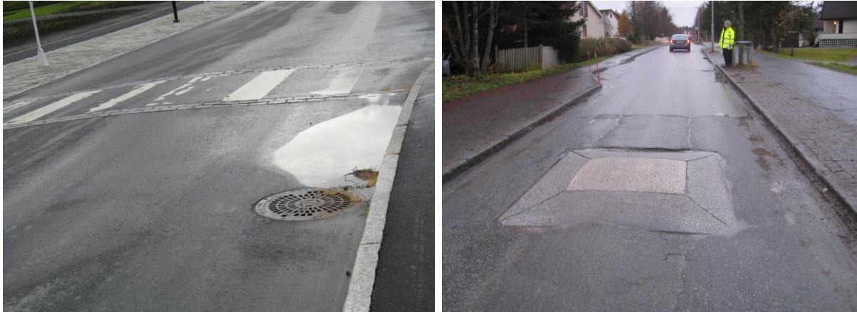
Figur 24.6 Opphøyd gangfelt med feilplassert sluk. Til høyre fartspute. (Foto: Øystein Larsen)
