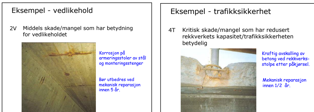
Figur 19.11 Eksempler på vurdering og klassifisering av skader på betong, med angivelse av skadegrad og skadekonsekvens (fra skadekatalogen i Håndbok V441)
