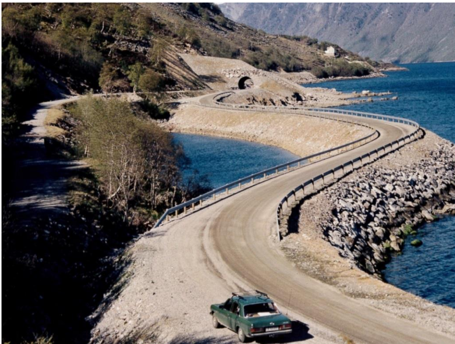
Figur 22.9 Utlegging av veg på sjøfylling. Fv. 65 Hjørundfjorden, Møre og Romsdal. (Foto: Harald Norem)
