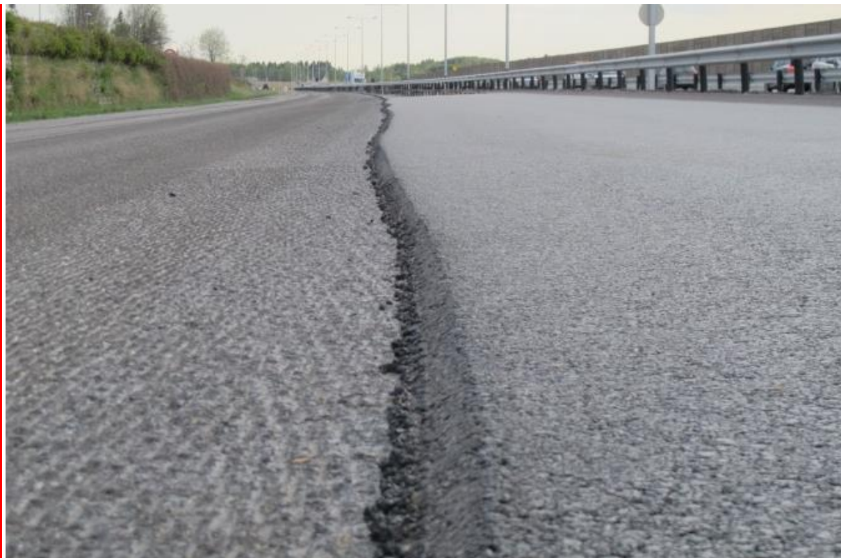
Feil: Ujevn asfaltkant (foto: Frode Malmstrøm)
