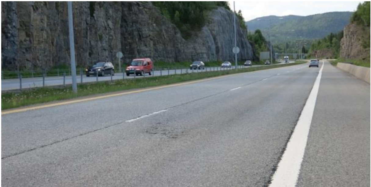
Konsekvens: Svakheter fra stopp i utlegging eller kald masse i lass-bytter, fremkommer som skader i overflaten etter noen år og medfører redusert dekkelevetid (foto: Roar Telle)
