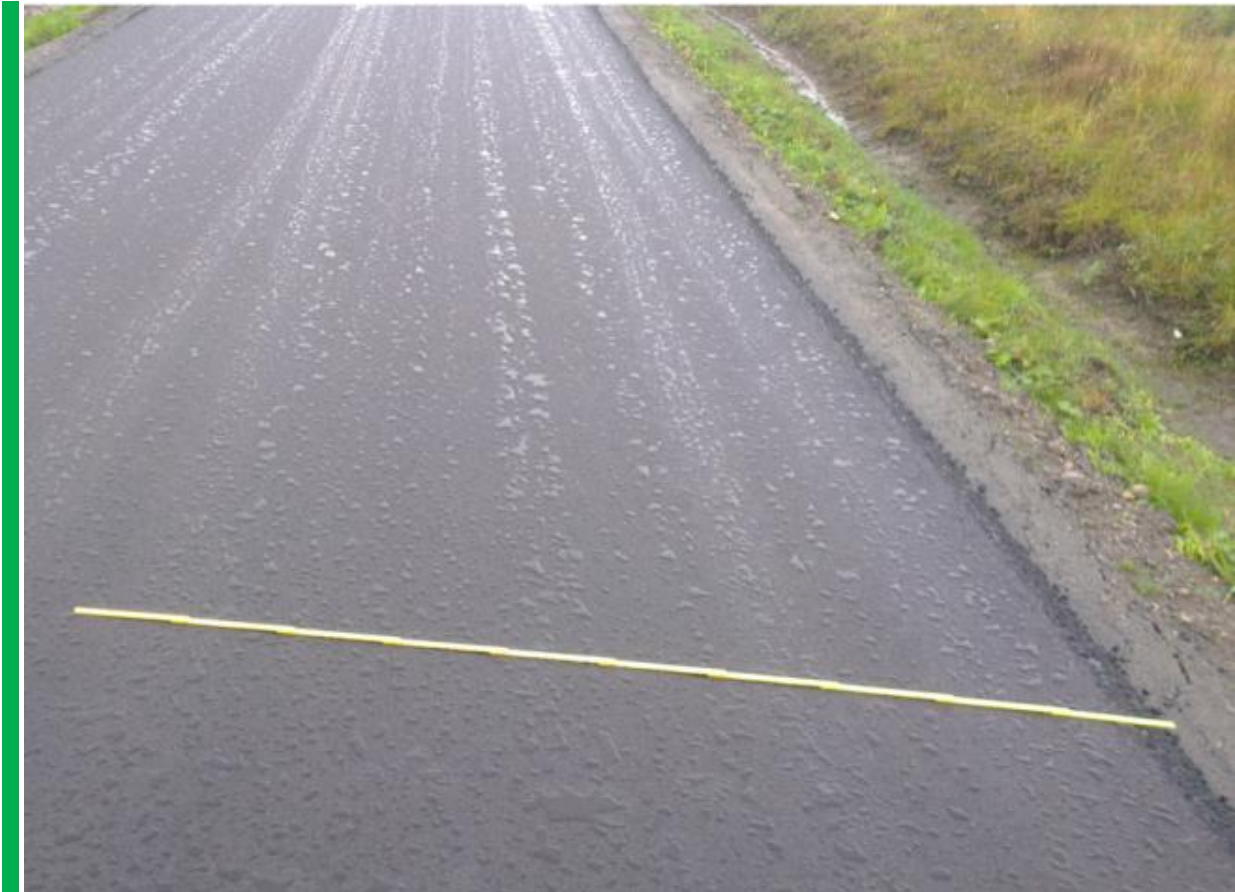
Riktig: God utførelse, homogent asfaltdekke (foto: Jan Sundstrøm)
