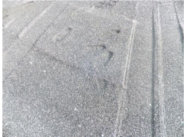
Feil: Avrettingen er dårlig komprimert (foto: Terje Herberg)
