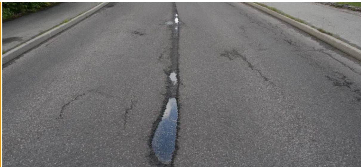
Konsekvens: Kombinasjon av dårlig klebing og dårlig utført skjøt (foto: Roar Telle)
