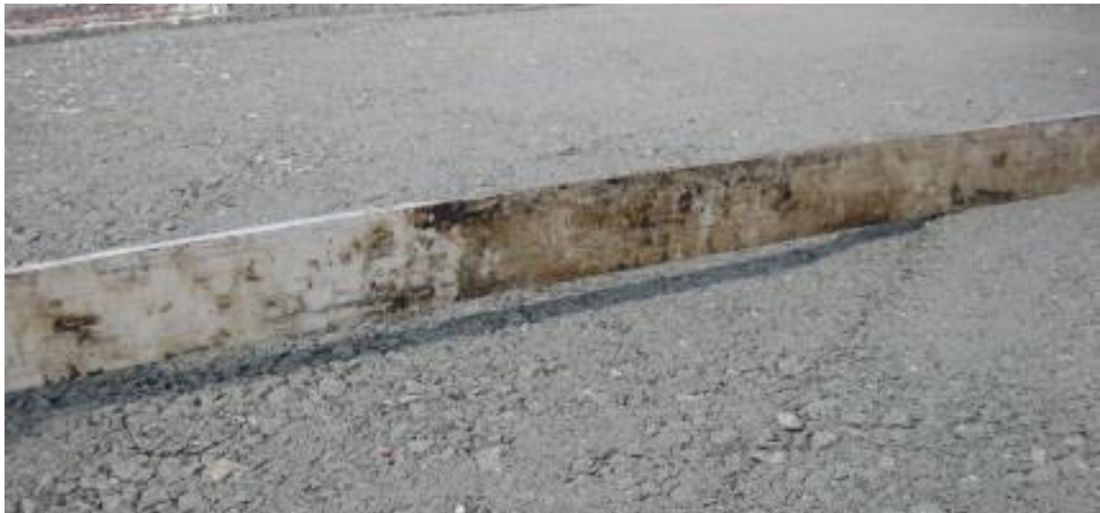
Feil: Avrettingen er ujevn (foto: Terje Herberg)
