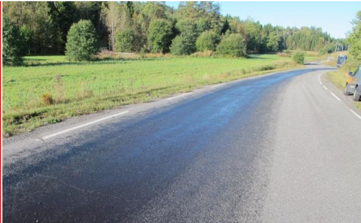
Feil: Hele arealet som skal asfalteres må klebes med riktig mengde emulsjon (foto: Frode Malmstrøm)
