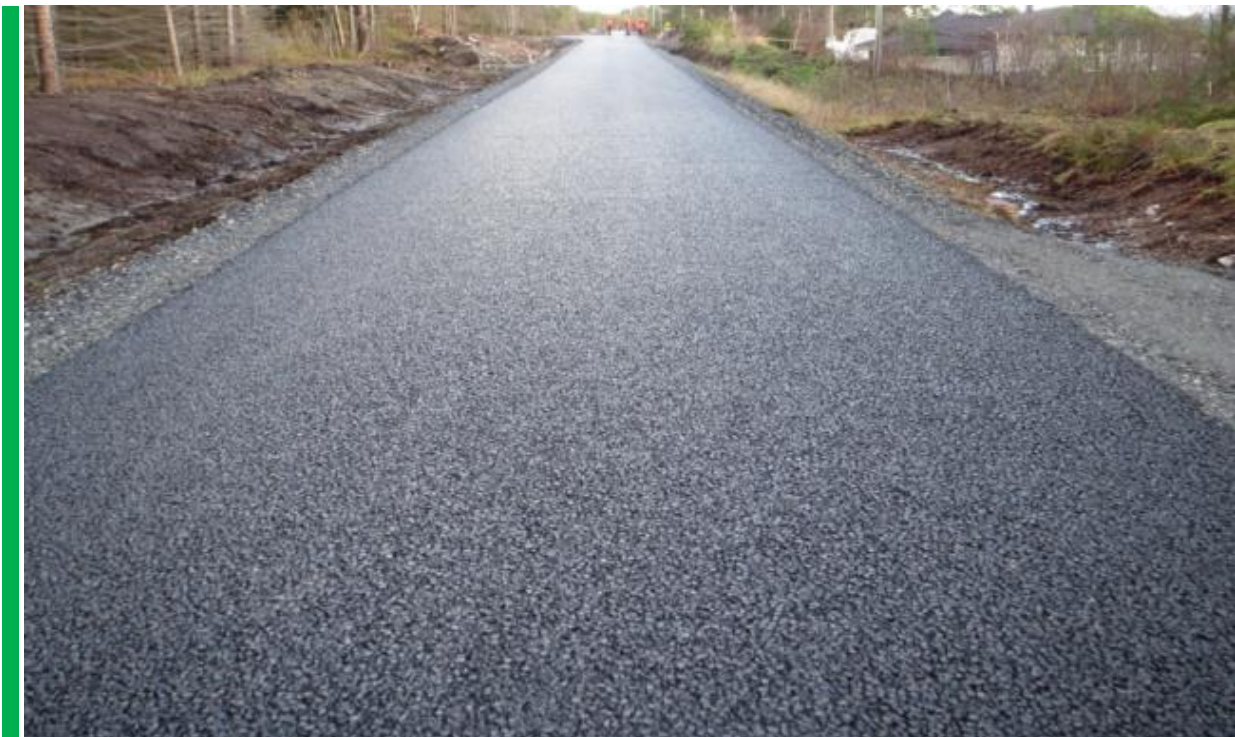
Riktig: God utførelse, homogent asfaltdekke (foto: Jan Sundstrøm)
