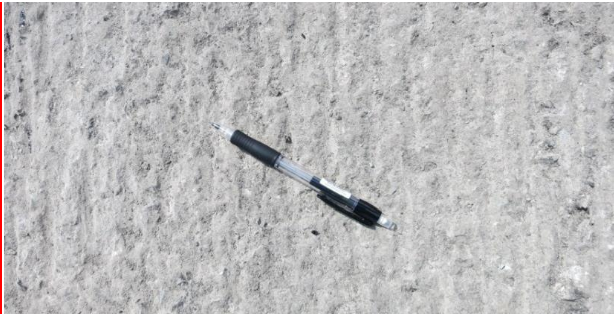
Feil: Frest underlag med støvbelegg (foto: Roar Telle)
