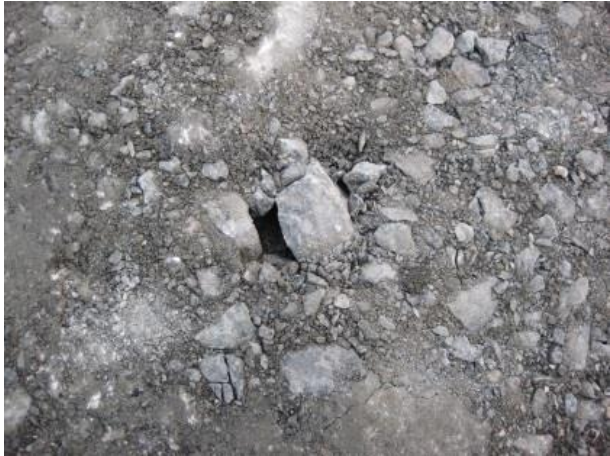
Feil: Underlaget er inhomogent med stort hulrom (foto: Terje Herberg)
