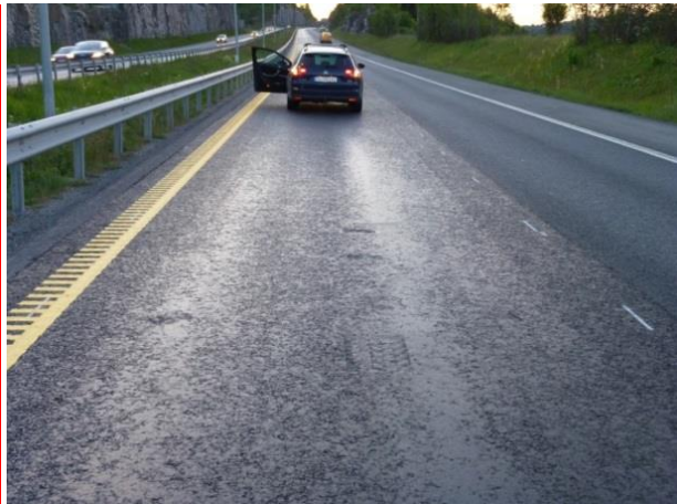
Feil i sammensetningen av asfaltmassen kan gi blødning og ustabilitet på veien (foto: Roar Telle)
