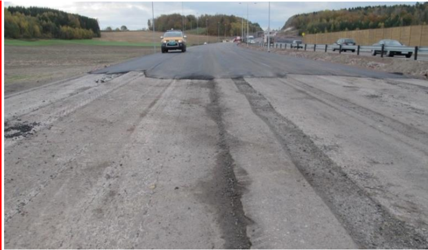
Feil: Dårlig rengjort og manglende klebing til underlaget (foto: Frode Malmstrøm)
