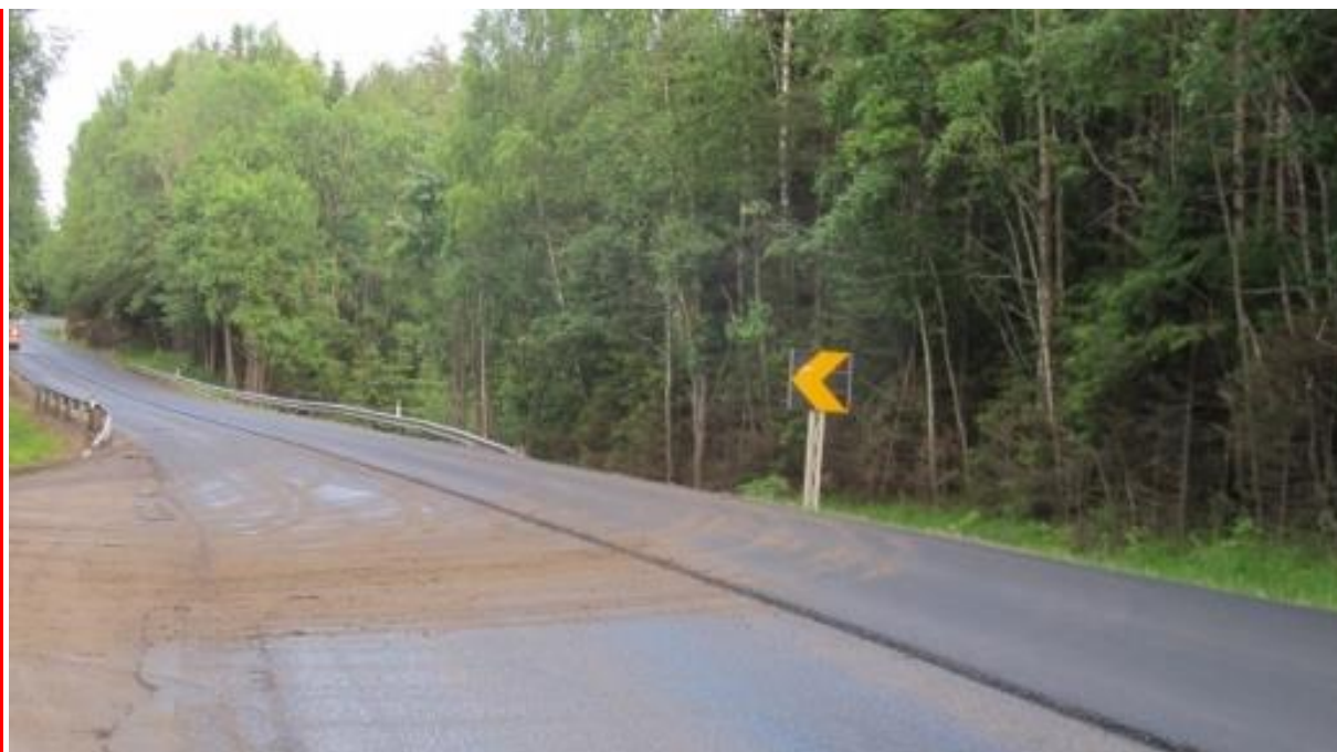
Feil: Tilgrising av klebet areal gir dårlig heft mellom asfaltlagene (foto: Frode Malmstrøm)
