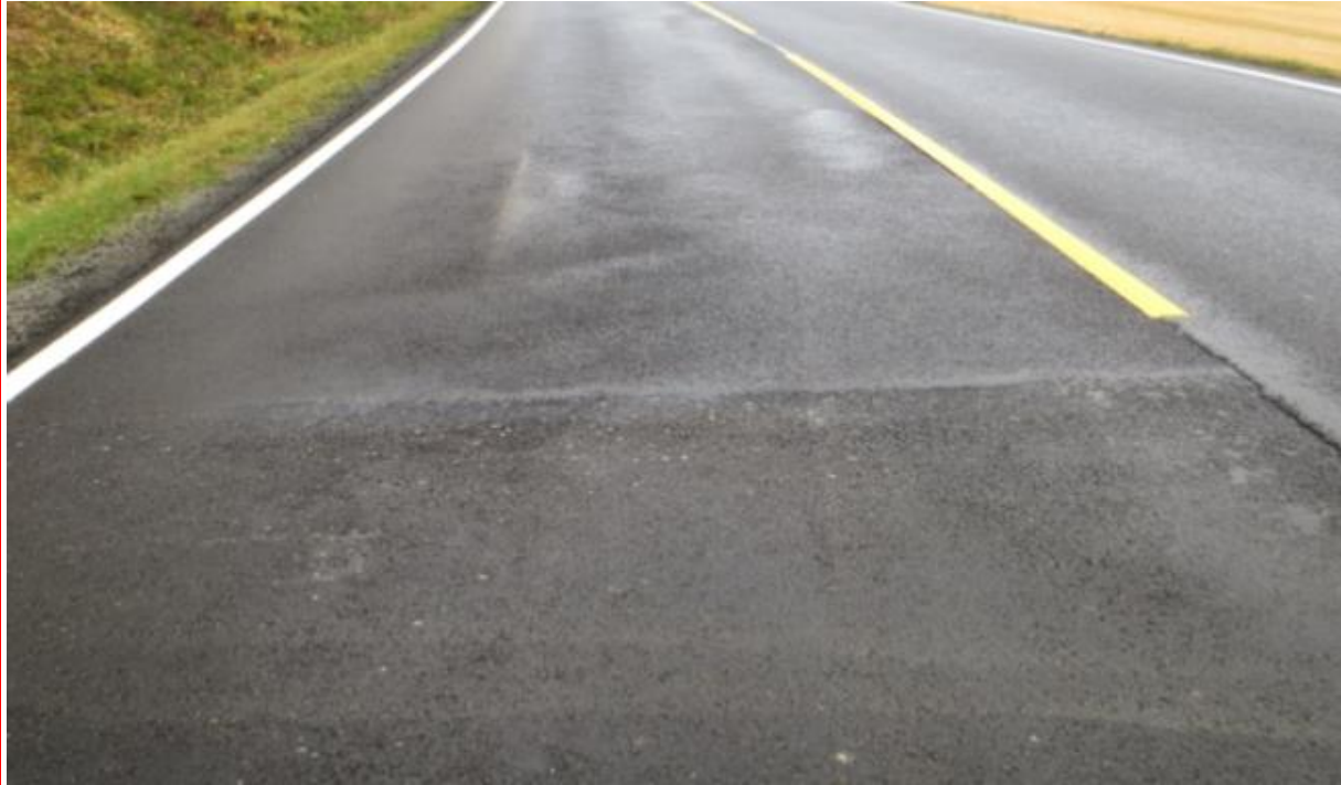
Feil: Inhomogent dekke ved tverrskjøt (foto: Jan Sundstrøm)
