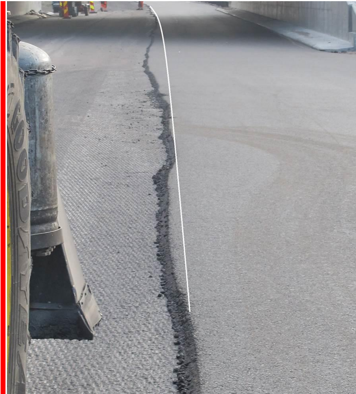
Feil: Kant mot midtskjøt skal være jevn (foto: Frode Malmstrøm)
