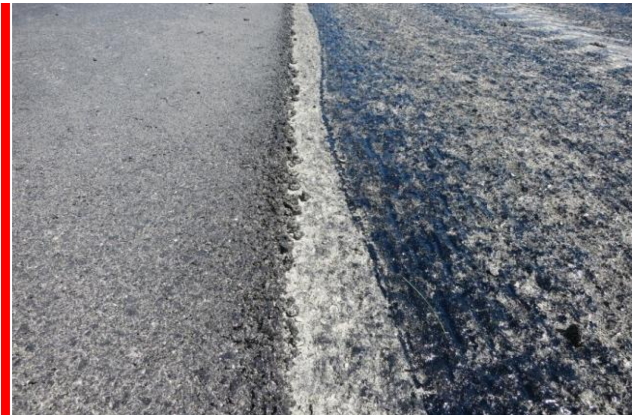
Feil: Det er ikke klebet under skjøt. Dette vil kunne føre til slipp mellom asfaltlagene (foto: Roar Telle)
