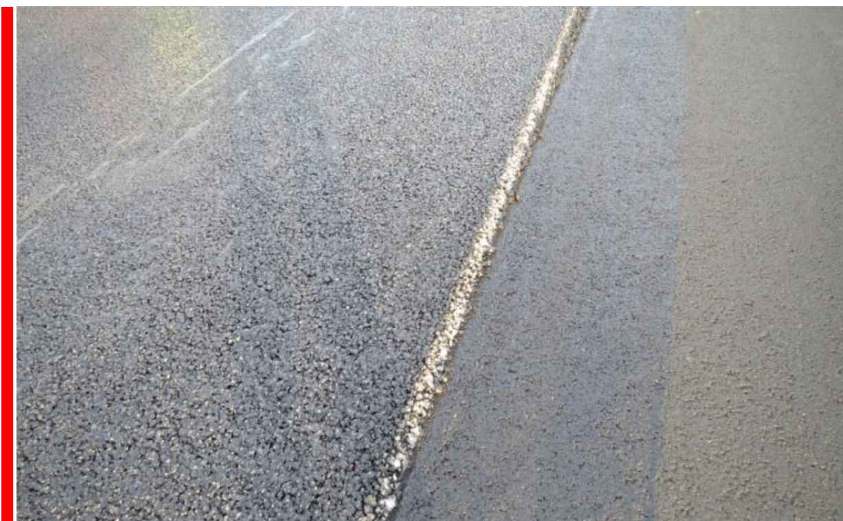
Feil: Bruk av klemhjul på avkjølt asfaltmasse (foto: Bjørn Hoven)
