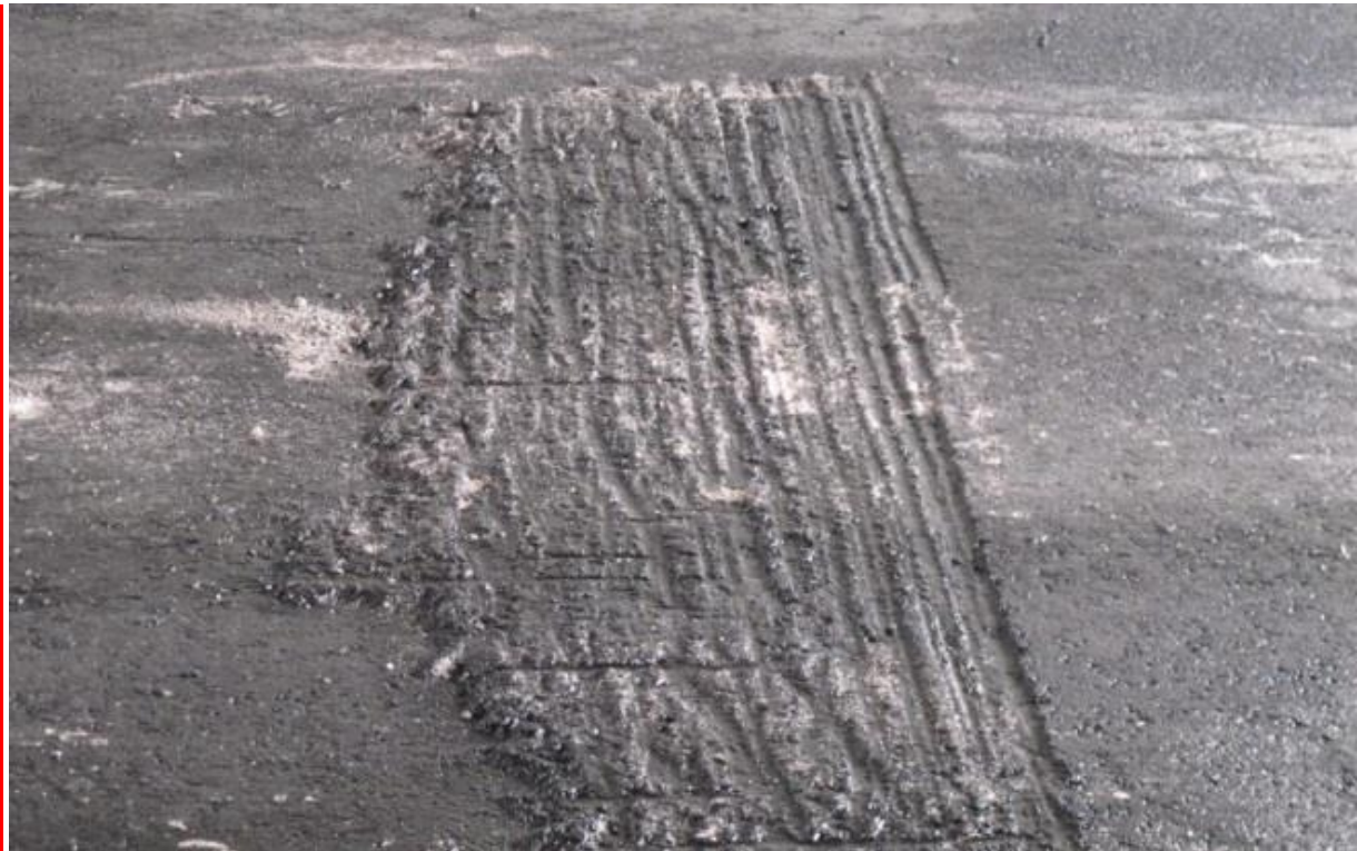
Feil: Dårlig utført fresing for buttskjøt (foto: Frode Malmstrøm)
