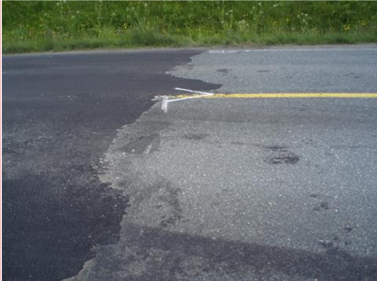
Feil: Dårlig utført tverrskjøt (foto: Jan Sundstrøm)
