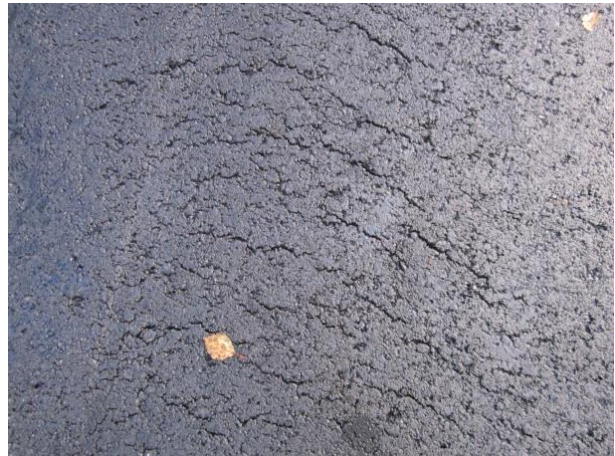
Feil : Sprekker etter valsing kan skyldes feil sammensetning av asfalmørtelen (foto: Atle Veiby)
