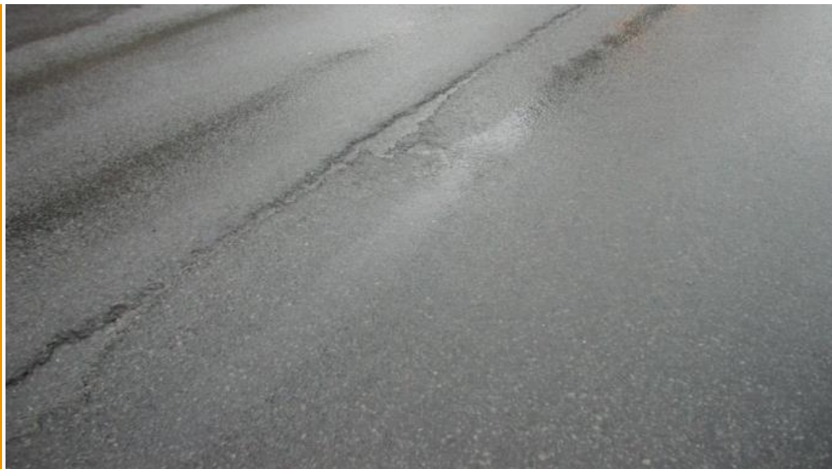
Konsekvens: Dekkeskader ved skjøt, resultat av mangelfull klebing og høyt hulrom i skjøt (foto: Roar Telle)
