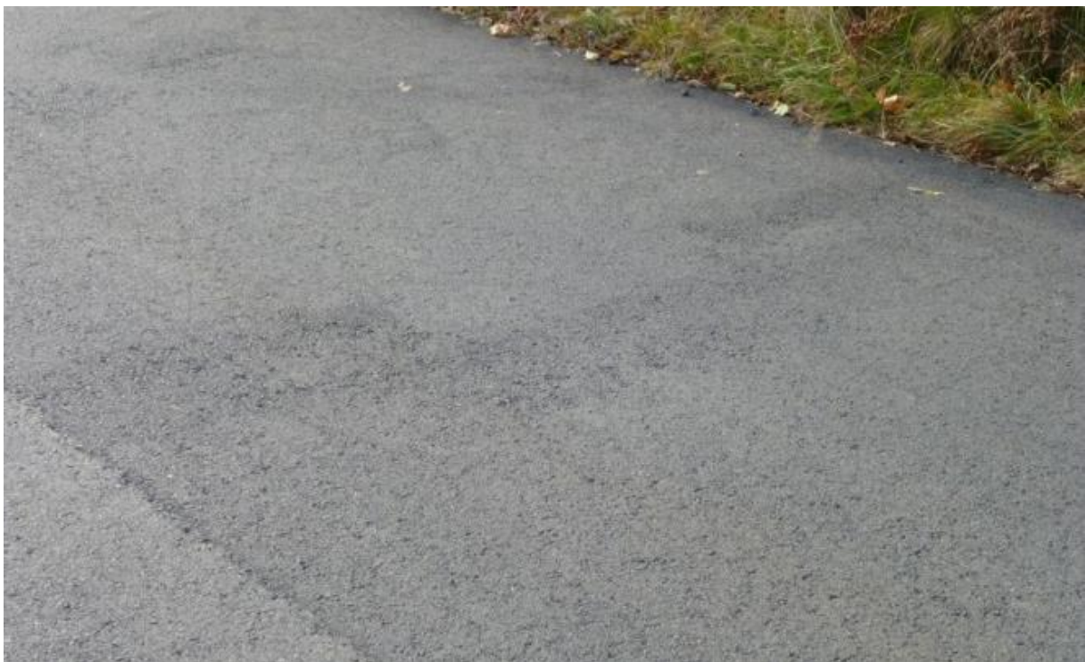
Konsekvens: Stopp i utlegging - avtrykk av screed i ferdig dekke (foto: Roar Telle)
