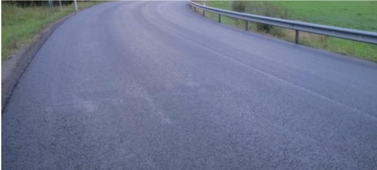
Konsekvens: Stopp i utlegging synlig på asfaltdekket (foto: Frode Malmstrøm)
