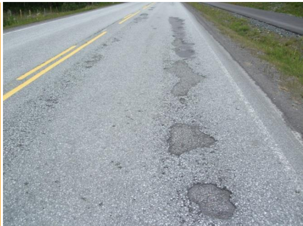
Konsekvens: Mangelfull klebing til underlag og høyt hulrom gir slipp av masse i hjulsporene (foto: Kjell Robertsen)
