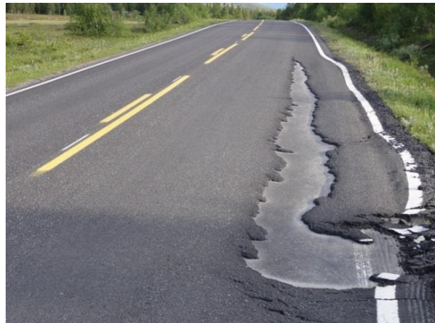
Konsekvens: Mangelfull klebing kan føre til glidning mellom asfaltlagene (foto: Erik Jølsgard)
