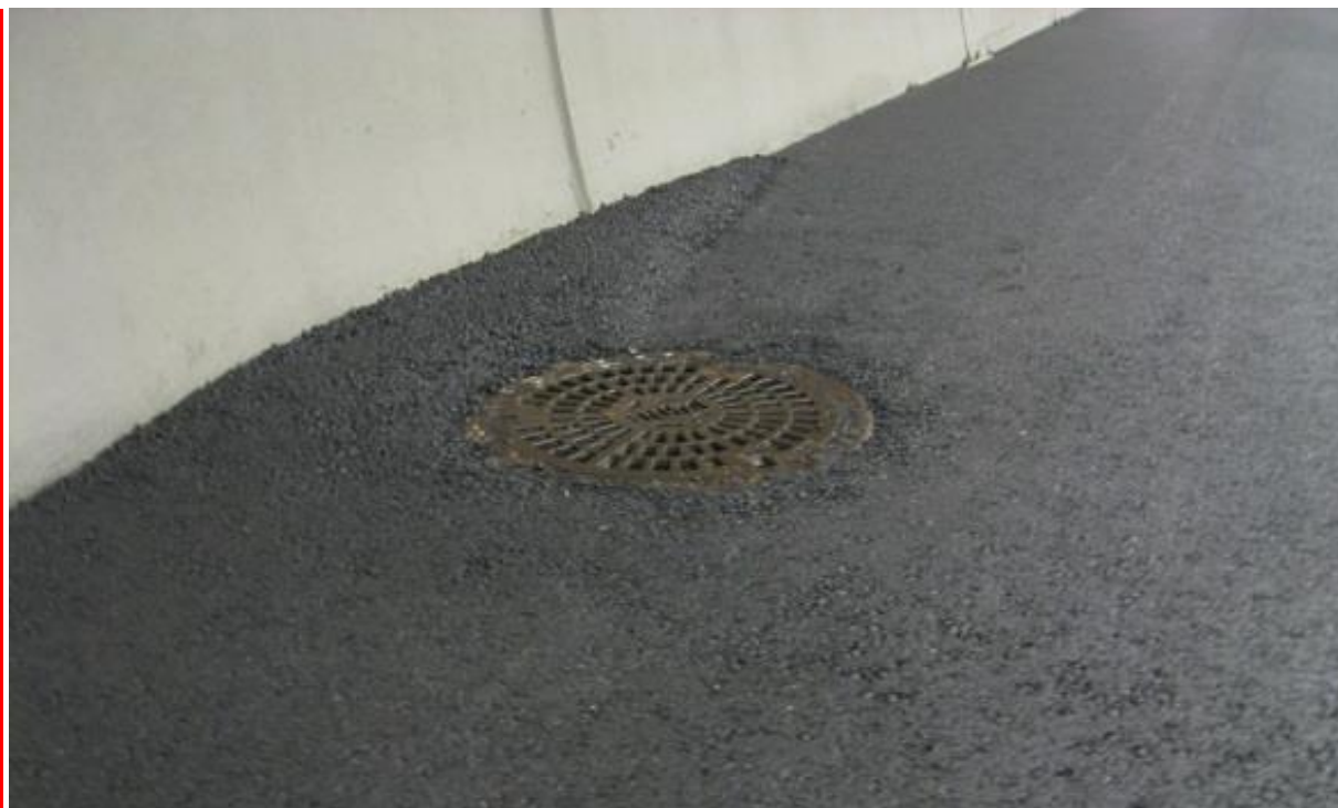
Galt: Dårlig utført arbeid rundt kum (foto: Bjørn Trygve Andersen)
