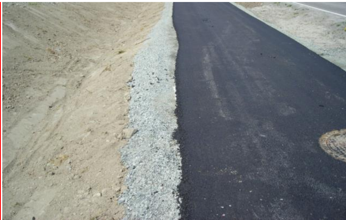
Feil: Ujevn asfaltkant (foto: Jan Sundstrøm)
