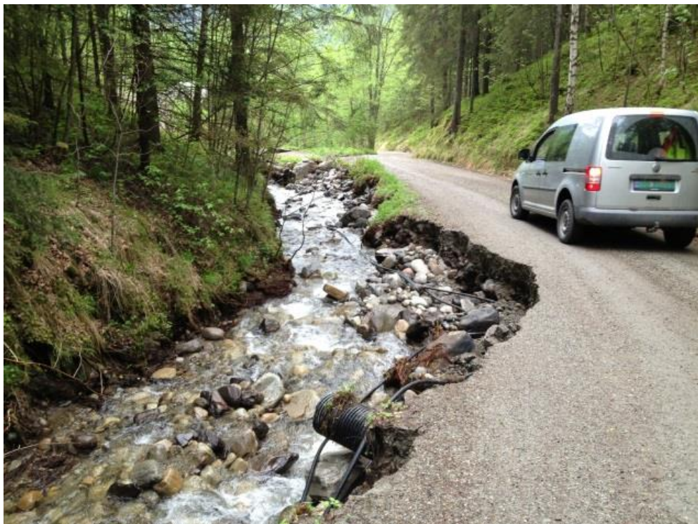
Figur 26: Ødelagt drengsrøft og tette stikkrenner på den nye Kvitfjellveien (Vest).
