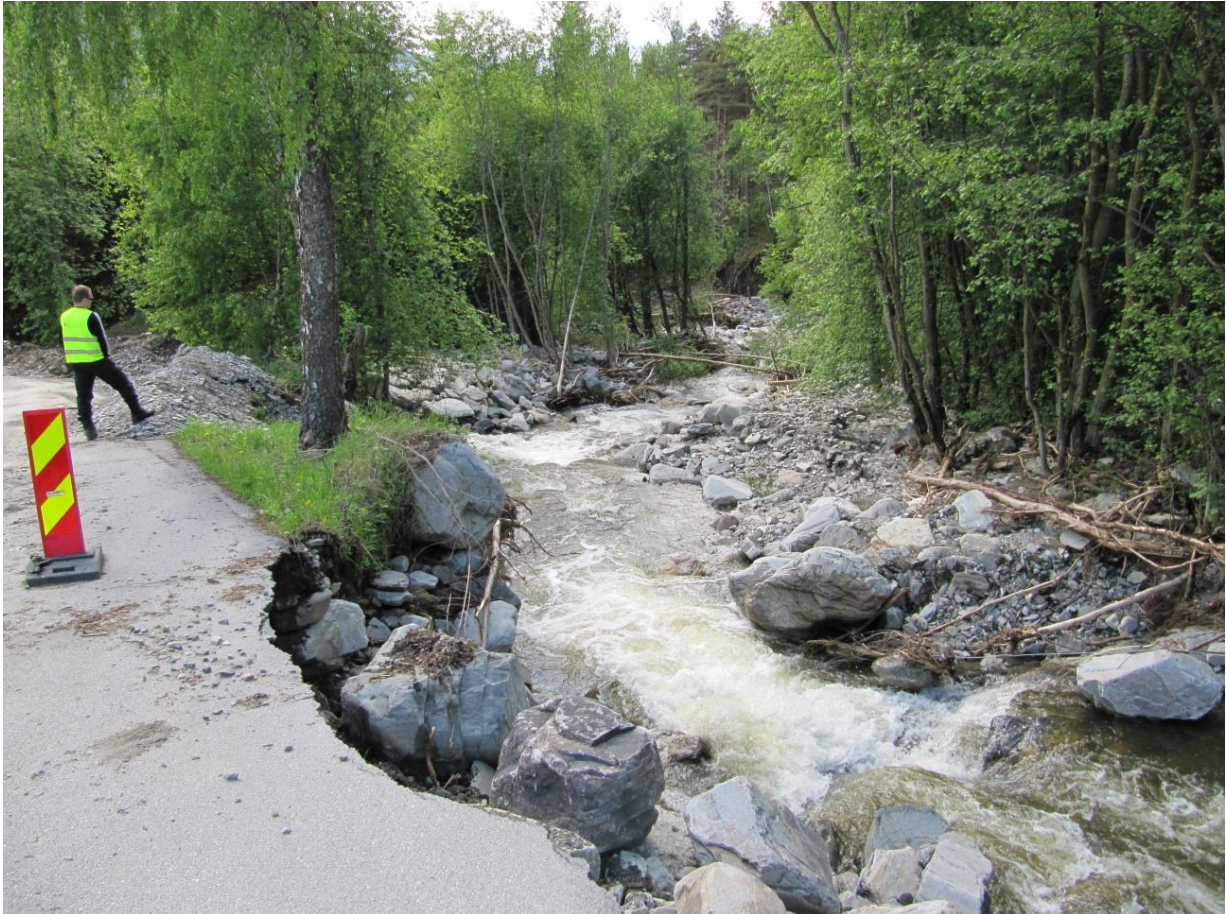
Figur 18: Erosjon i bekkeløpet nedstrøms dagens E6.
