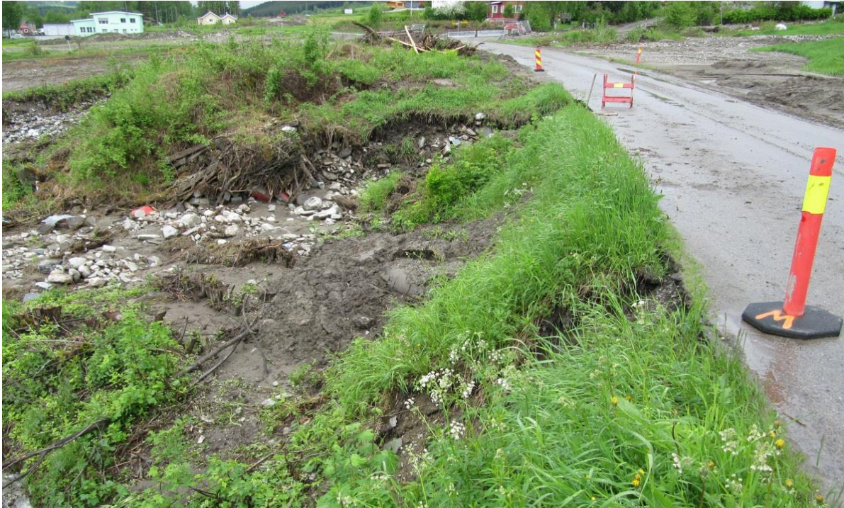
Figur 15: Brandrudåa lengst bort og sidebekken nærmest har gått i nye løp over FV403.
