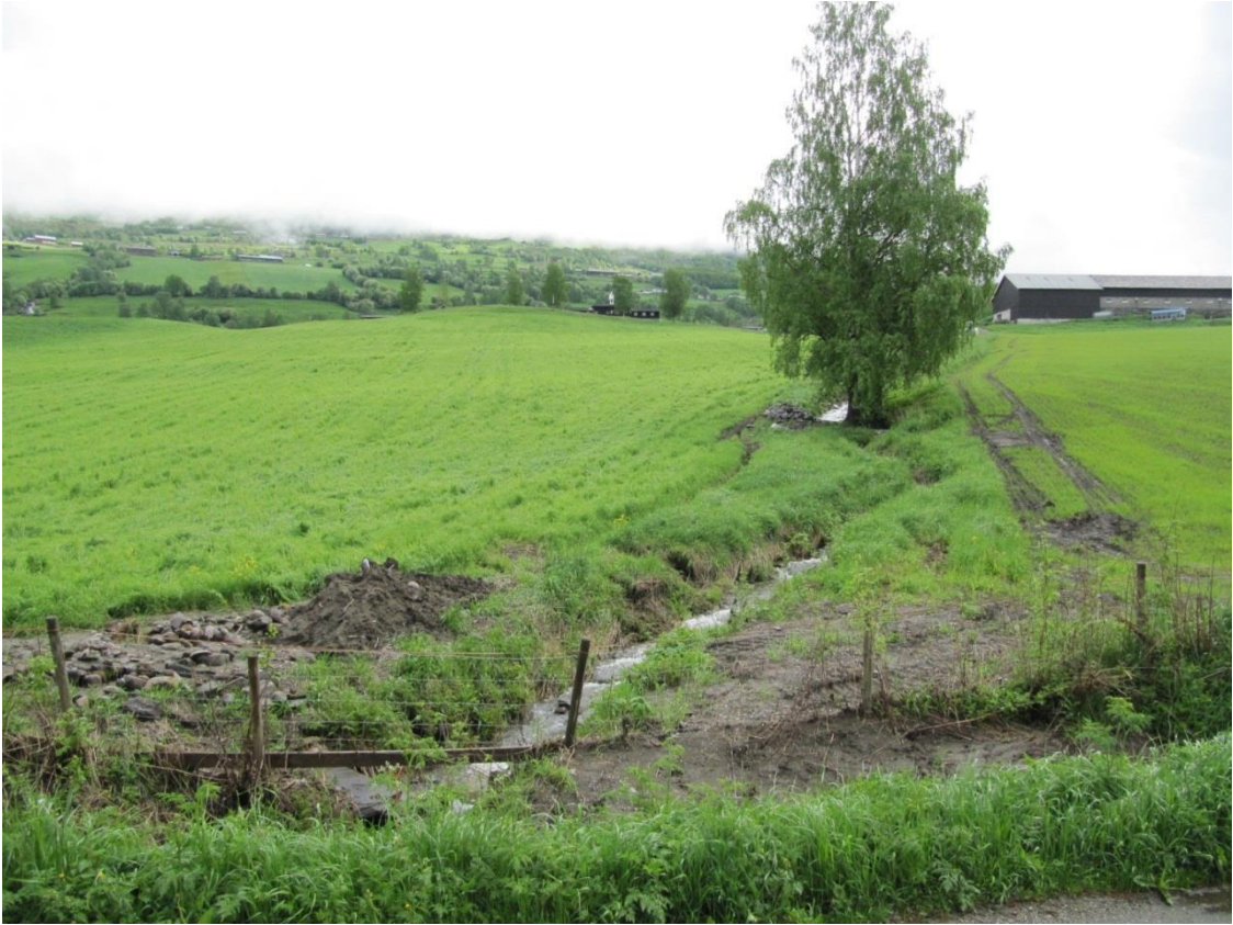
Figur 10: Mindre tegn til erosjon oppstrøms FV403.
