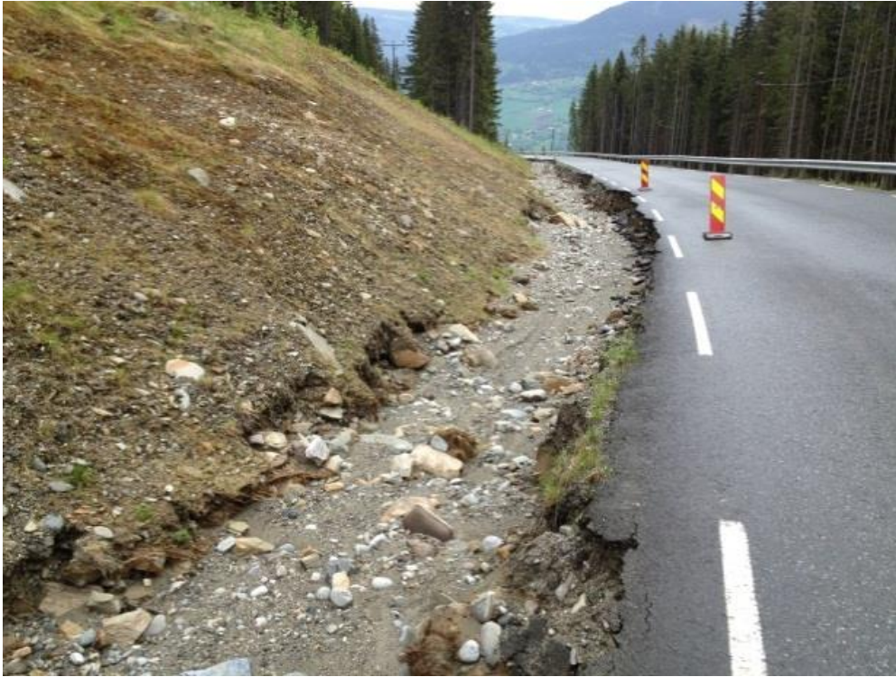
Figur 25: Ødelagt drengsrøft og tette stikkrenner på den nye Kvitfjellveien (Vest).
