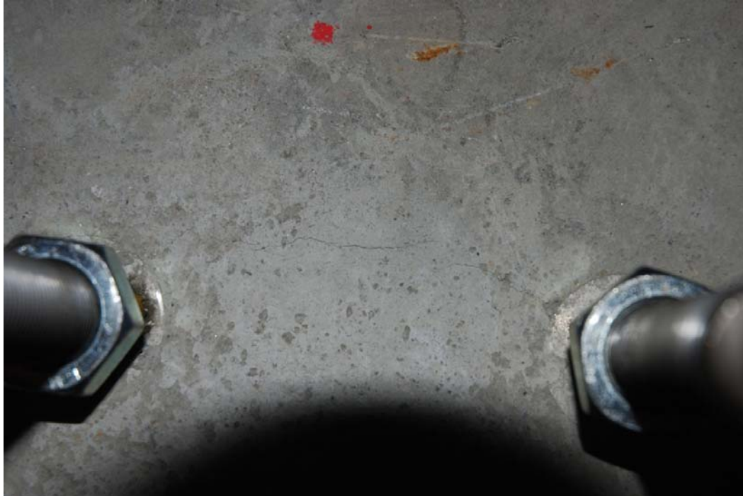
Figur 4.3: Riss ved boltegruppe. Boltegruppe med 150 mm forankringslengde.
