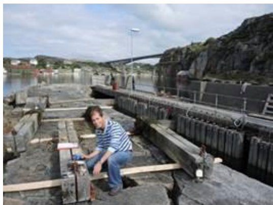
Figur 7 Måling av potensial på armering i opprisset bjelke. Foto: Statens vegvesen
