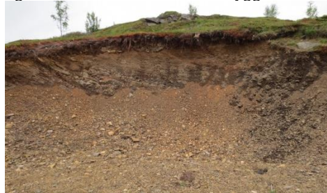
Eksempel på dårlig dypforvitret bergmasse på Bjarkøy.
