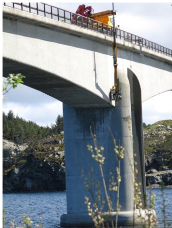
Uttak av kjerneprøver fra brukassa på Bakkasundbrua i Austevoll. (Foto: B. Pedersen)
