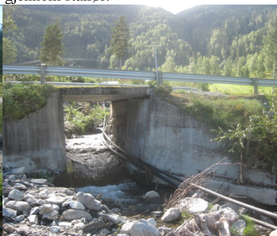
Ulberg bru. Landkar og vinge nedstrøms har undergraving og setninger
