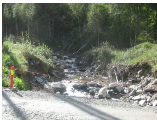
Flommen gravde ut elveløpet oppstrøms side av brua
