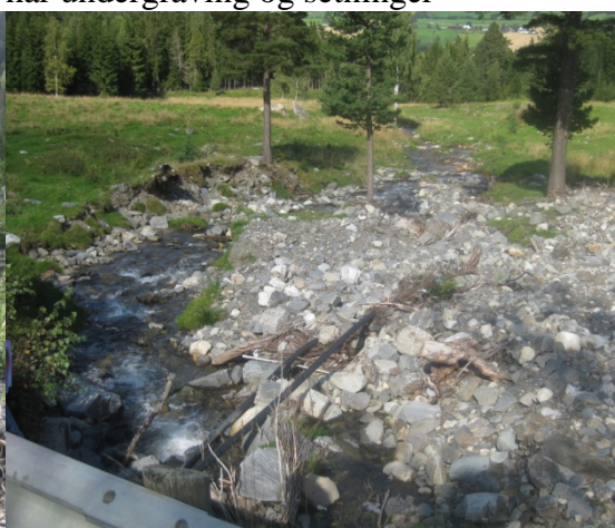
Avsetning av løsmasser nedstrøms side
