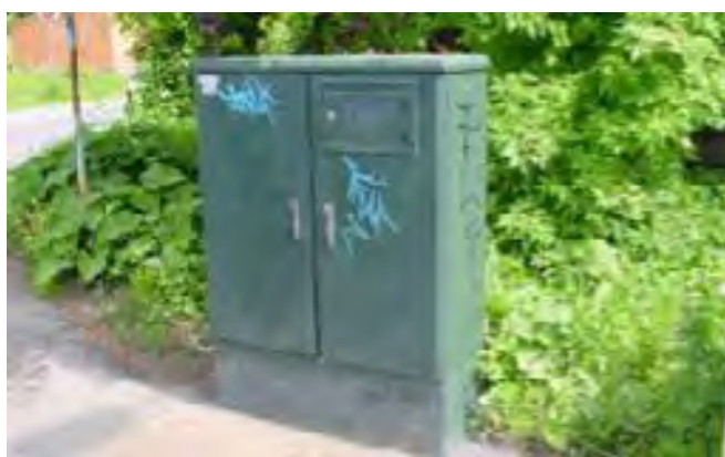
Foto: Fra Håndbok 142 Trafikksignalanlegg. Planlegging, drift og vedlikehold.
