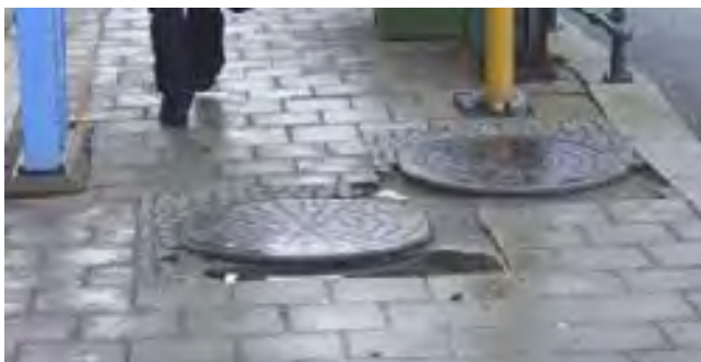
Foto: Fra Håndbok 048 Trafikksignalanlegg
