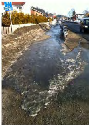
Figur 2-45 Tining og frysing på gangveg (Begge foto: Arild Nærum)
