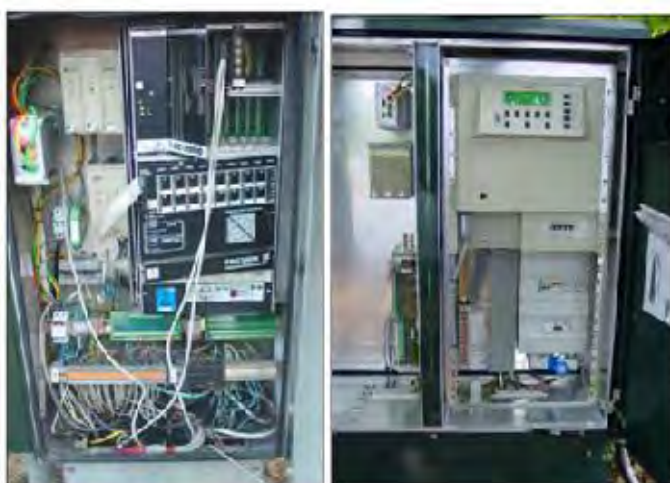
Foto: Fra Håndbok 142 Trafikksignalanlegg. Planlegging, drift og vedlikehold.
