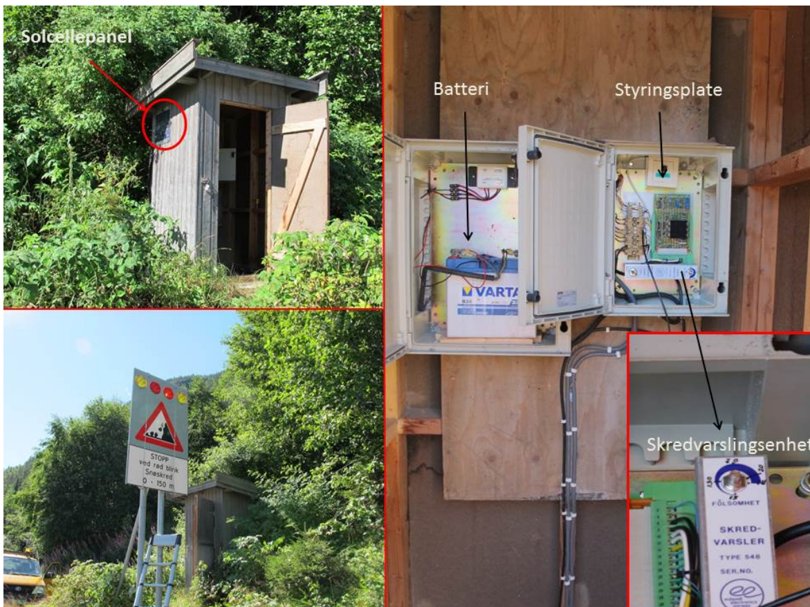
Figur 3. Bildene viser styringsskapet med styreplate, skredvarslingsenheten og batteri(Foto: Heidi Bjordal)
